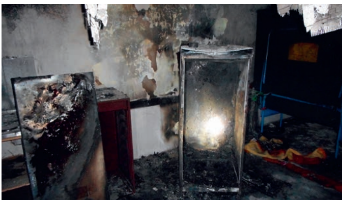
Zaporniška celica po požaru
