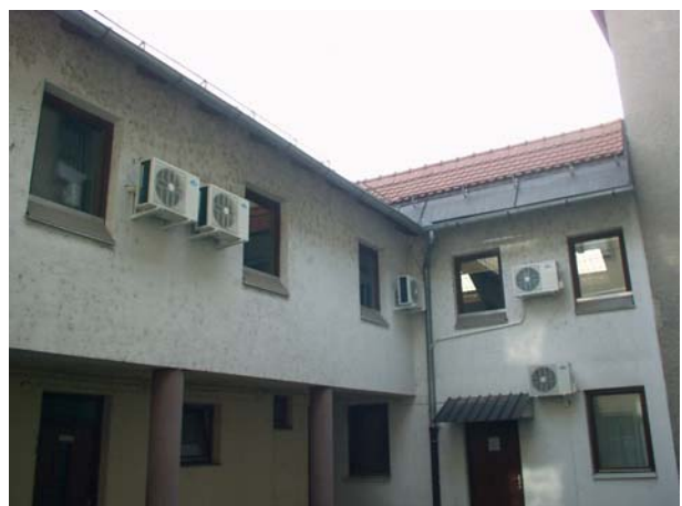
Nove klimatske naprave v upravnem delu zavoda Celje
