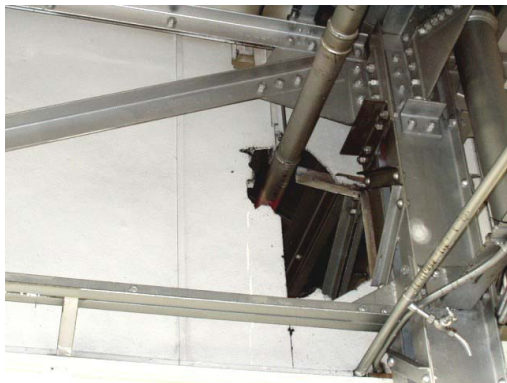
Slika 4.3 Predelna stena z azbestno izolacijo. Ta primer ponazarja praktične težave pri postavitvi primerne zaprtega prostora in prikazuje površine, kjer se med postopkom odstranjevanja lahko nabira azbestni prah.
