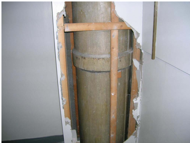
Slika 4.2 Delno odstranjena zapora azbestne izolacijske plošče, za katero se vidi cementna cev.
