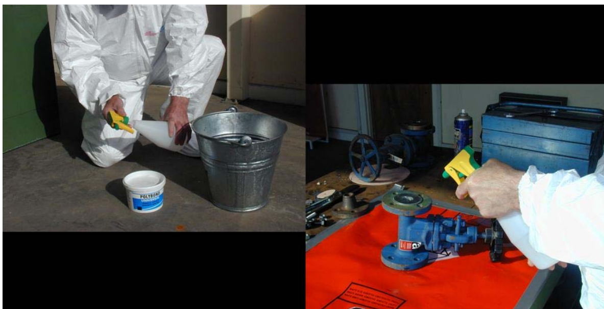
Slika 11.4 Vlaženje azbestnega tesnila na ventilu
