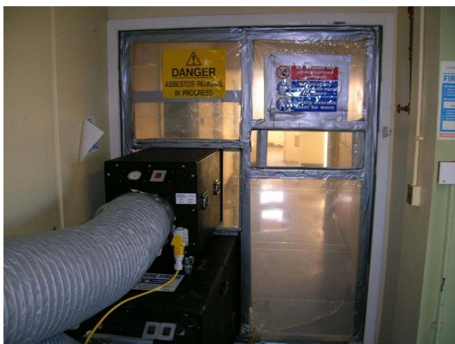
Slika 12.2 Podtlačne enote in odzračevalne cevi, okna in opozorilni znaki.
