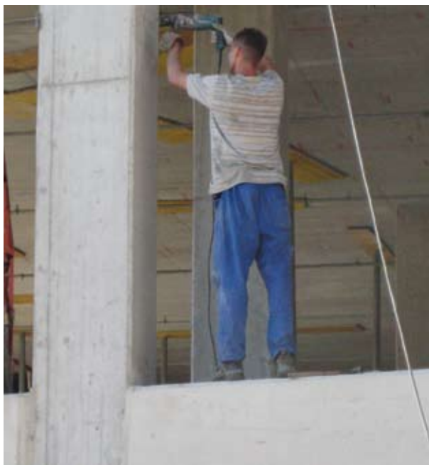
Slika 3: Primer dela na nezavarovani višini. V konkretnem primeru bi lahko delavec padel več kot 5 m v globino.
