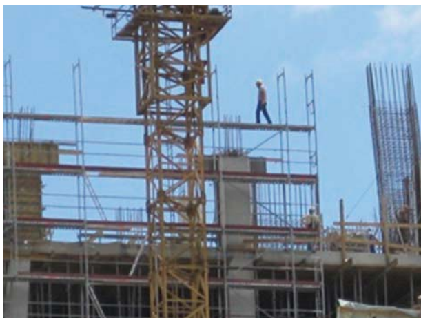
Slika 8: Primer nevarovanega gibanja delavca na višini 60 m, ki se je srečno končal
