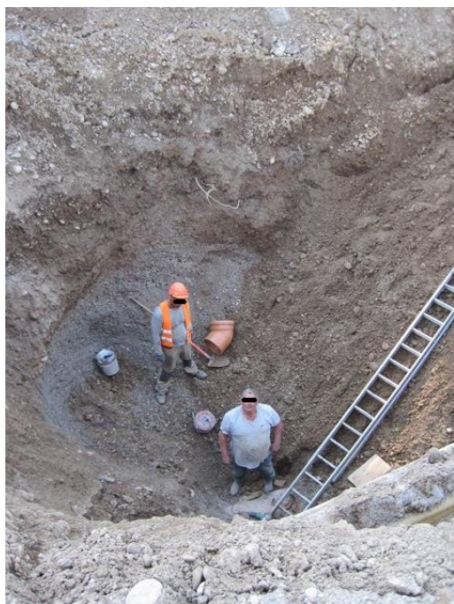
Slika 11: Delavci v nezavarovanem izkopu
