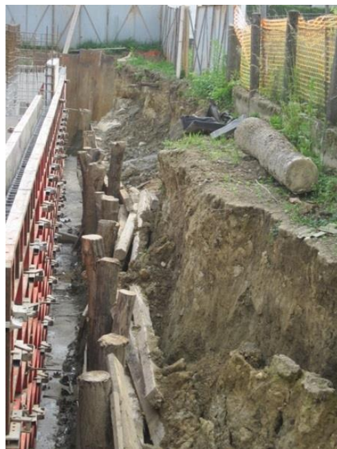
Slika 12: Porušitev brežine ob zavarovanem izkopu
