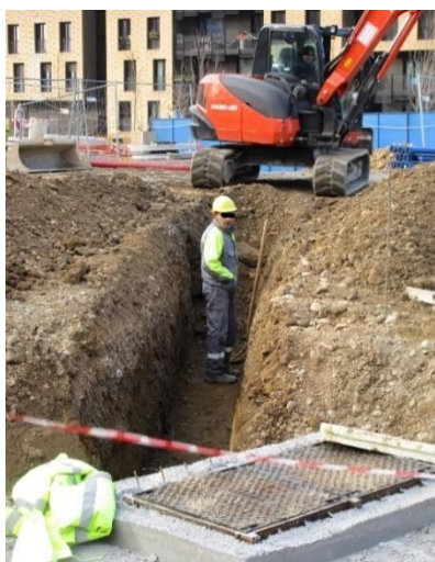
Slika 10: Neustrezno urejeno delovno mesto – improviziranje na gradbišču
