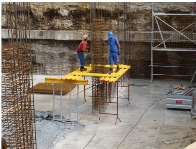
Slika 11: Neustrezno urejeno delovno mesto – improviziranje na gradbišču
