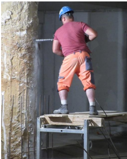
Slika 9: Neustrezno urejeno delovno mesto – improviziranje na gradbišču
