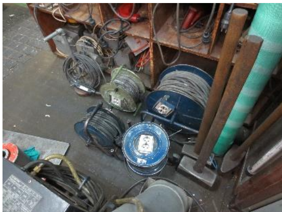
Slika 5: Neustrezni podaljševalni kabli
