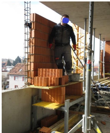
Slika 10: Neustrezno urejeno delovno mesto – improviziranje na gradbišču
