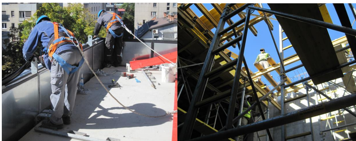
Slika 7: Primerno in povsem neprimerno zavarovano delo na višini
