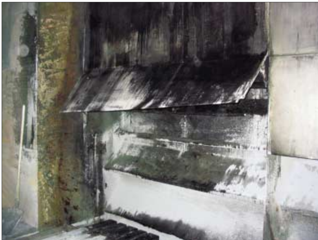
Slika 14: Posledice eksplozije. Značilen primer slabo organiziranega dela. Z ene strani so delavci opravljali čiščenje z razredčilom, z druge strani pa so varilci opravljali svoje delo. Drugi za druge pa sploh niso vedeli.
