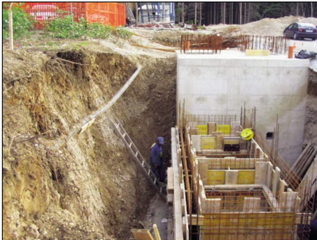
Slika 29. Brez zavarovanja proti zasipanju!
