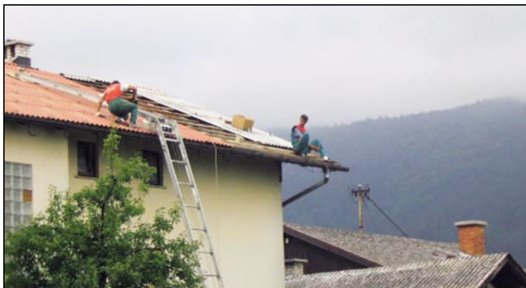
Slika 25. Brez osebne varovalne opreme, brez ograje...
