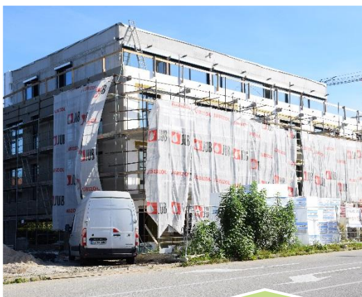
nedokončano stanovanje v stavbi z več stanovanji
