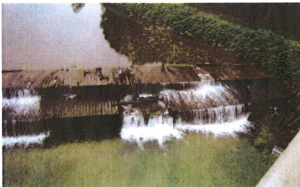
Fotografija 2 – pogled iz dolvodnega mostu na del dotrajanega praga ob levem bregu
