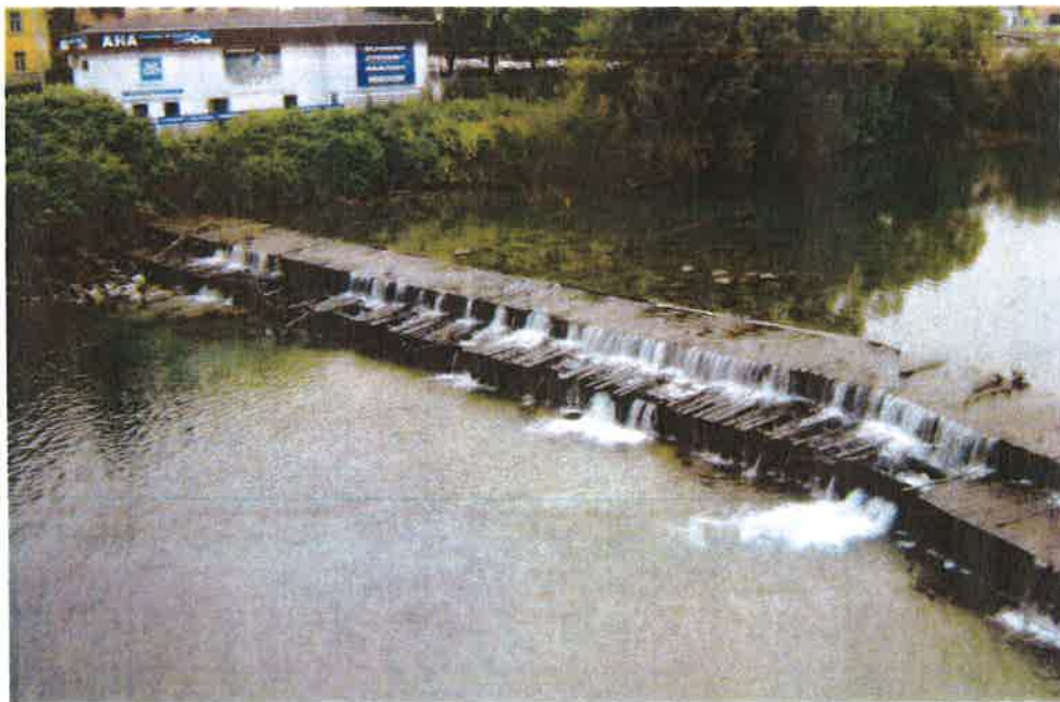
Fotografija 1 – pogled na desni del dotrajanega praga iz dolvodnega mostu
