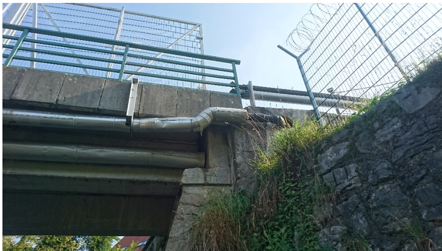
Slika 5. Vodovodna cev je speljana skozi opornik (spodnja cev), kanalizacijska cev je pritrjena ob robnem vencu, gre mimo opornika in skozi zid v jašek.
