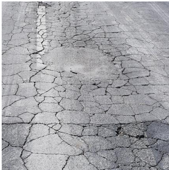
Slika 6: Poškodbe v asfaltni plasti – mrežaste razpoke
