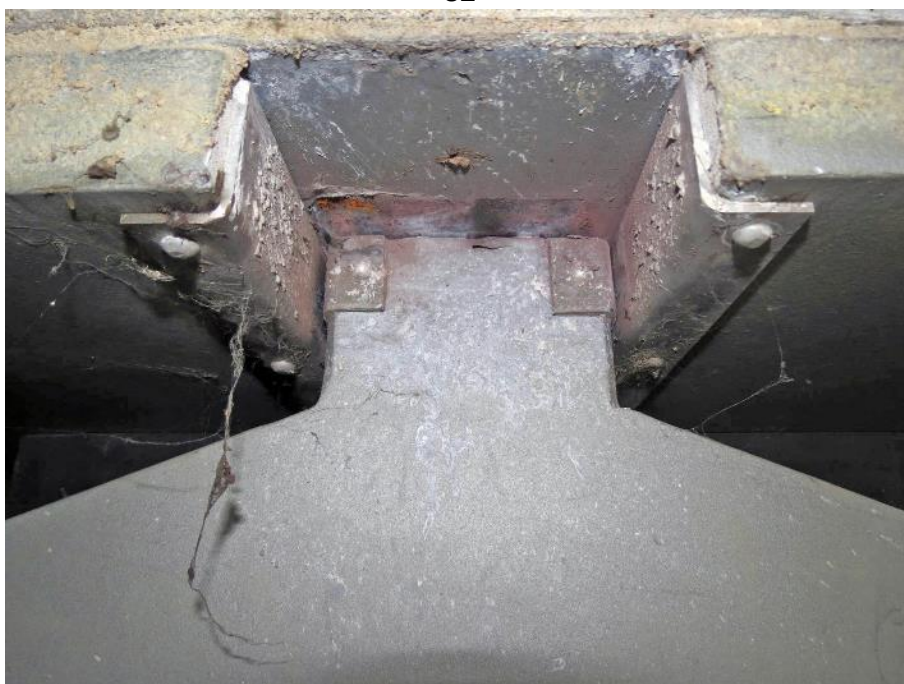
Slika 8: Nepravilna izvedba in vgradnja deformabilnega ležišča s pridrževalno konstrukcijo za preprečevanje pomikov v prečni smeri. Zgornja površina trna v kontaktu z ležiščno ploščo. Drsna površina utora ležiščne plošče umazana.
