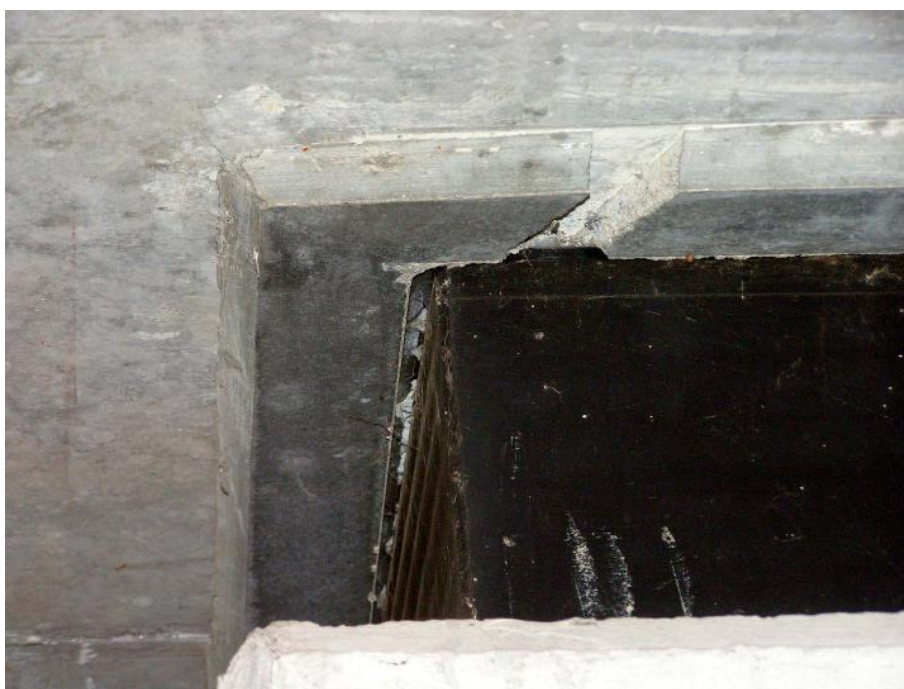
Slika 46: Odlom zgornjega venca zaradi zdrsavanja ležišča. Nepravilna izvedba kontaktne površine podlivne malte in prekladne konstrukcije in neustrezna sprijemnost obeh površin.
