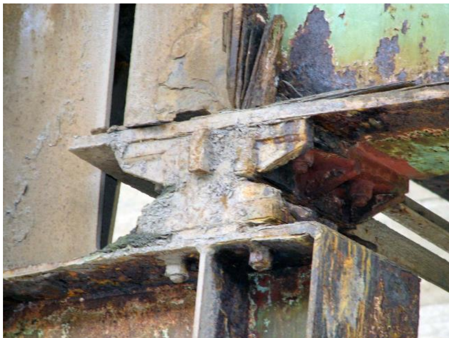
Slika 143: Linijsko nagibno ležišče – močna korozija in siganje.
