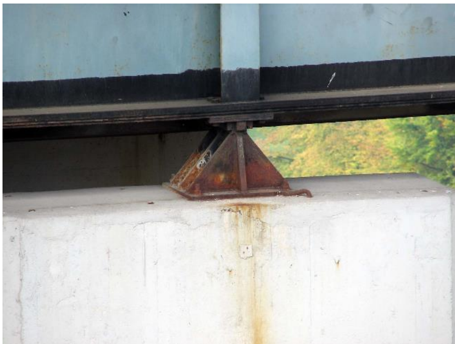
Slika 142: Linijsko nagibno ležišče – korozija.
