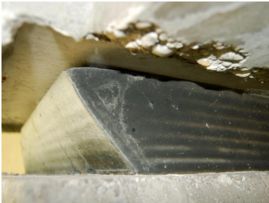
Slika 15: Neenakomerno naleganje na ležišče. Prevelika deformacija ležišča, ki je deformirano tudi okoli vertikalne osi (torzijski zasuk ležišča v horizontalni ravnini).
