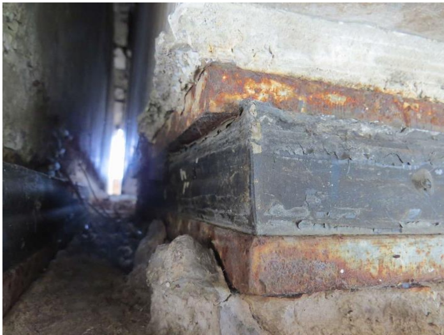
Slika 35: Neustrezne dimenzije ležiščnih plošč – plošče brez ustreznih previsov. Korozija ležiščnih plošč. Nepravilno vgrajene ležiščne plošče. Poškodbe površine elastomerja zaradi staranja.
