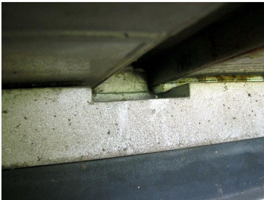
Slika 75: Iztiskanje teflona iz utora zgornje nosilne plošče deformabilnega drsnega ležišča.
