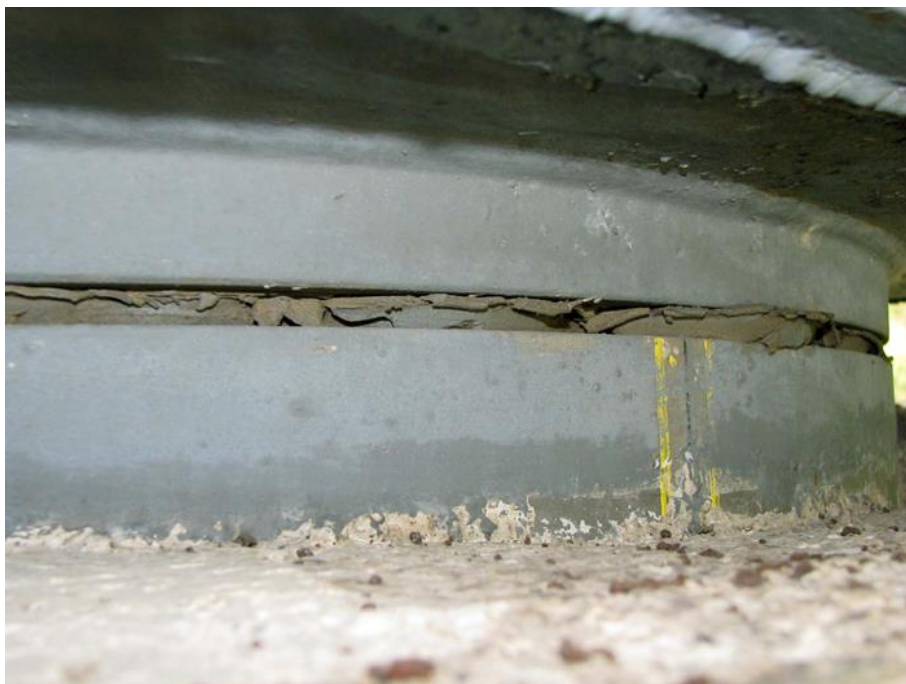
Slika 113: Propadanje tesnilnega traku nagibne reže.
