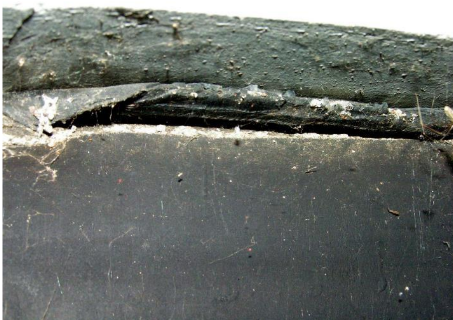
Slika 39: Struženje in iztiskanje elastomerja zgornjega krovnega sloja zaradi zdrsavanja po kontaktu elastomernega bloka z zgornjo ležiščno blazino.
