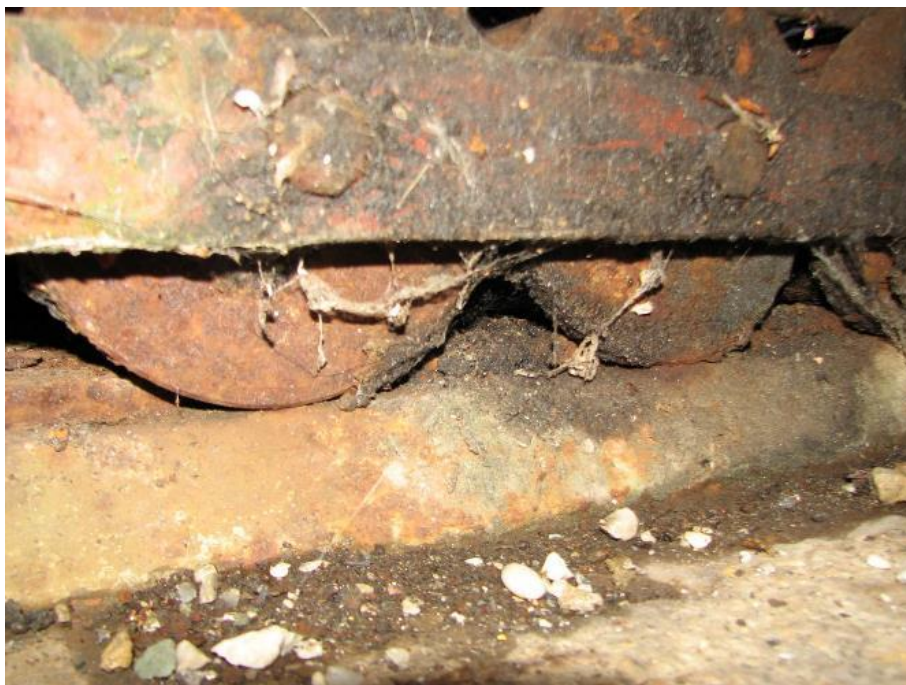
Slika 148: Več valjčno ležišče – nesnaga (ovira) na kotalni površini.
