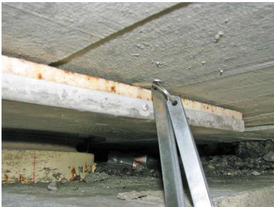
Slika 105: Neustrezen kontakt med drsno ploščo drsnega lončnega ležišča in prečnikom prekladne konstrukcije.
