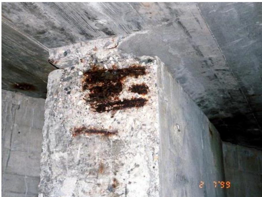
Slika 157: Lokalna delaminacija betona zaradi močne korozije armature nihajnega bloka betonskega členka.
