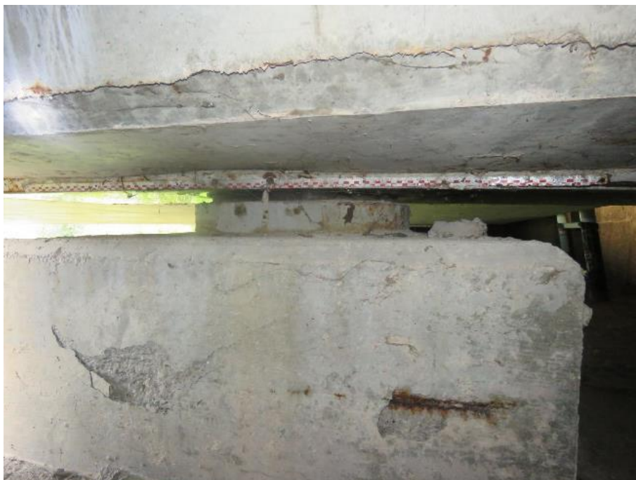
Slika 160: Delaminacija betona ležiščnega podstavka zaradi korozije armature.
