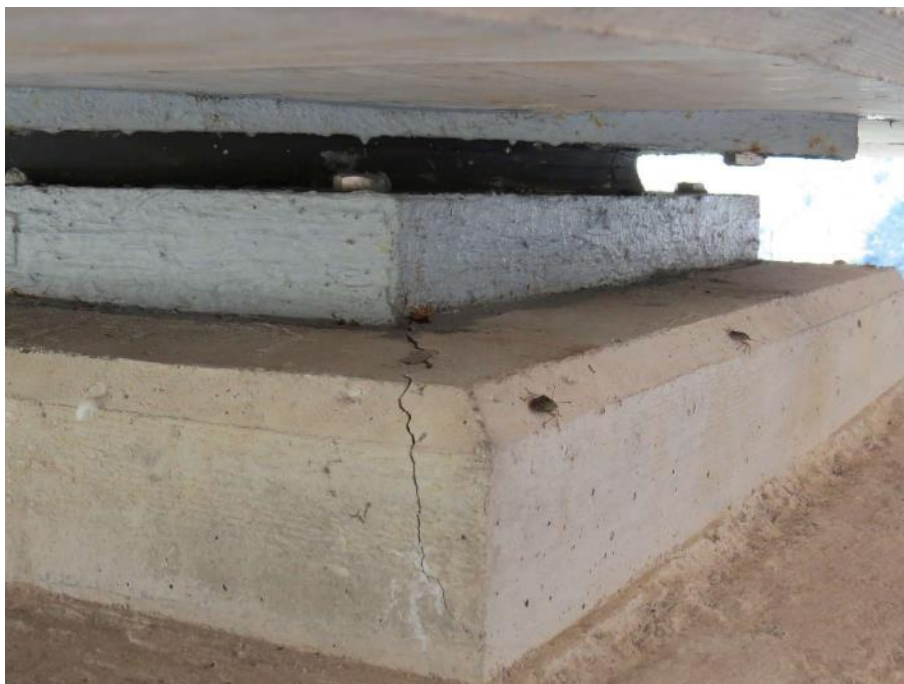
Slika 119: Strižna razpoka v betonskem ležiščnem podstavku.
