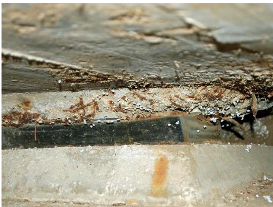
Slika 52: Neustrezno izdelana zgornja ležiščna blazina z ostanki žebeljev, žice in žaganja. Lokalno razpadanje ležiščne blazine.
