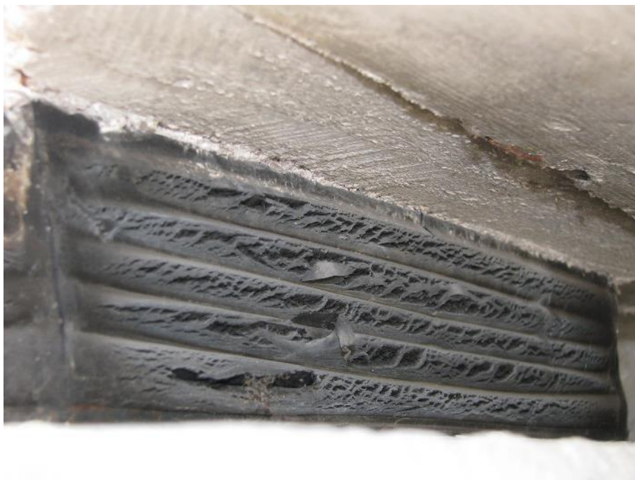
Slika 33: Mrežaste razpoke v elastomerju zaradi izpostavljenosti UV žarkom in ozonu.
