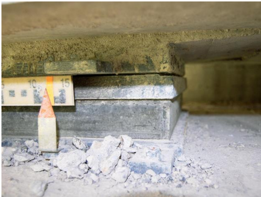
Slika 57: Prevelik pomik drsnega dela deformabilnega ležišča zaradi vgradnje ležišča v napačni smeri.
