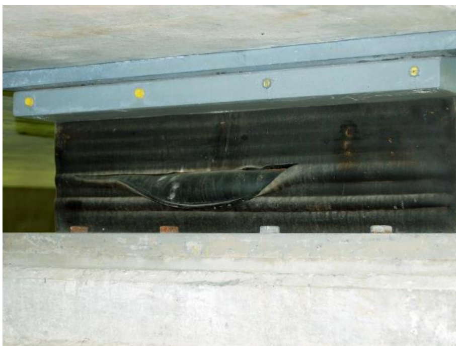
Slika 22: Razpoka na stiku med jekleno ploščo in elastomerjem zaradi neustreznega postopka vulkanizacije.
