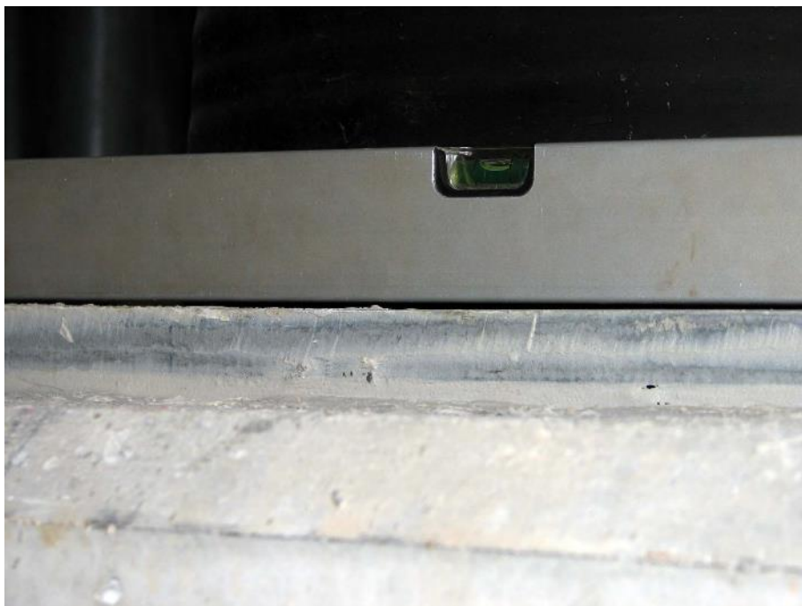
Slika 63: Deformirana spodnja ležiščna plošča elastomernega ležišča.
