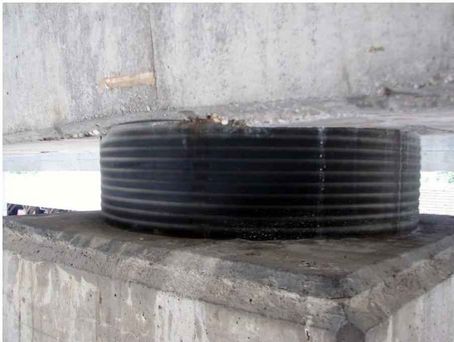
Slika 65: Neustrezno izbrano ležišče glede na dimenzije nosilca prekladne konstrukcije.
