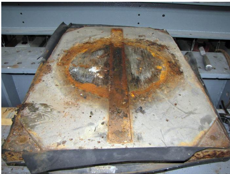
Slika 98: Korozijske poškodbe drsne plošče.
