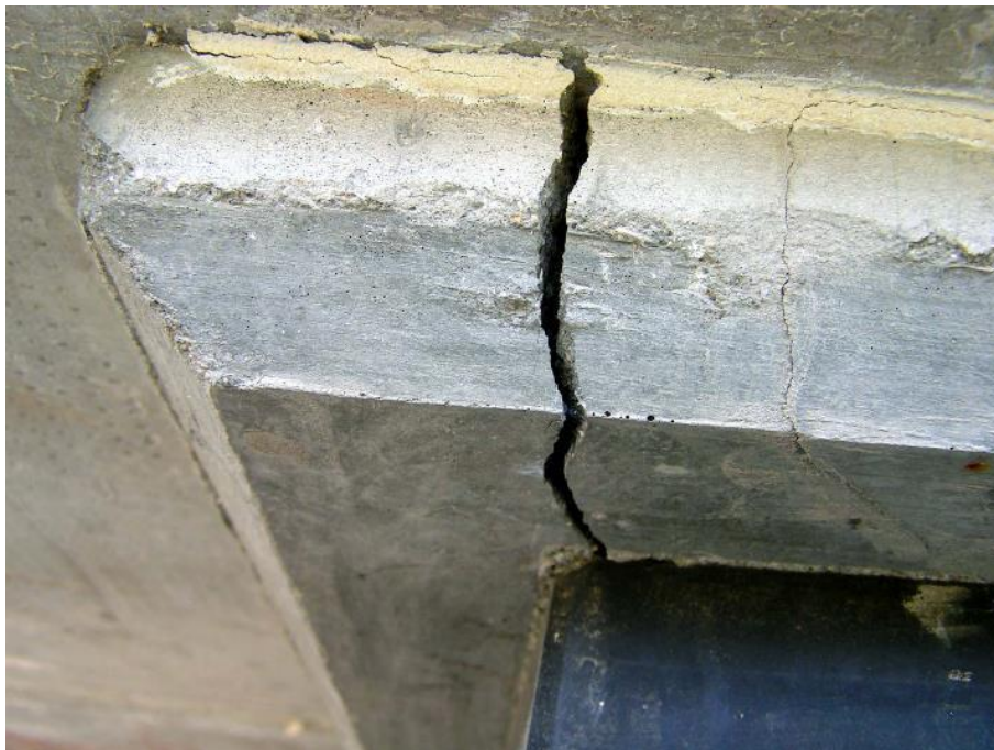
Slika 43: Razpoka v zgornjem vencu zaradi deformacije – zdrsavanja – ležišča.
