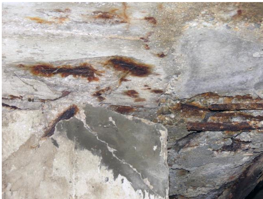
Slika 154: Korozija armature in lokalno krušenje vogala nihajnega bloka betonskega členka.
