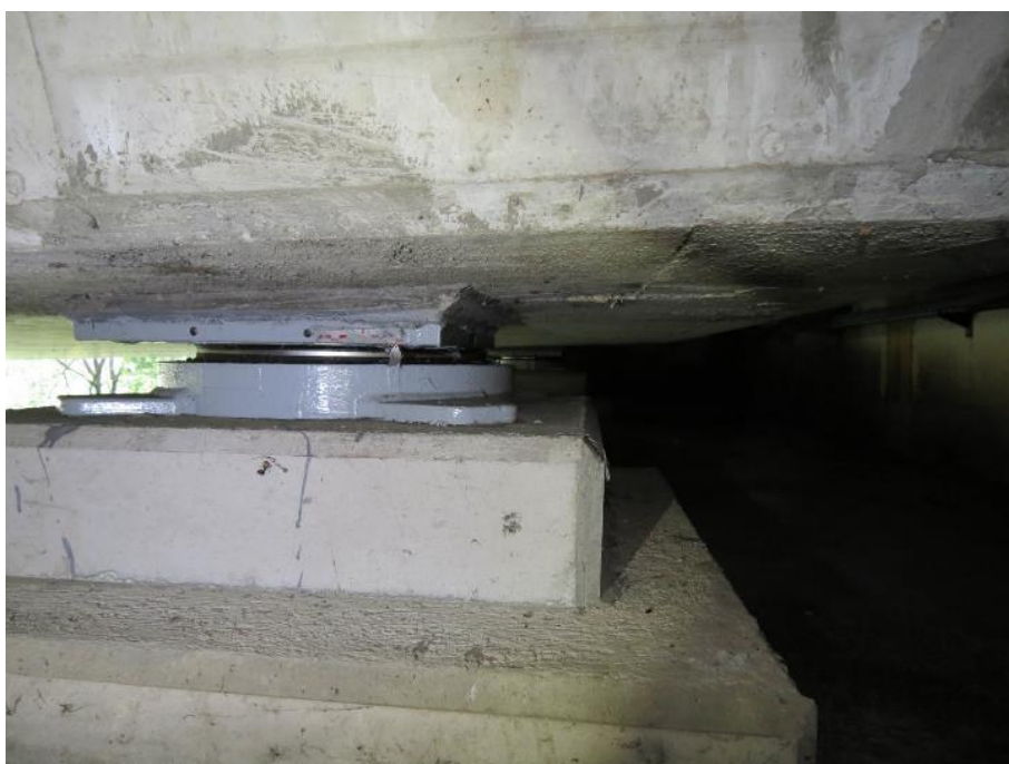
Slika 114: Prevelik pomik vodenega drsnega ležišča.
