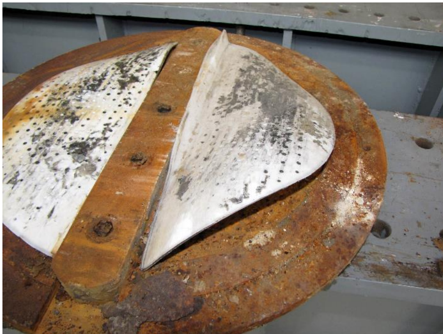
Slika 91: Nepravilno usmerjenost žepkov teflonskega diska na batnici lončnega ležišča. Deformirani teflonski disk zaradi iztiskanja v področje vzdolžnega utora.
