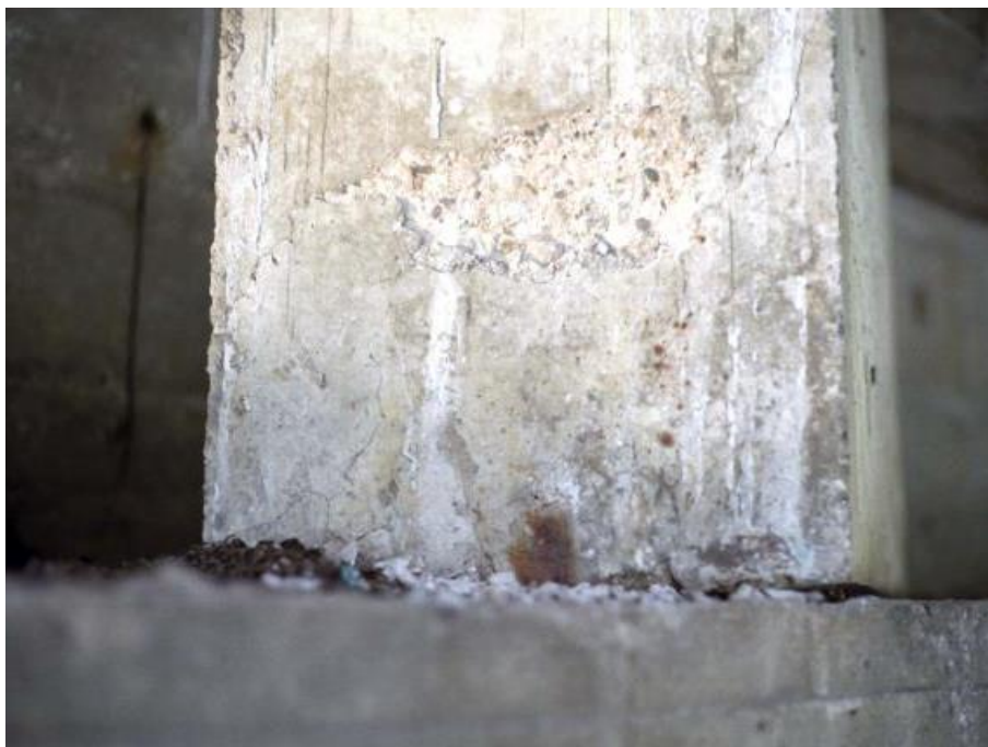
Slika 156: Lokalna delaminacija betona nihajnega bloka betonskega členka.
