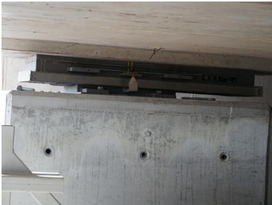
Slika 163: Velikost ležiščnega podstavka neustrezna z ozirom na velikost drsne plošče in premajhnega odmika drsne površine drsne plošče od zgornje površine ležiščnega podstavka.
