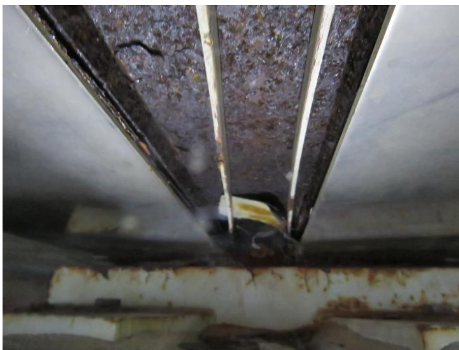
Slika 122: Korozija v utoru drsne plošče lončnega ležišča. Odstopanje drsnih parov (bočni drsni trak in bočna nerjavna pločevina) v utoru drsne plošče.
