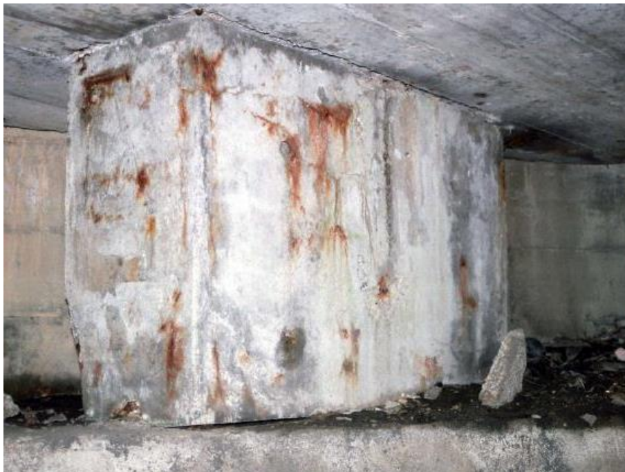
Slika 155: Zamakanje, korozija armature in lokalna delaminacija betona nihajnega bloka betonskega členka.
