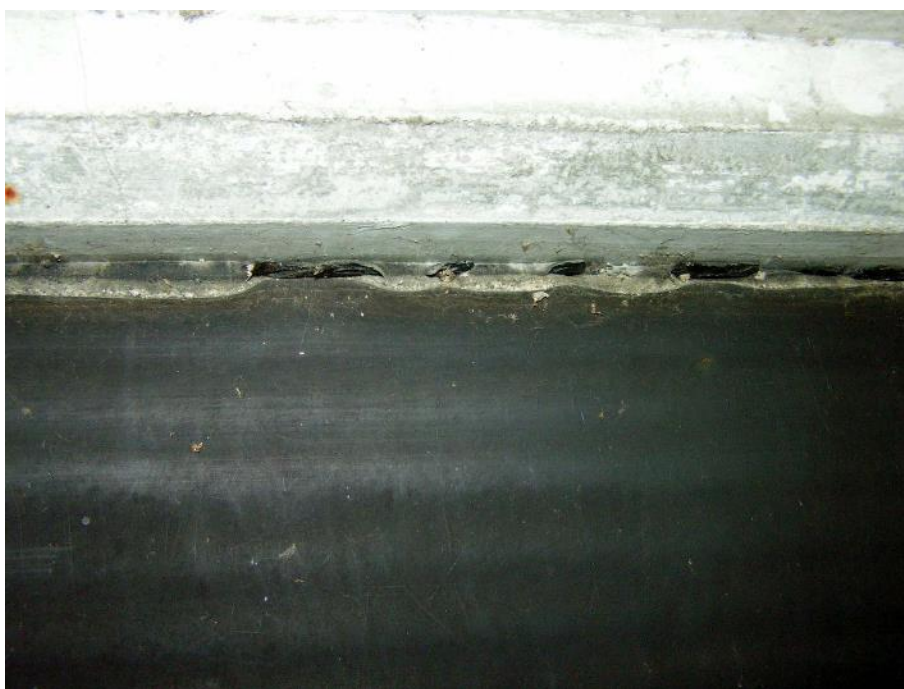
Slika 40: Struženje in iztiskanje elastomerja zgornjega krovnega sloja zaradi zdrsavanja po kontaktu elastomernega bloka z zgornjo ležiščno blazino.
