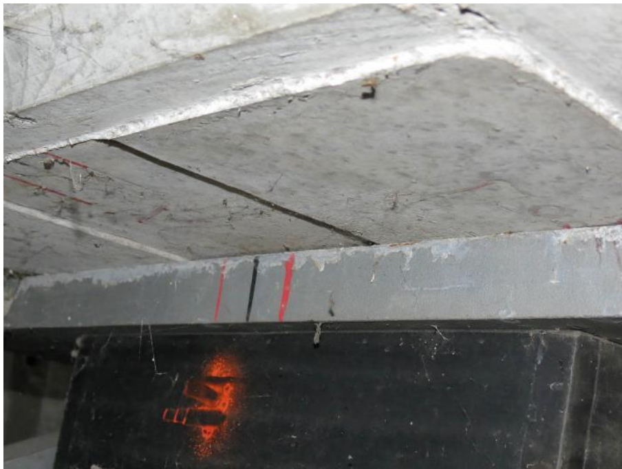
Slika 9: Nepodlita kontaktna površina med zgornjo ležiščno ploščo in betonsko ležiščno blazino.
