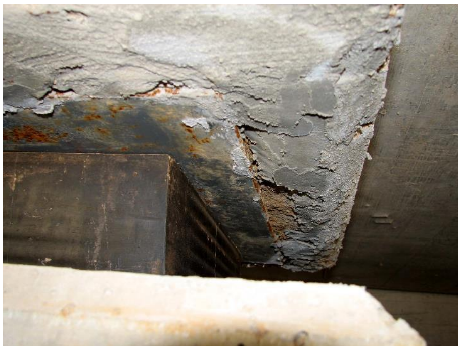
Slika 50: Nekvalitetno izvedena in sanirana zgornja ležiščna blazina zaradi žaganja na opažu.
