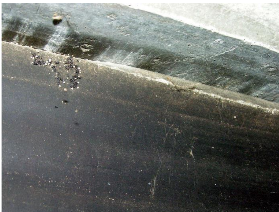
Slika 38: Ostružki elastomerja zgornjega krovne sloja zaradi zdrsavanja po kontaktu elastomernega bloka z zgornjo ležiščno blazino. V robu stika je tanek sloj epoksidne malte, ki zapira stik po obodu ležišča.
