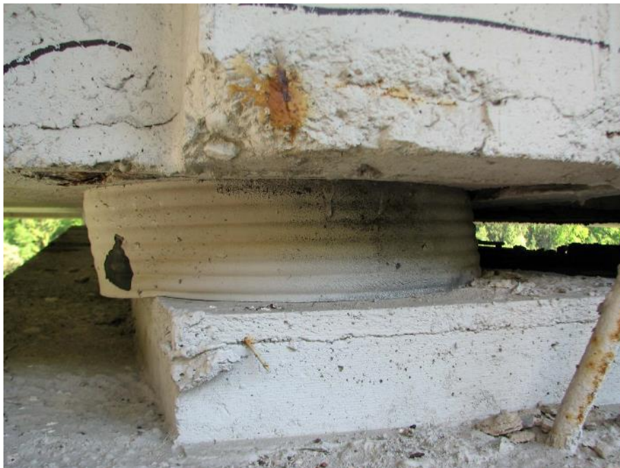
Slika 13: Zdrs elastomernega ležišča preko roba prečnega nosilca vmesne podpore. Ležišče vgrajeno preblizu roba ležiščne blazine.
