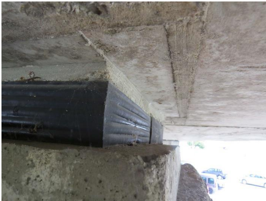
Slika 19: Deformirane jeklene plošče. Popuščanje spoja med vložki in elastomerjem.
