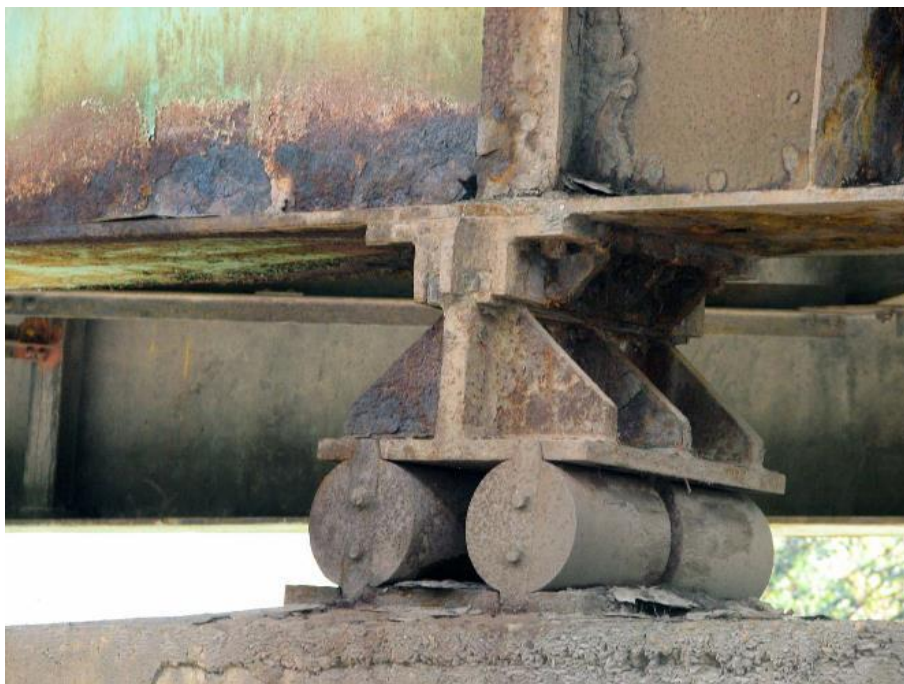
Slika 145: Dvojno valjčno ležišče – korozija zaradi zamakanja.
