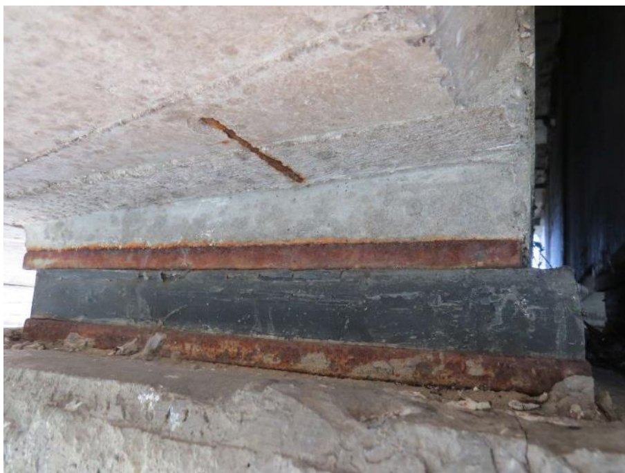
Slika 36: Neustrezne dimenzije ležiščnih plošč – plošče brez ustreznih previsov. Korozija ležiščnih plošč. Nepravilno vgrajeno ležišče in zdrs prekladne konstrukcije po stiku zgornje jeklene plošče z elastomernim blokom.
