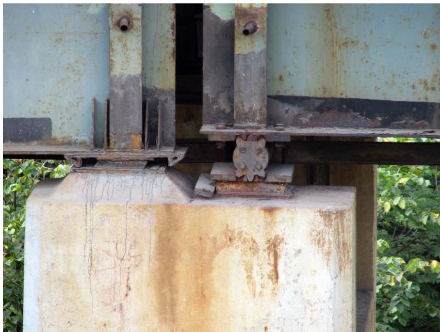
Slika 144: Enojno valjčno ležišče – korozija.
