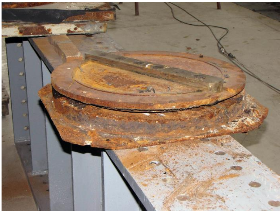
Slika 97: Korozija lončnega ležišča.
