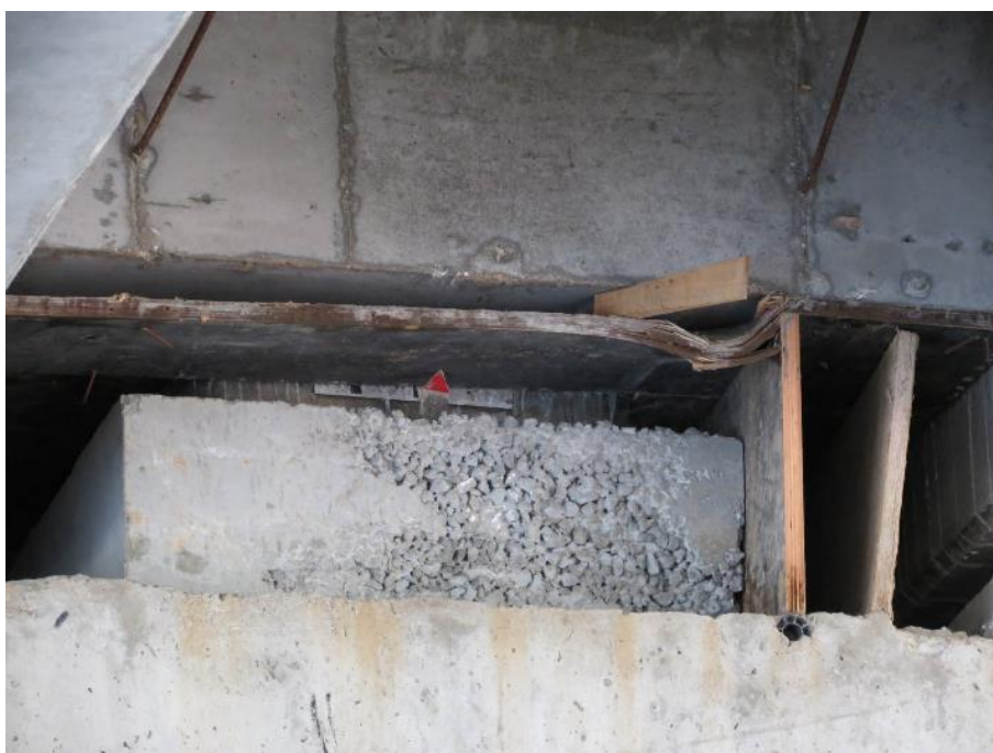
Slika 120: Porozen beton ležiščnega podstavka. Drсно ležišče vgrajeno prečno namesto v vzdolžni smeri.
