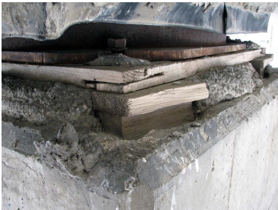
Slika 79: Neustrezno vgrajeno lončno ležišče.
