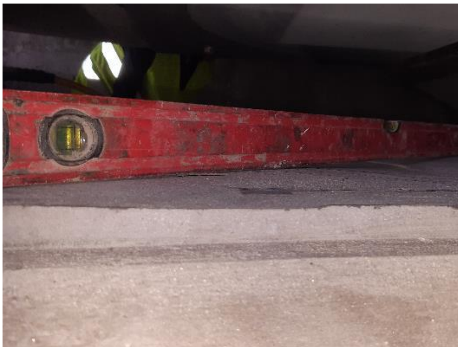
Slika 66: Neustrezno izvedeno podlivanje ležiščne plošče deformabilnega ležišča.
