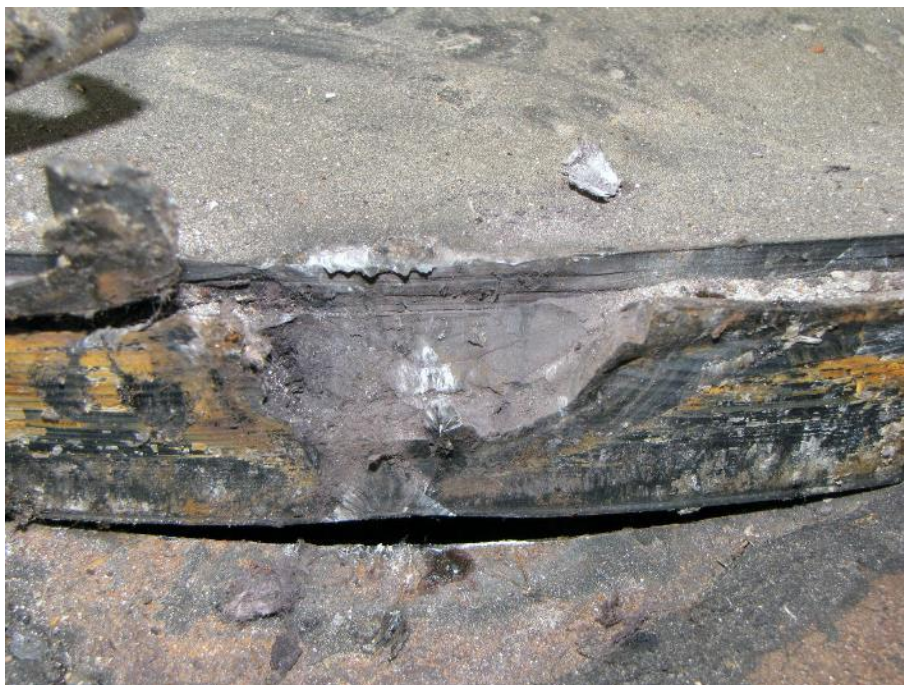
Slika 88: Lokalna poškodba elastomerne blazine na mestu iztiskanja.
