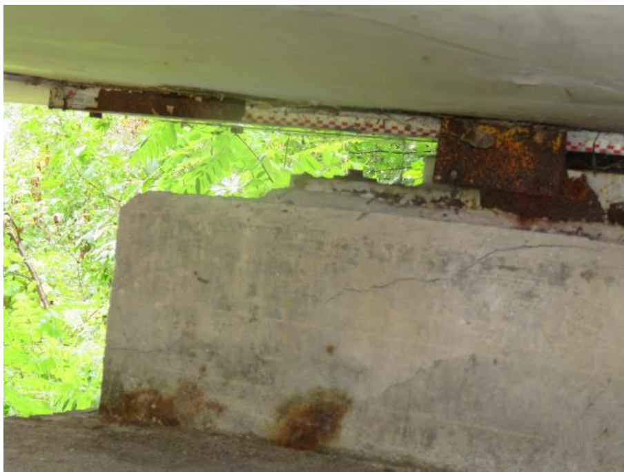
Slika 159: Strižna razpoka v betonskem ležiščnem podstavku.
