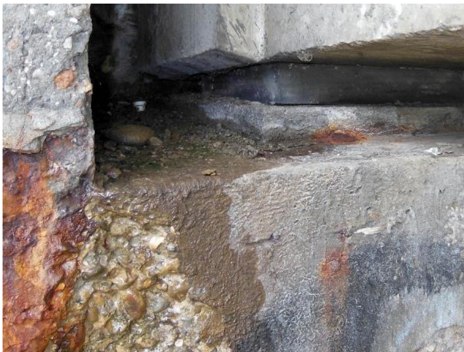
Slika 74: Stalno vlažno okolje zaradi netesne dilatacije. Propadanje ležiščne blazine.
