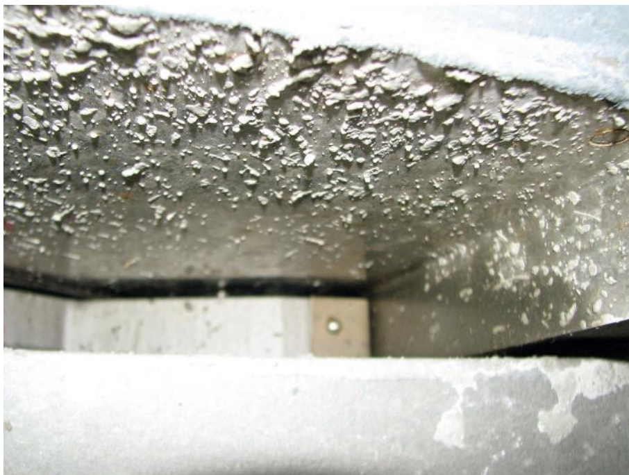
Slika 109: Umazana drsna površina z betonskim obrizgom.
