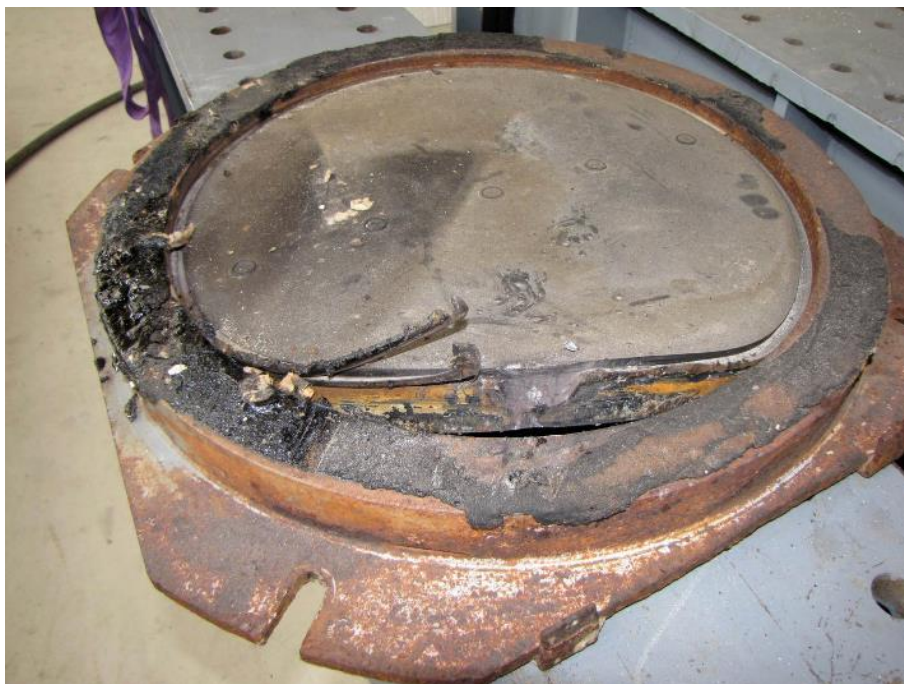
Slika 87: Poškodovana elastomerna blazina na mestu iztiskanja. Notranje tesnilo je iz teflona.
