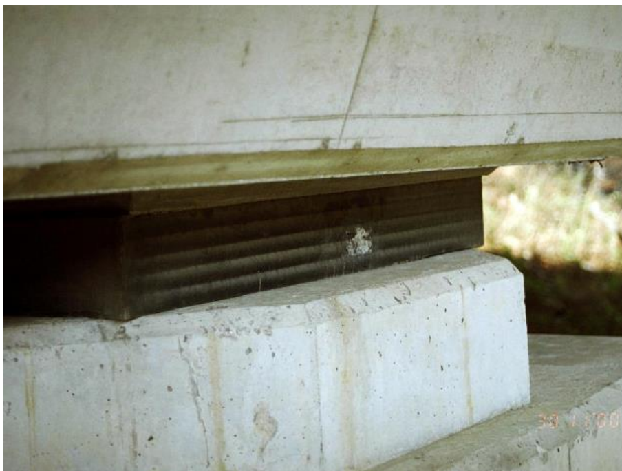
Slika 61: Nepravilna zamenjava oblike deformabilnega ležišča po že izvedenem ležiščnem podstavku.
