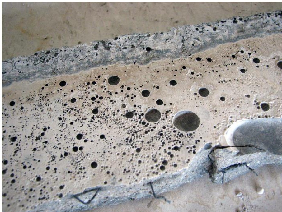
Slika 47: Zračni mehurji v kontaktni površini podlivne malte s prekladno konstrukcijo.
