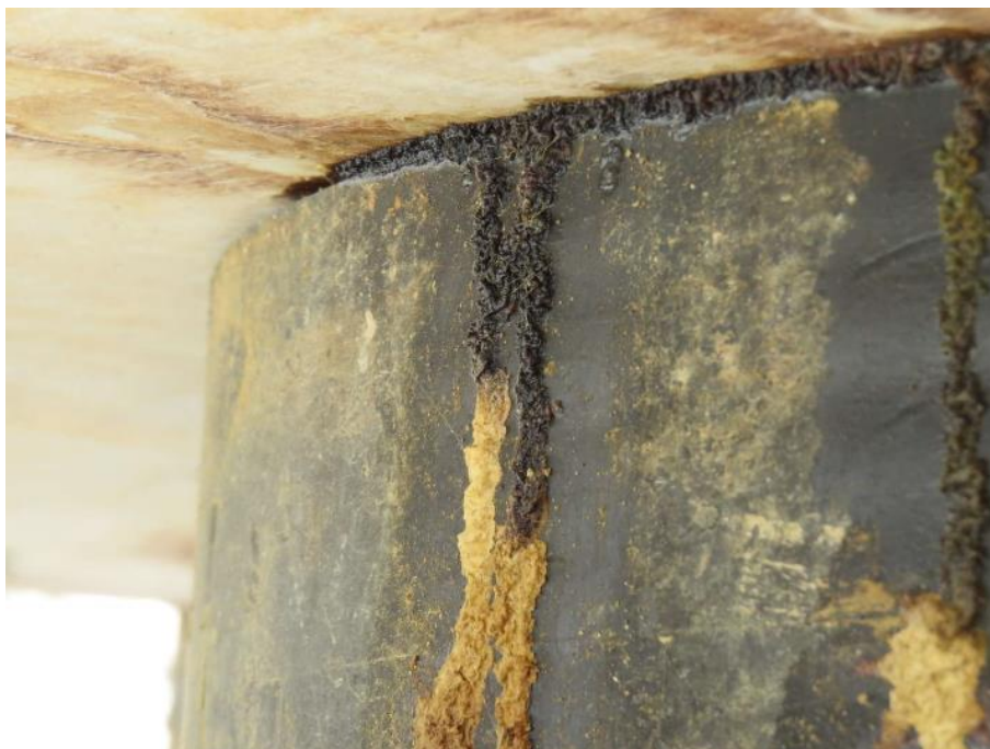
Slika 67: Nedovoljeno lepljenje elastomernega ležišča s prekladno konstrukcijo s pomočjo epoksidnega lepila, ki ni ustrezno zreagiralo in ostalo v mehki konsistenci. Sloj deluje kot mazivo.
