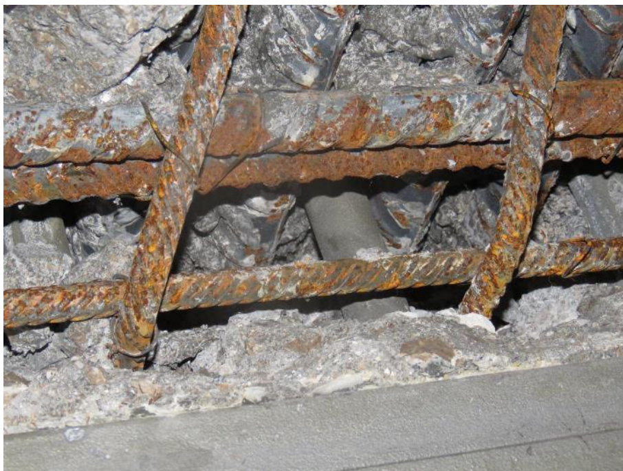
Slika 138: Betonsko gnezdo nad ležiščem zaradi napake pri vgrajevanju in pregoste armature.
