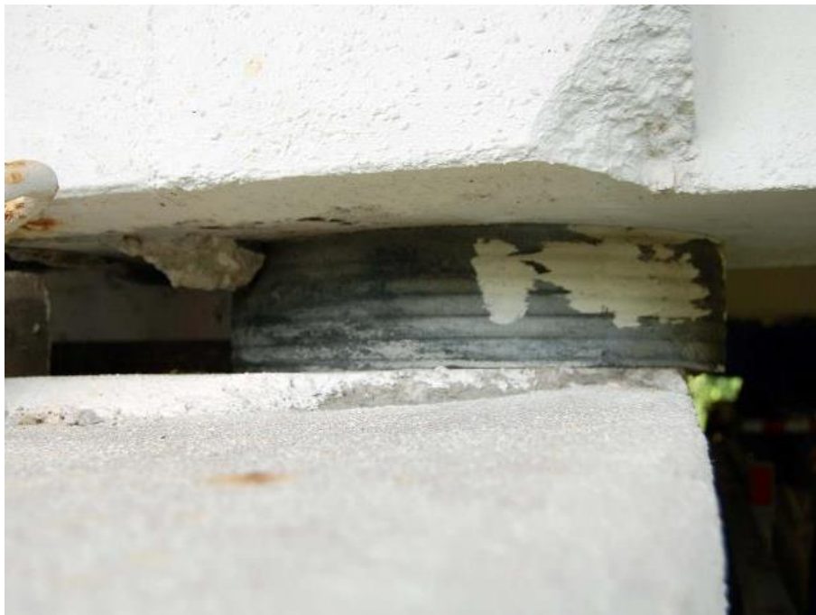
Slika 11: Zdrs elastomernega ležišča preko roba prečnega nosilca vmesne podpore. Ležišče vgrajeno preblizu roba prečnega nosilca.
