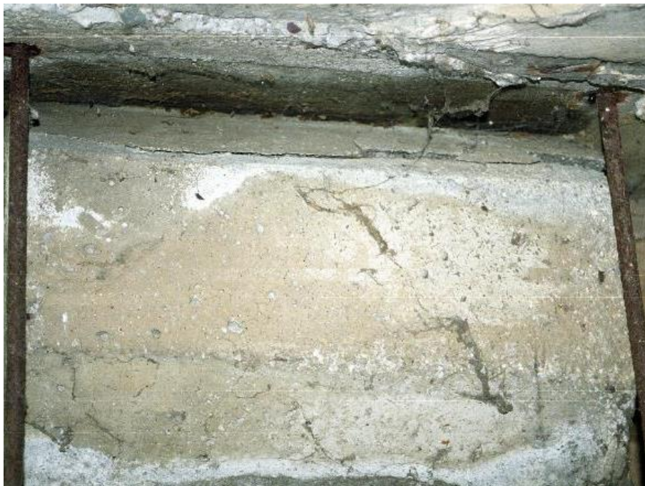
Slika 151: Betonsko valjčno ležišče – delaminacija betona na vrhu ležišča.
