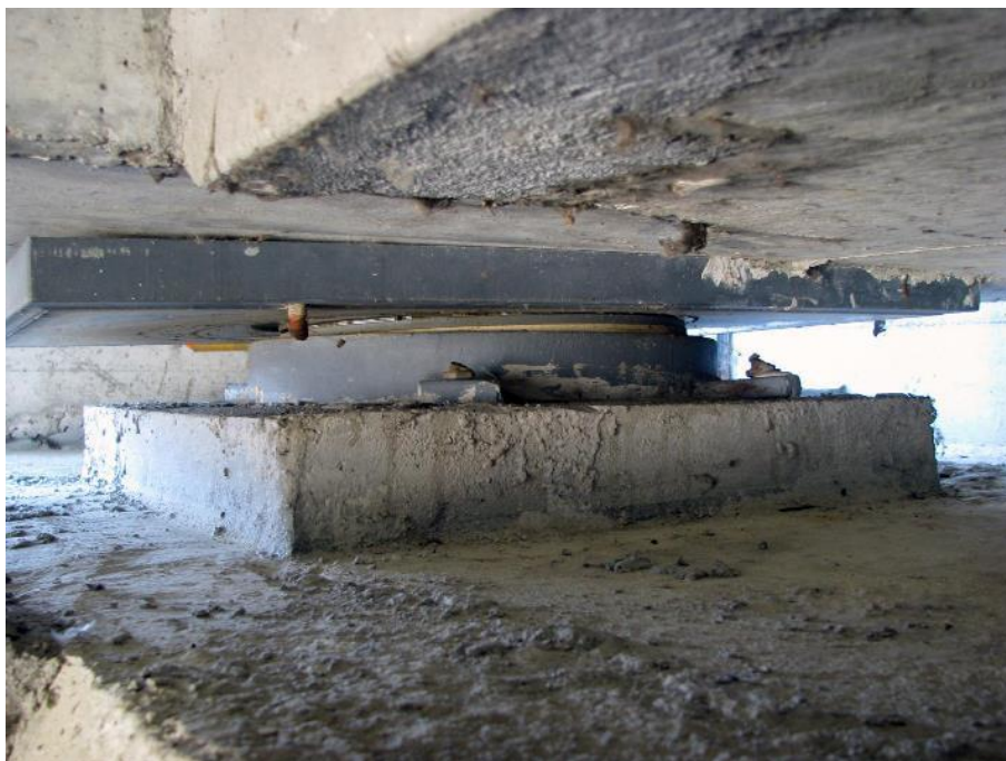
Slika 129: Prevelik zasuk lončnega ležišča. Drsna plošča ni v popolnem kontaktu s prekladno konstrukcijo – spodnjo površino montažnega prednapetega betonskega nosilca.
