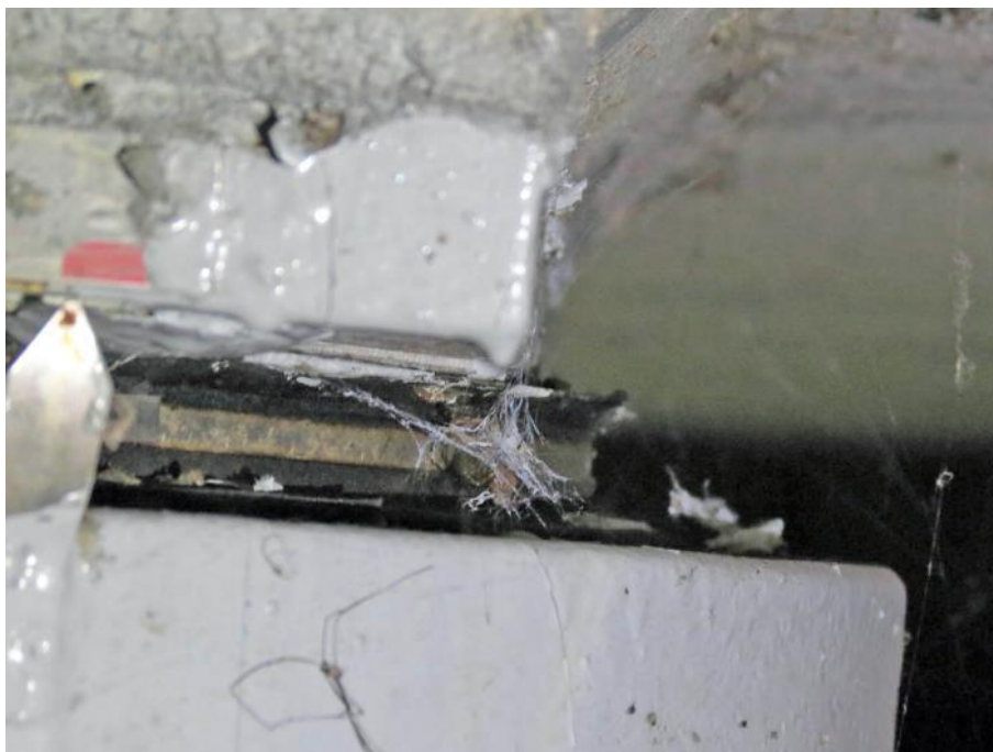
Slika 115: Prevelik pomik vodenega drsnega ležišča. Rob drsne plošče na drsnem disku.
