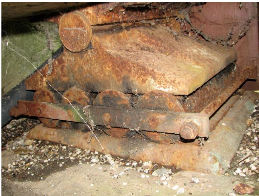
Slika 146: Več valjčno ležišče – korozija zaradi zamakanja.
