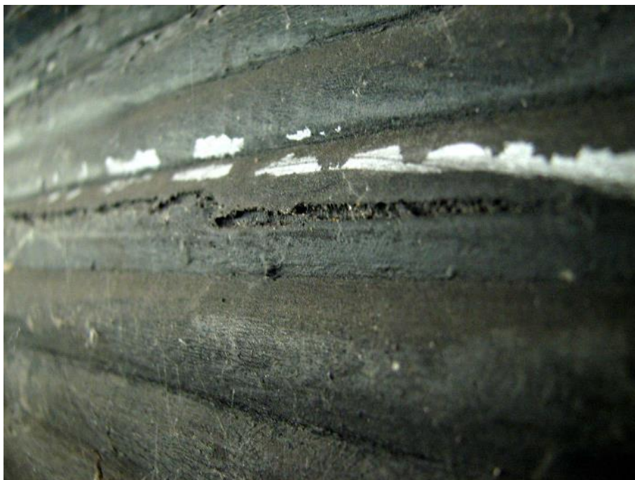
Slika 28: Razpoka zaradi slabe kvalitete krovne plasti elastomerja.
