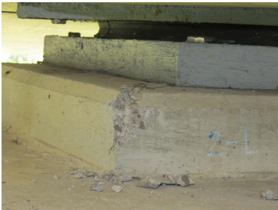
Slika 118: Strižna razpoka v betonskem ležiščnem podstavku.
