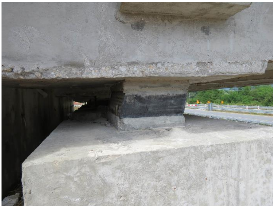
Slika 3: Nepravilna vgradnja elastomernega bloka s spodnjo in zgornjo ležiščno blazino iz malte, ki je v neposrednem v kontaktu z ležiščem. Blazine so enakih dimenzij kot ležišče. Krušenje vogalov blazine zaradi deformacije ležišča.
