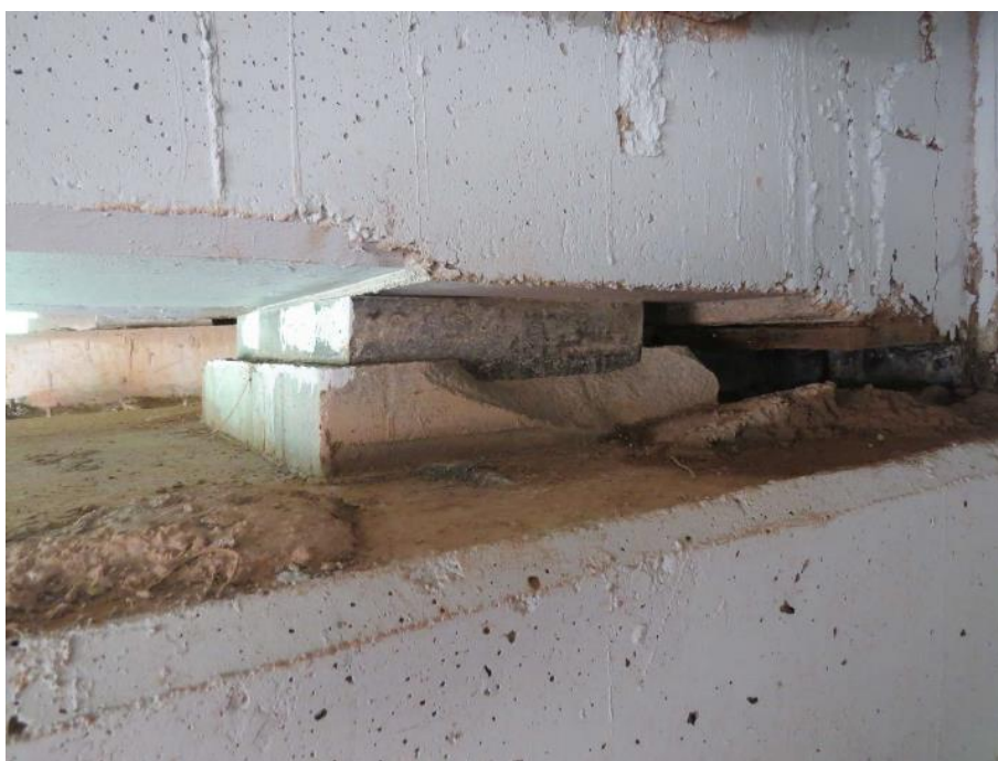
Slika 58: Neustrezna in nepravilna vgradnja elastomernega ležišča pod betonskim montažnim nosilcem.
