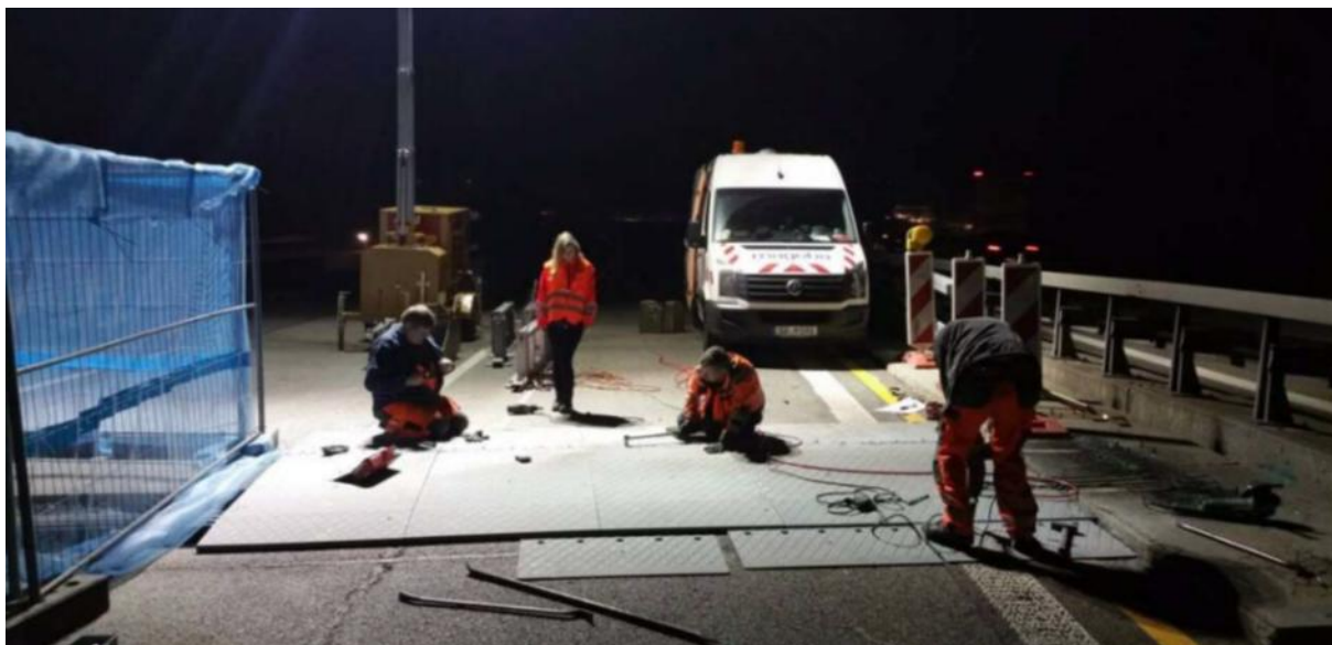
Slika 8.8: Montaža začasne premostitve gradbene odprtine cestne dilatacije z jeklenimi premostitvenimi ploščami (vir: mageba Švica)
