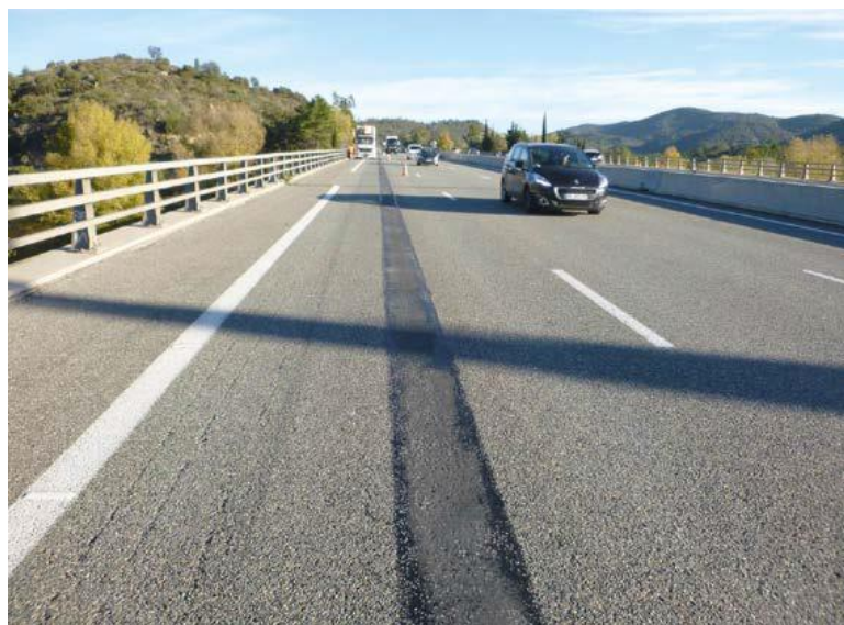
Slika 3.6: Primer vzdolžne asfaltne dilatacije pri razširitvi cestnega premostitvenega objekta preko več polj za počasni in odstavni pas
