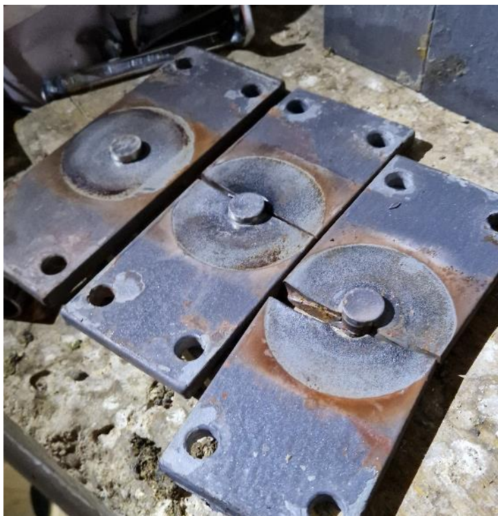
Slika 13.15: Zaradi resonance lamelne dilatacije, tudi zaradi premajhne togosti prekladne betonske konstrukcije je drsni in krmilni sistem dilatacije odpovedal (na sliki lom jeklenih podstavkov za drsna ležišča)
