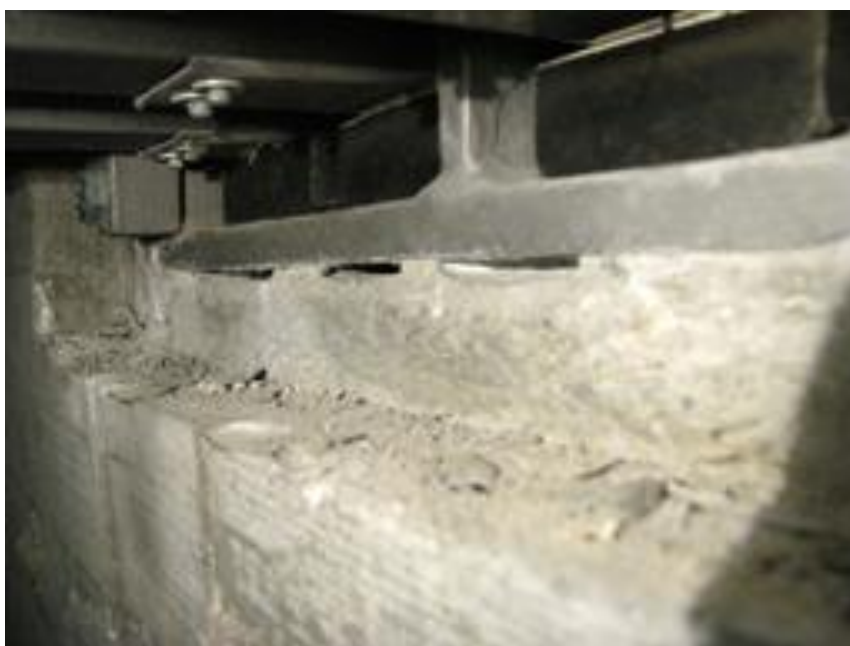
Slika 13.8: Primer škatle krmilnega sistema (grednega) lamelne dilatacije – porozna mesta betona pod škatlo
