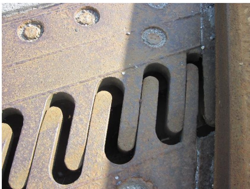
Slika 13.2: Primer neustrezne zasnove sheme spodnjih ležišč objekta - stikovanje glavnikov dilatacije zaradi polarnih vektorjev pomikov
