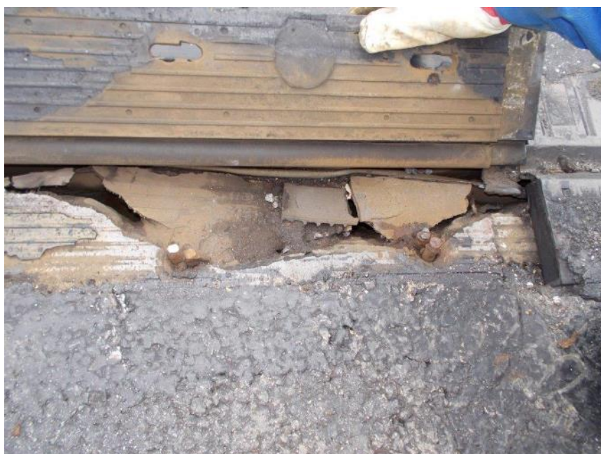
Slika 13.6: Primer poškodbe zaradi neustrezne vgradnje sidrnega sistema dilatacije – lom spodnjega robnega profila betona in povezave z blazinasto ploščo, kljub dodatnim sidrom ob obstoječih
