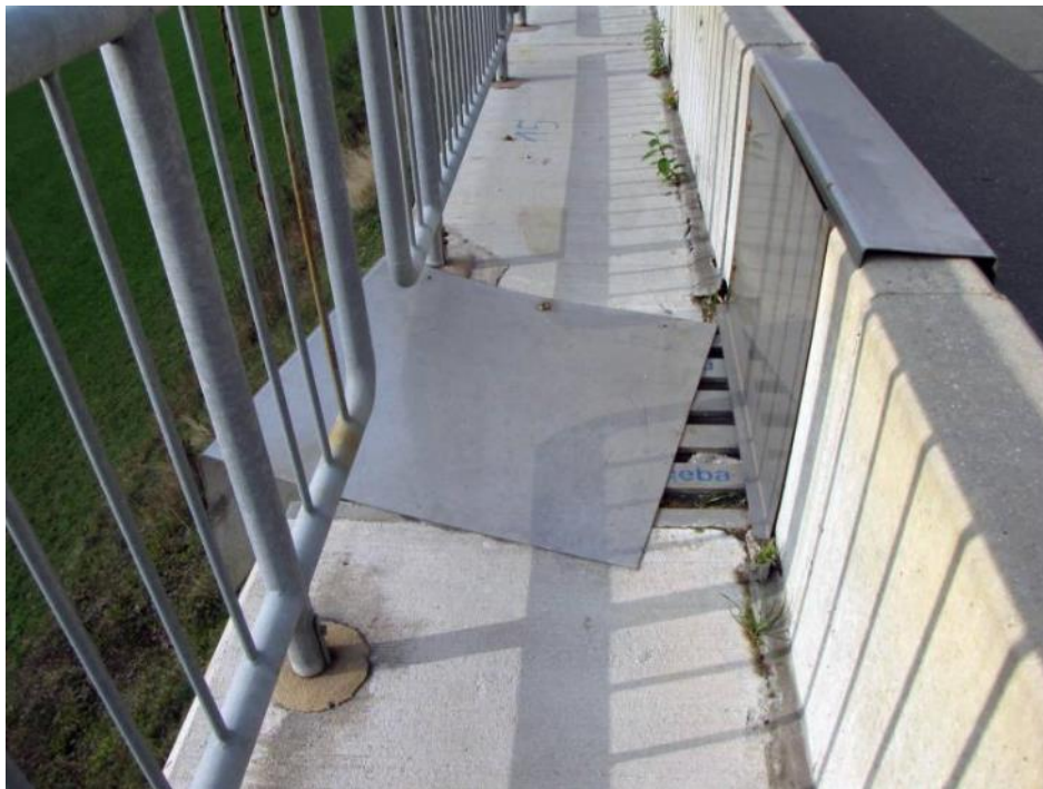
Slika 13.36: Poškodba -zasuk zaščitne pločevine na dilataciji ob dilatacij z betonsko varnostno ograjo zaradi neustrezne izvedbe in ročnem mehanskem čiščenju snega
