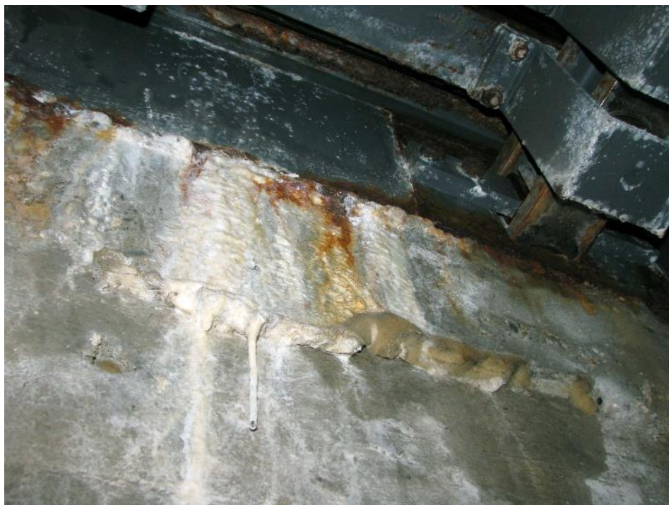
Slika 13.32: Resne poškodbe betona spodnje konstrukcije zaradi vodonetnosti tesnilnih trakov ali odpovedi priključka hidroizolacije vozišča k dilataciji
