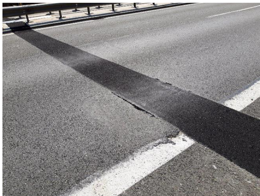
Slika 13.18: Poškodbe polimernih fleksibilnih dilatacij zaradi nezdržljivosti stikov z asfaltnim voziščem
