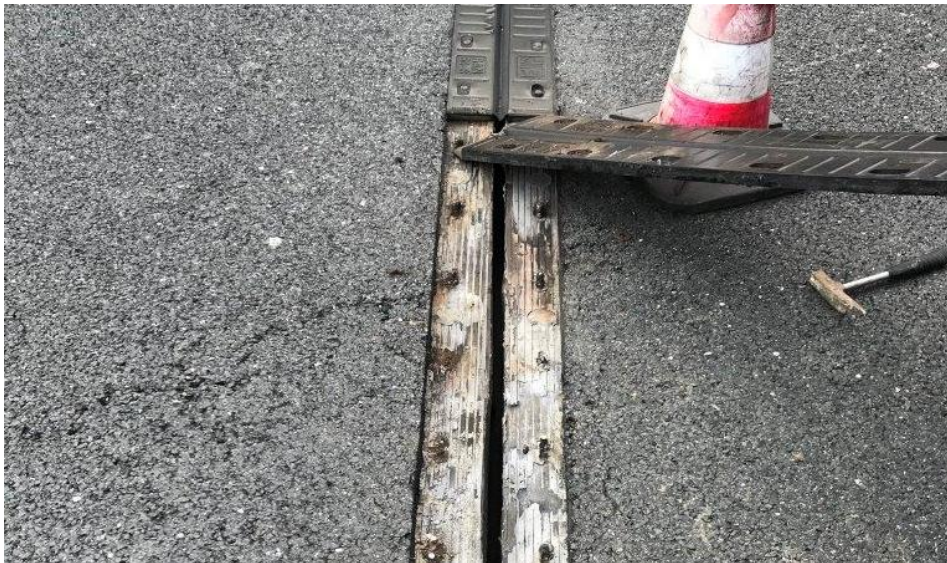
Slika 13.21: Popuščanje prednapetih vijakov blazinaste dilatacije zaradi neravne podlage
