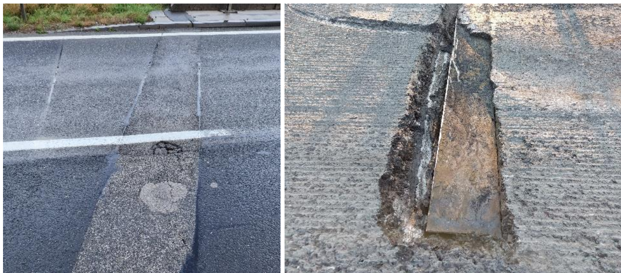
Slika 13.20: Poškodbe asfaltnih dilatacij zaradi pomanjkljive utrditve premostitvene pločevine (»T« jeklen profil v regi objekta-slika desno)
