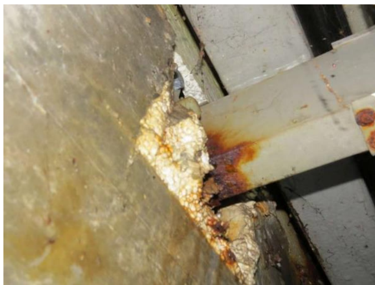
Slika 13.25: Poškodbe protikorozijske zaščite jeklene dilatacije zaradi kondenza pri neodstranjenem začasnem opažu in zaščite betoniranja (EPS plošče)
