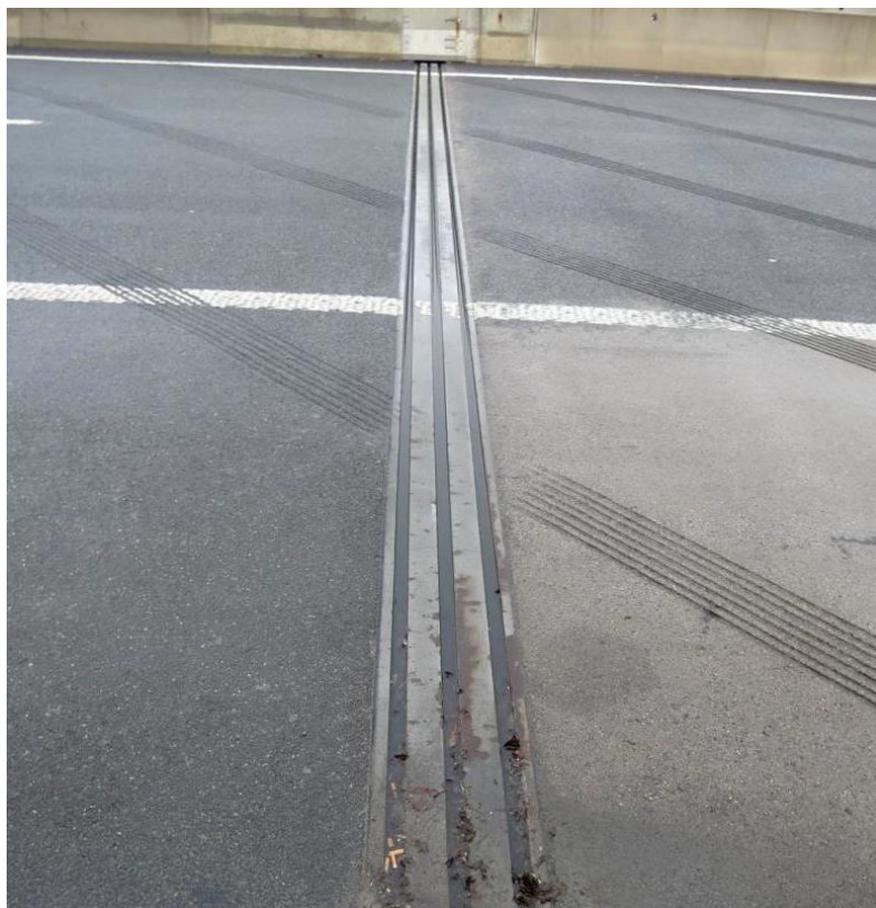
Slika 13.26: Zastajanje vode v regah lamelne dilatacije - dopolnilno izvedeno površinsko dreniranje meteorne vode s cestišča z rebričenjem, zaradi premajhnega prečnega sklona in ker cevke za pronicujočo vodo mogoče ne delujejo zaradi zasiganosti
