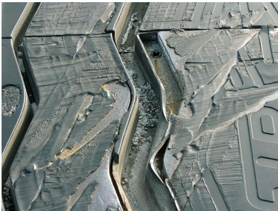
Slika 13.13: Končne posledice rezila snežnega pluga, spuščenega do ravnine dilatacije – pluzenje na »črno« - razgradnja blazinaste dilatacije med dilatiranjem
