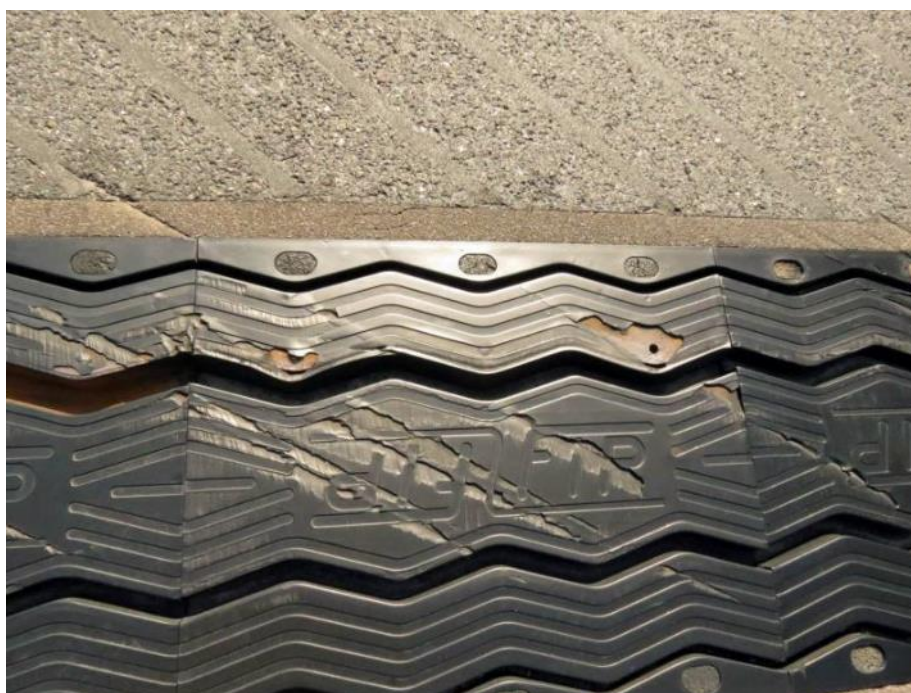
Slika 13.12: Posledice rezila snežnega pluga spuščenega do ravnine dilatacije – pluzenje na »črno« - začetne poškodbe na blazinasti dilataciji
