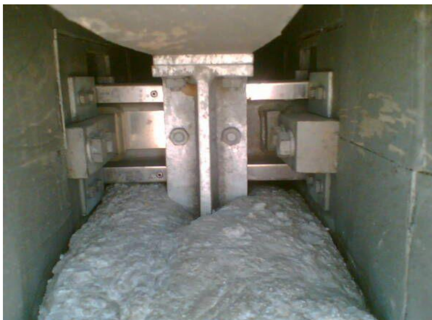
Slika 13.10: Primer prodora betona v škatlo zaradi popuščanja opaža – z betonom obrito streme z drsnimi ležišči ne more delovati
