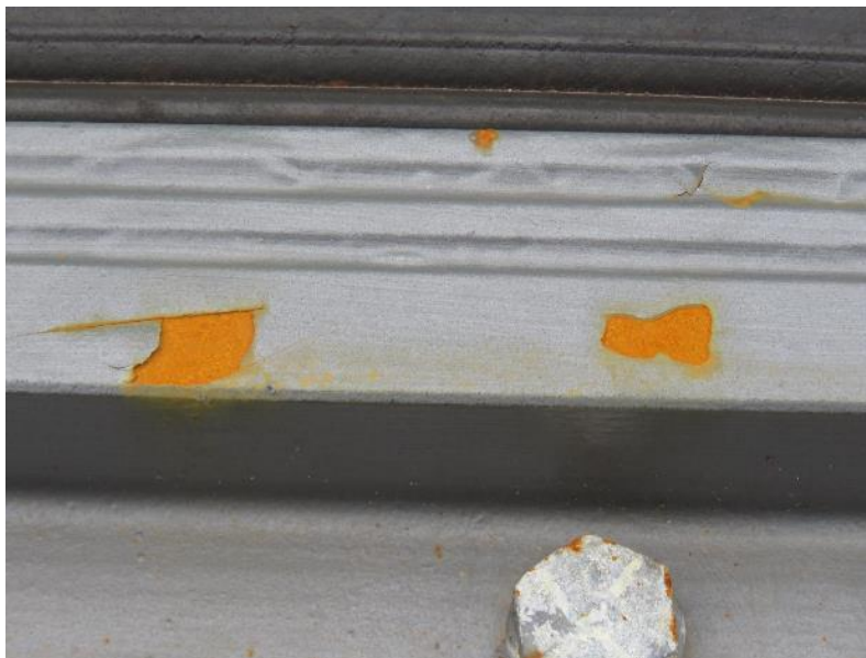
Slika 13.24: Poškodbe protikorozijske zaščite jeklenega robnega profila železniške blazinaste dilatacije zaradi nepravilnega skladiščenja
