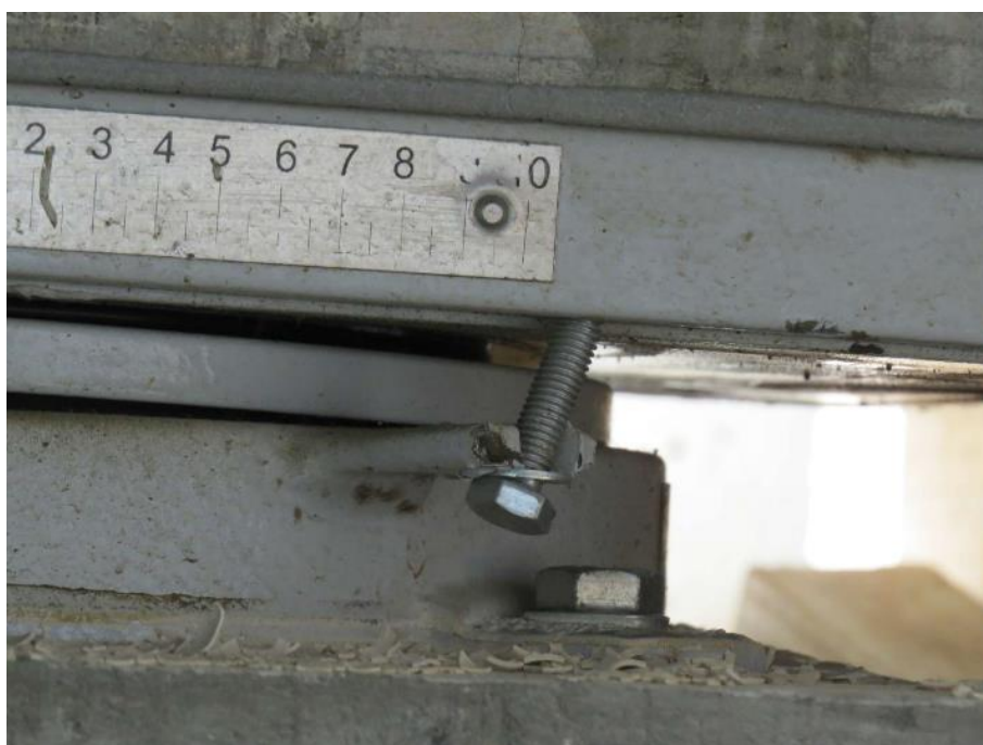
Slika 128: Vijak ključavnice za fiksiranje ležišča za fazo transporta in vgradnje po vgradnji ležišča ni bil sproščen.
