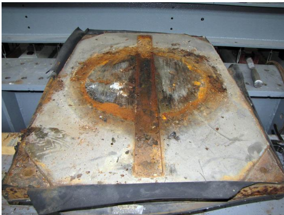
Slika 98: Korozijske poškodbe drsne plošče.
