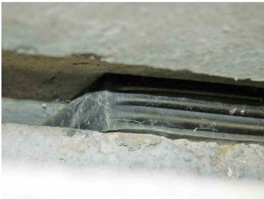
Slika 17: Nepravilna vgradnja elastomernega ležišča na rob ležiščne blazine. Prisotno zdrsavanje ležišča. Zaradi neenakomernega naleganja in velikih lokalnih robnih napetosti prisotne izrazite gube na čelni površini.
