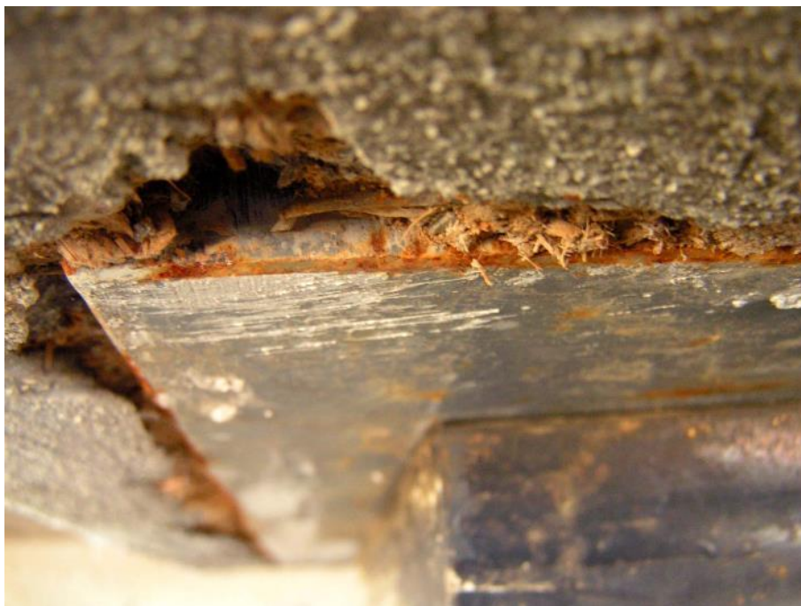
Slika 49: Napaka pri vgradnji zgornje ležiščne plošče. Neočiščena površina okoli stika zgornje ležiščne plošče z opažem ležiščne blazine pred pričetkom betoniranja.
