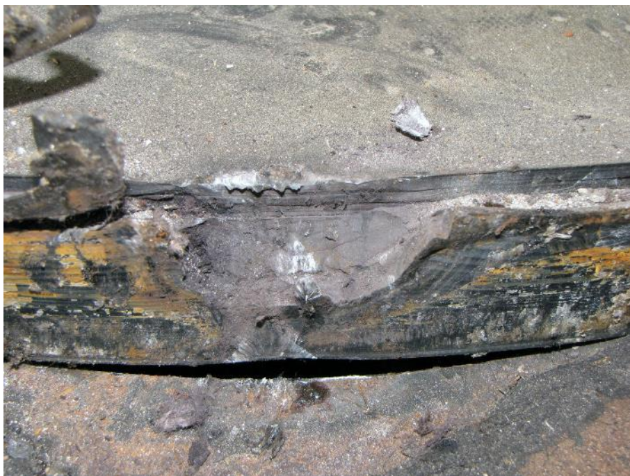
Slika 88: Lokalna poškodba elastomerne blazine na mestu iztiskanja.
