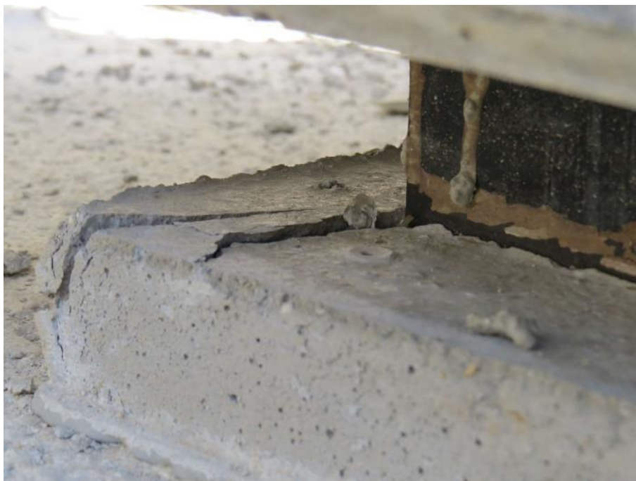
Slika 59: Neustrezna in nepravilna vgradnja elastomernega ležišča pod betonskim montažnim nosilcem. Ležišče zalito v podlivno malto.
