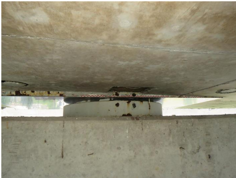
Slika 125: Nepravilno vgrajeno drsno ležišče, drsna plošča vgrajena v prekladno konstrukcijo.
