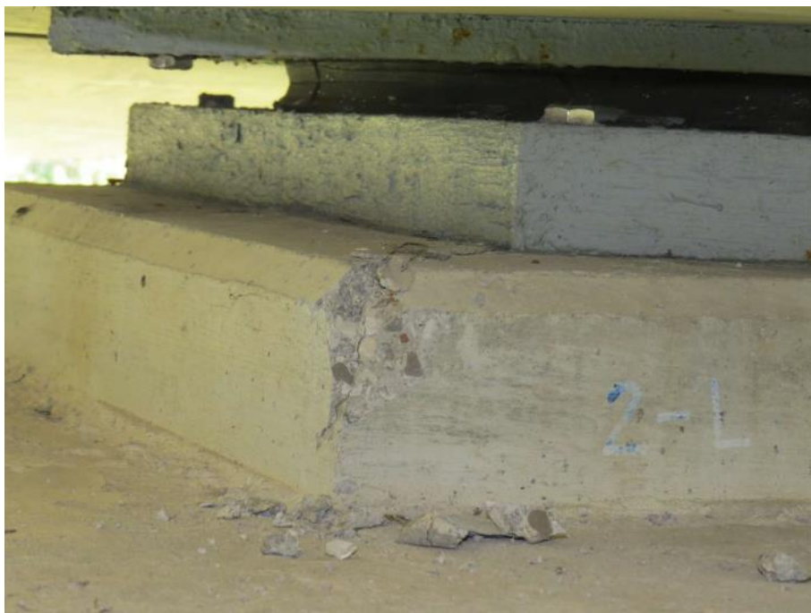
Slika 118: Strižna razpoka v betonskem ležiščnem podstavku.
