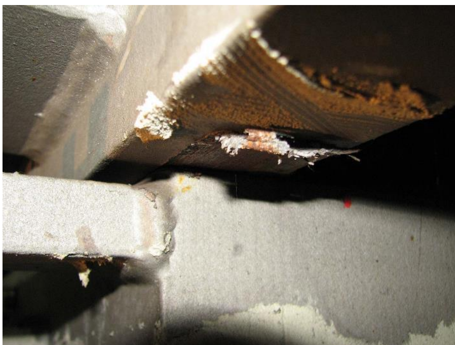
Slika 102: Poškodovana AKZ vodila zaradi drsenja po loncu. Vodilo nasedlo na rob lonca.
