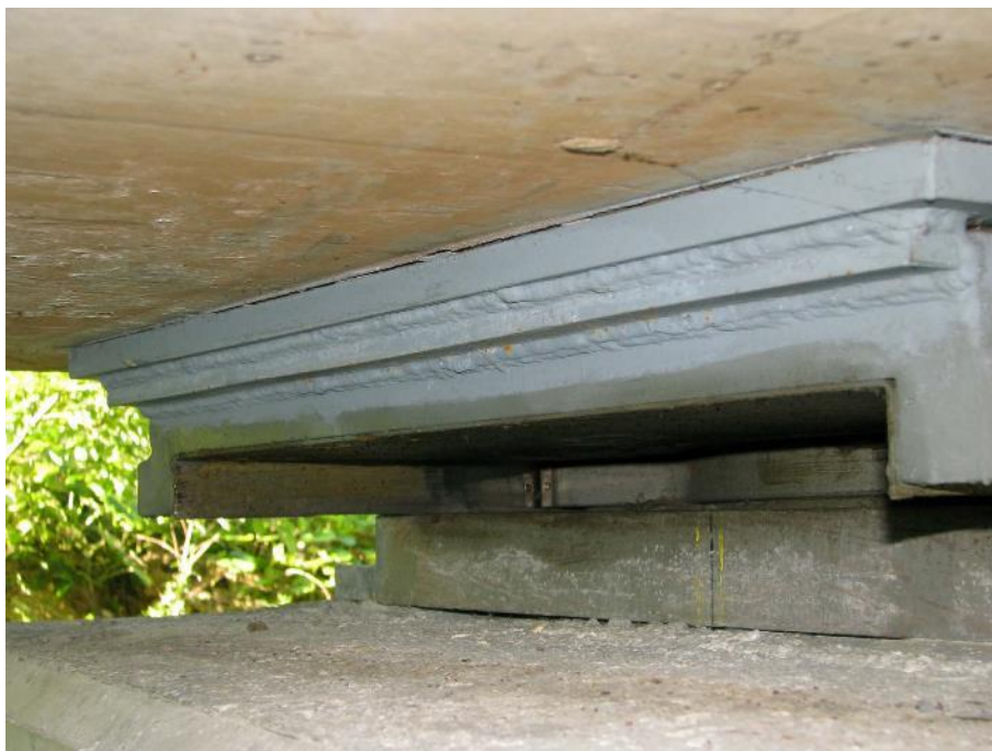
Slika 107: Nepodliti stik med loncem in betonskim podstavkom.
