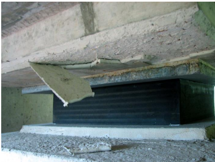
Slika 51: Nekvalitetno izveden zgornji ležiščni blok.
