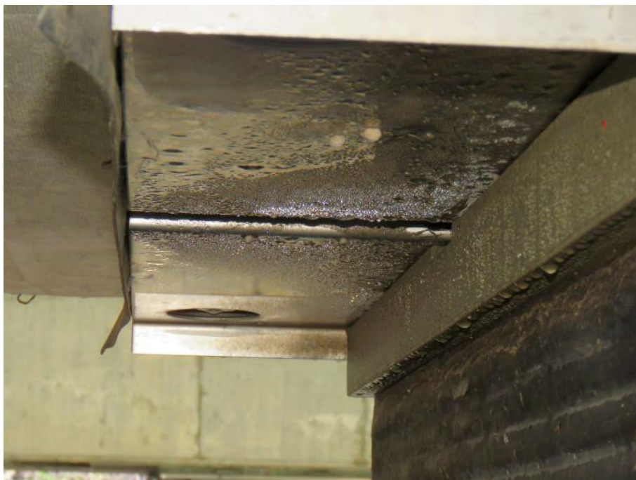
Slika 167: Kondenčna voda na površini ležišča. Ob neustrezni ali poškodovani protikorozijski zaščiti je generator korozijskih procesov.
