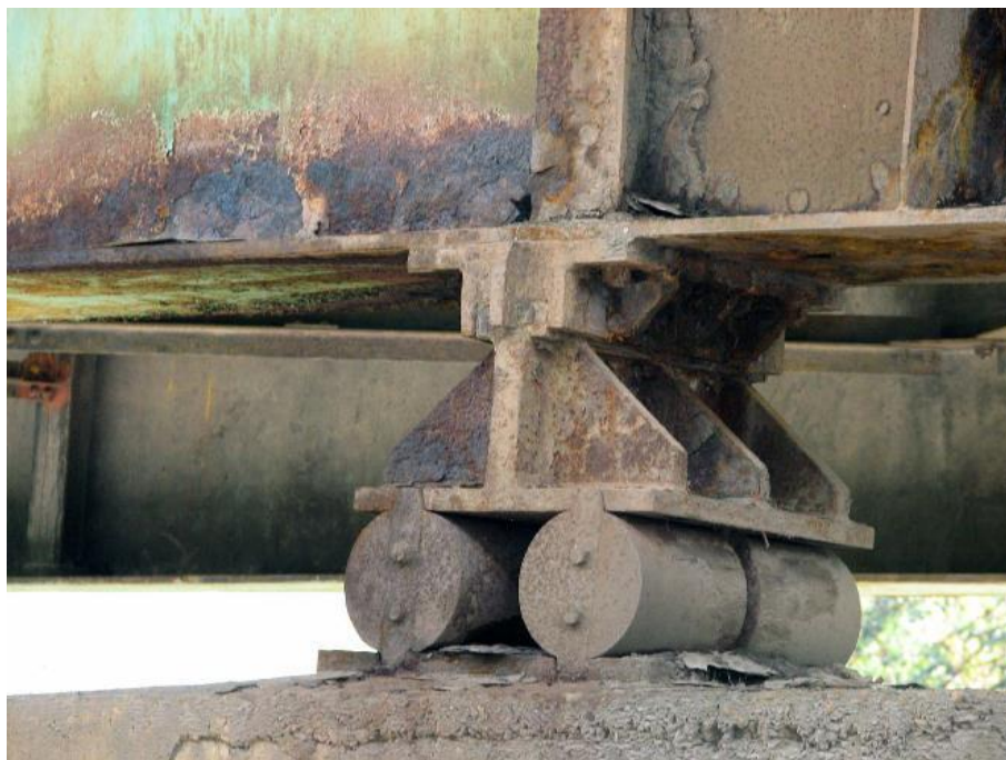
Slika 145: Dvojno valjčno ležišče – korozija zaradi zamakanja.
