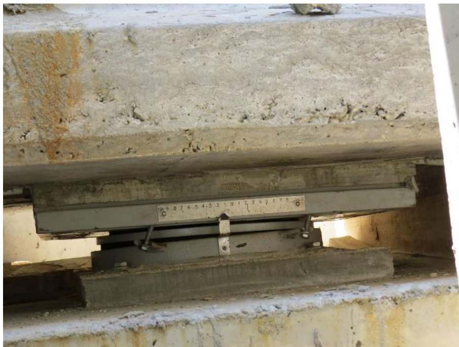
Slika 127: Prevelik zasuk lončnega ležišča pod montažnim betonskim nosilcem.
