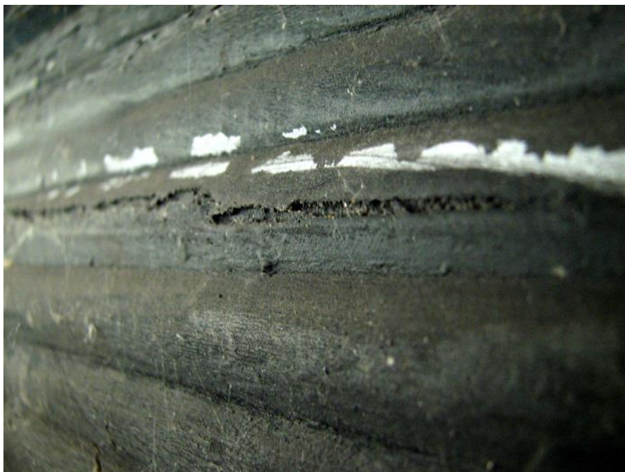
Slika 28: Razpoka zaradi slabe kvalitete krovne plasti elastomerja.
