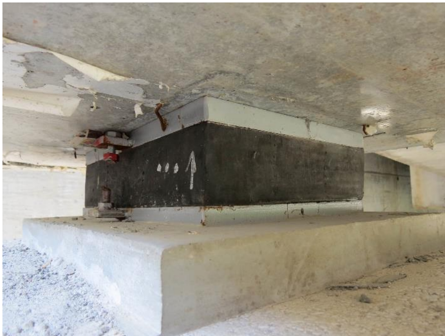
Slika 4: Elastomerno ležišče z ležiščnima ploščama brez minimalnih previsov. Prekladna konstrukcija samo položena na ležišče, ni vidne stične malte med prekladno konstrukcijo in zgornjo ležiščno ploščo.
