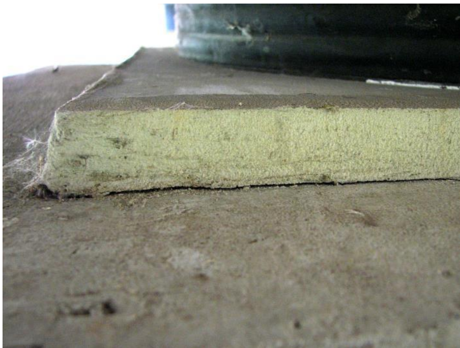
Slika 76: Odprti stik vogala spodnje ležiščne plošče s spodnjim betonskim ležiščnim podstavkom.
