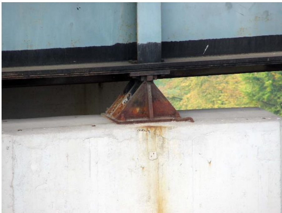
Slika 142: Linijsko nagibno ležišče – korozija.
