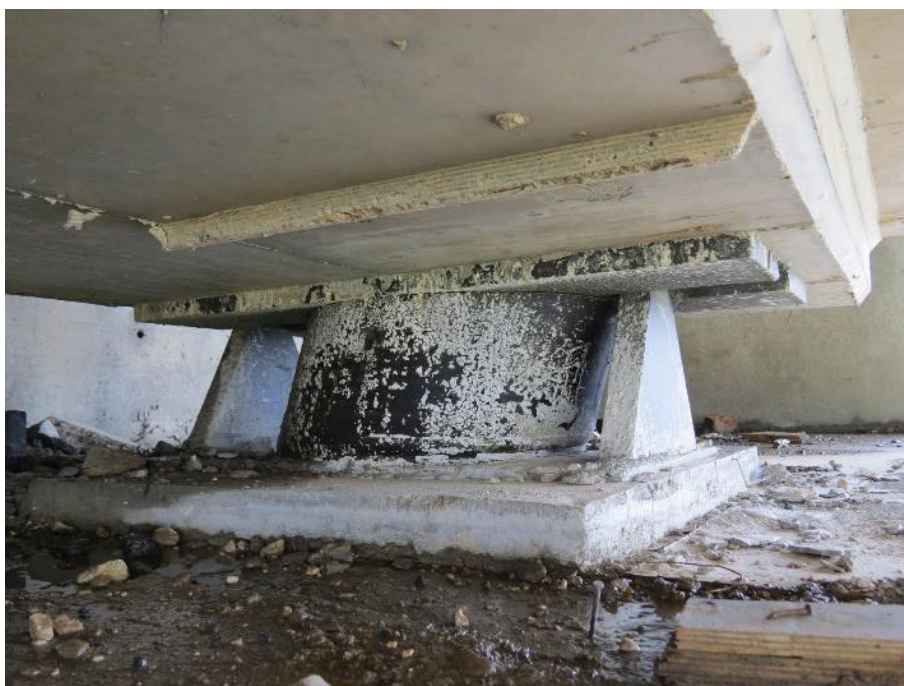
Slika 2: Umazana površina elastomernega ležišča s pridrževalno konstrukcijo za vzdolžno in prečno smer. Premajhen previs spodnje in zgornje ležiščne plošče v prečni smeri.
