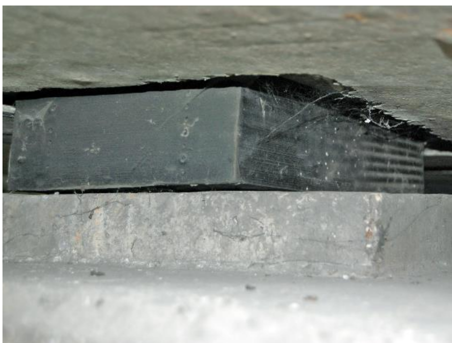
Slika 10: Neenakomerno naleganje elastomernega ležišča na spodnji betonski blazini. Polovica ležišča praktično ni v kontaktu s spodnjo betonsko ležiščno blazino.
