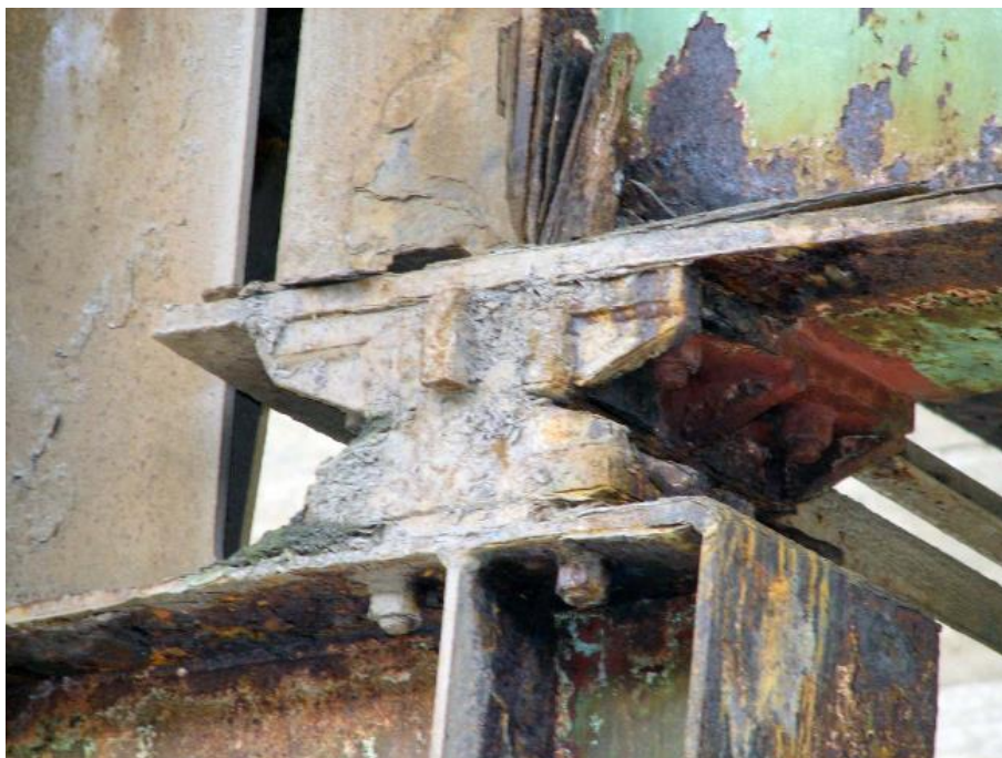
Slika 143: Linijsko nagibno ležišče – močna korozija in siganje.
