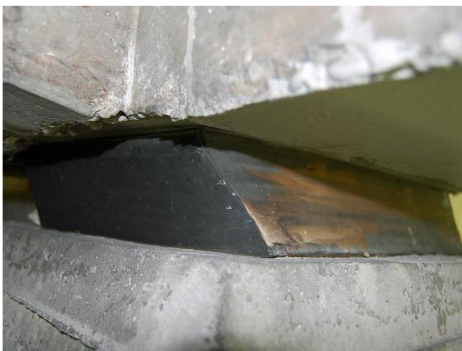
Slika 16: Neenakomerno naleganje na ležišče. Prevelika deformacija ležišča, ki je deformirano tudi okoli vertikalne osi (torzijski zasuk ležišča v horizontalni ravnini).
