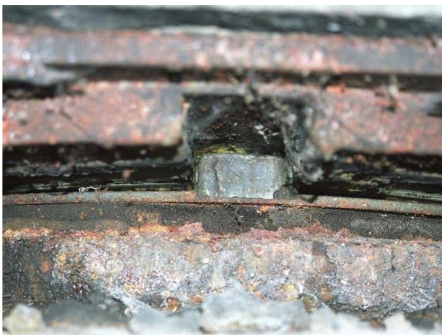
Slika 108: Korozija lončnega ležišča zaradi stalne prisotnosti vlage in umazanije na ležiščni polici.
