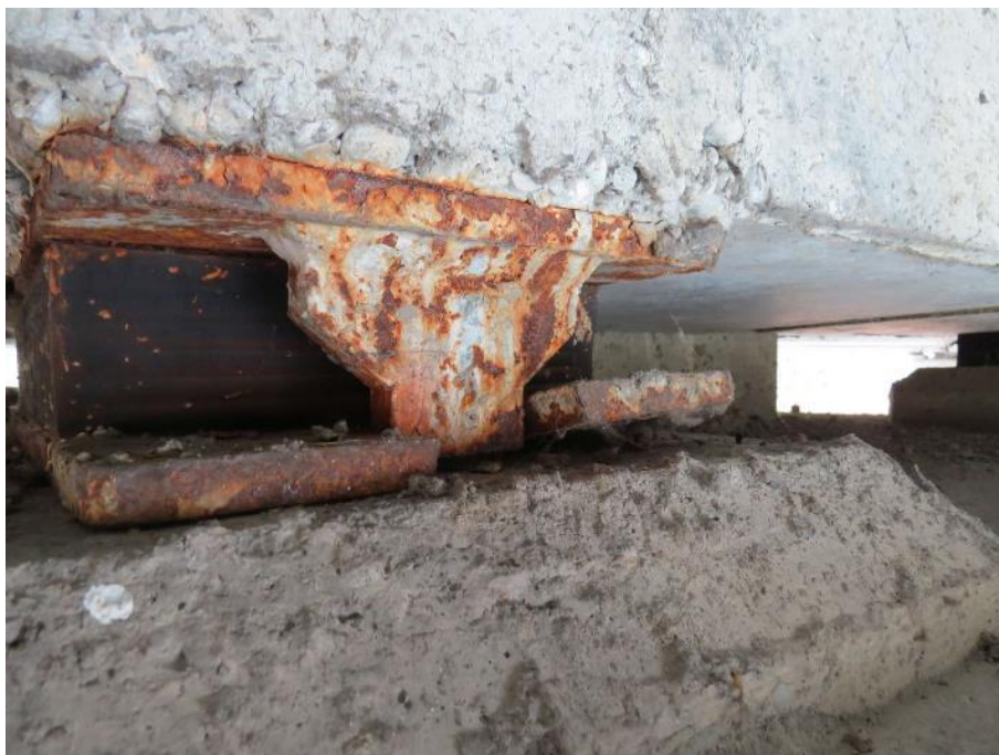
Slika 72: Korozija in deformacija jeklene pridrževalne konstrukcije elastomernega ležišča.
