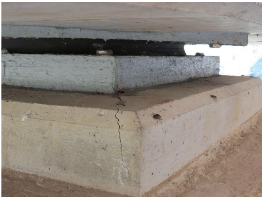
Slika 119: Strižna razpoka v betonskem ležiščnem podstavku.
