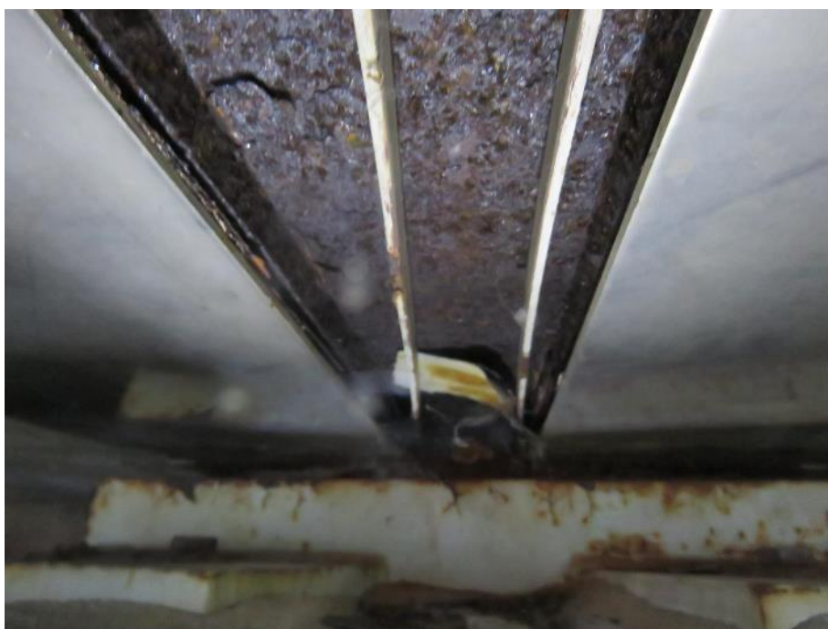
Slika 122: Korozija v utoru drsne plošče lončnega ležišča. Odstopanje drsni parov (bočni drsni trak in bočna nerjavna pločevina) v utoru drsne plošče.
