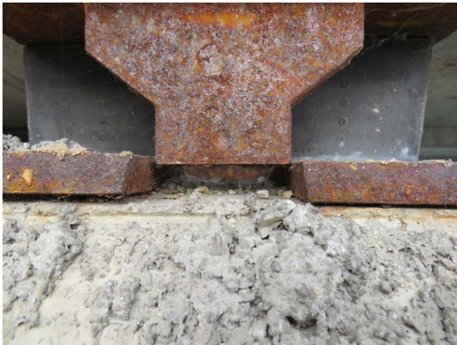
Slika 73: Korozijska in deformacijska poškodba jeklene pridrževalne konstrukcije elastomernega ležišča. Neustrezna izvedba – strižni trn je nad zgornjim robom spodnje ležiščne plošče.
