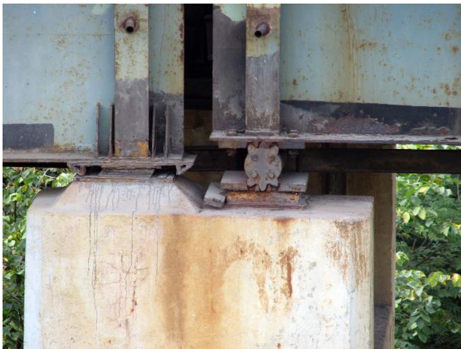
Slika 144: Enojno valjčno ležišče – korozija.
