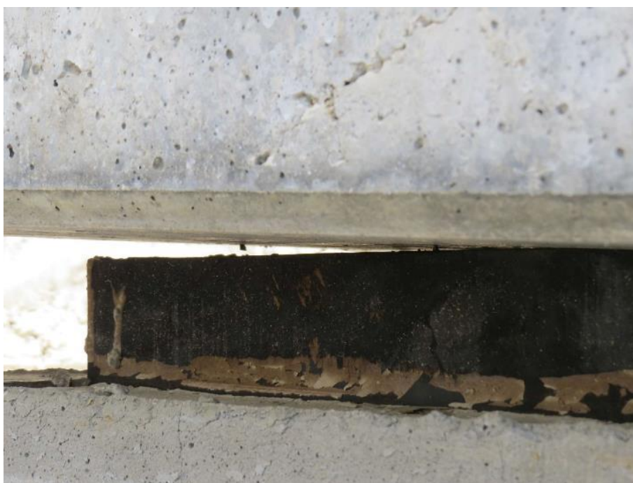
Slika 60: Neustrezna in nepravilna vgradnja elastomernega ležišča pod betonskim montažnim nosilcem. Ležišče zalito v podlivno malto. Povezava ležišča z montažnim nosilcem ni bila rešena.
