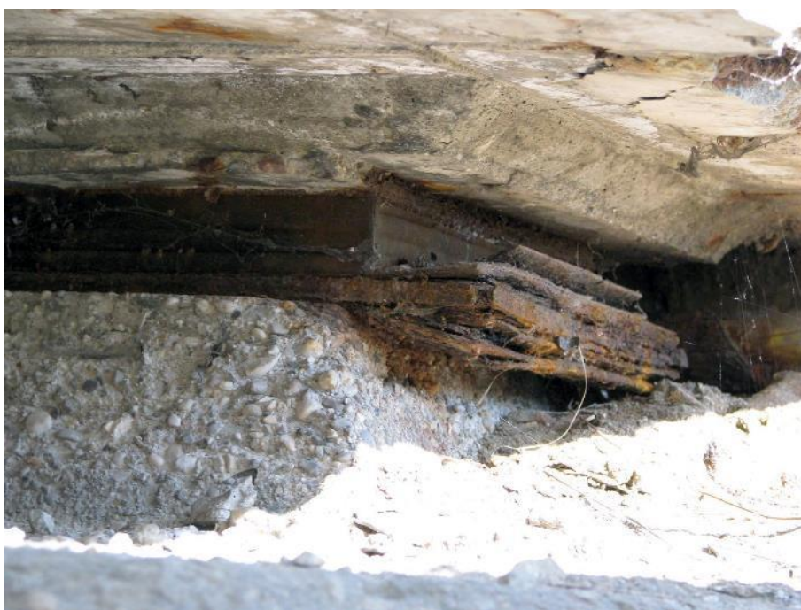
Slika 70: Močna korozija ležiščnih in podložnih plošč v stalnem vlažnem okolju zaradi netesne dilatacije. Propadanje ležiščne blazine.
