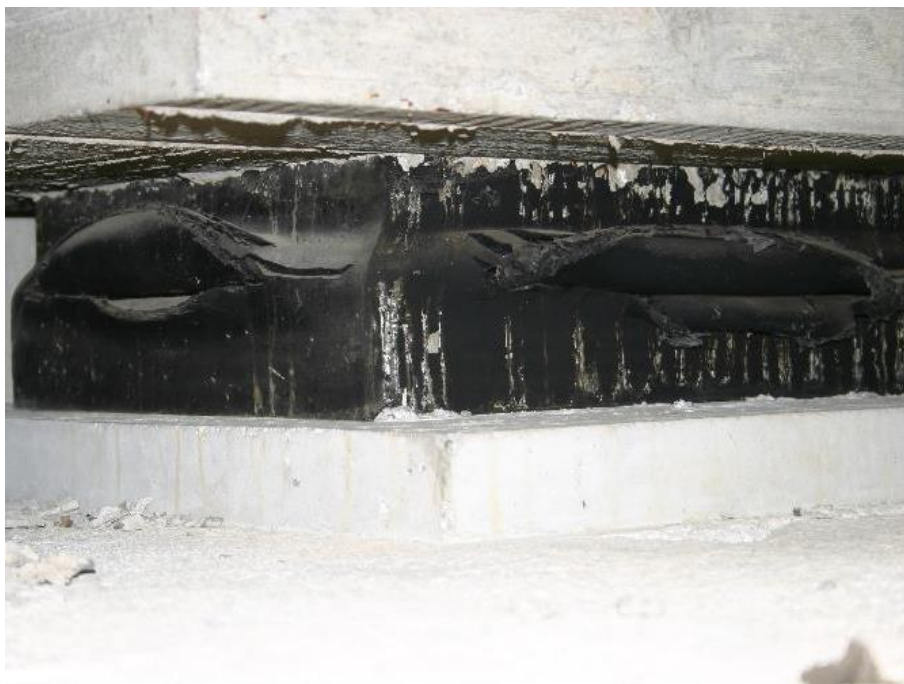
Slika 23: Razpoka na stiku med jekleno ploščo in elastomerjem zaradi neustreznega postopka vulkanizacije.
