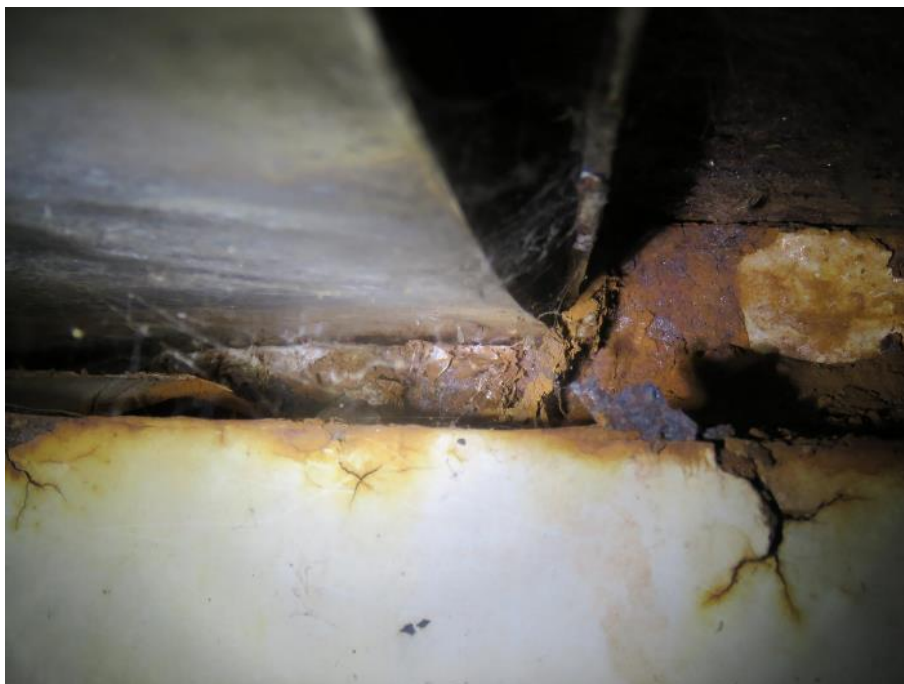
Slika 123: Naleganje drsne plošče na rob batnice lončnega ležišča. Zaradi obrabe teflona drsna plošče v kontaktu z robom utora batnice. Deformirana drsna pločevina. Ostružki teflona.
