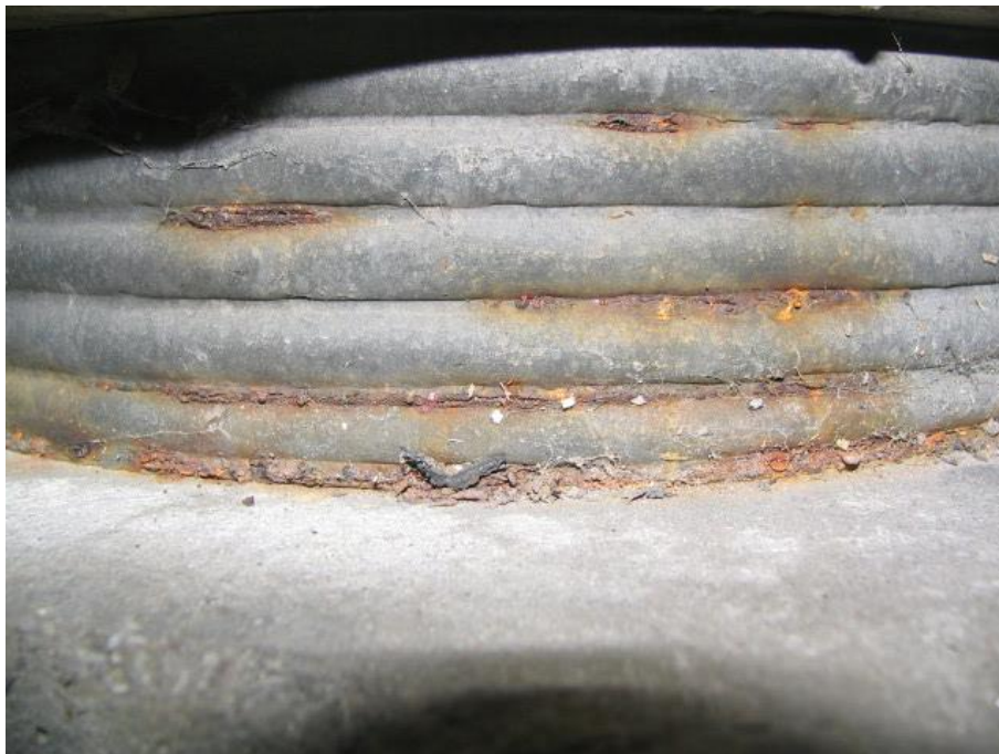
Slika 27: Korozija jeklenih vložkov elastomernega ležišča zaradi stalne prisotnosti vlage in solnice.
