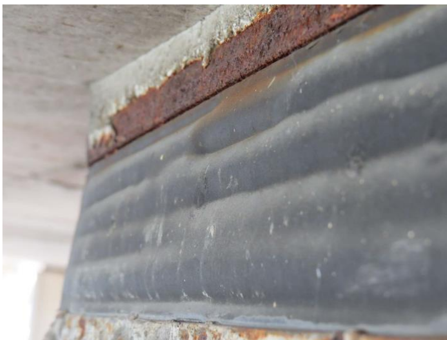
Slika 20: Popuščanje spojev med jeklenimi vložki in elastomerjem. Združevanje manjših gub v večje gube. Korozija ležiščnih plošč.
