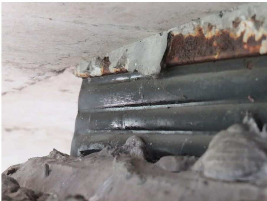
Slika 64: Pretanka debelina krovne plasti elastomerja.
