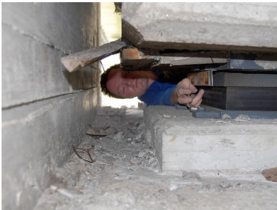
Slika 161: Kazalec pomikov in merilna skala vgrajena na napačni strani ležišča. Zaradi premajhnega razmika me ležiščem in parapetnim zidom je težko dovolj natančno oziroma je nemogoče odčitati velikost pomika.
