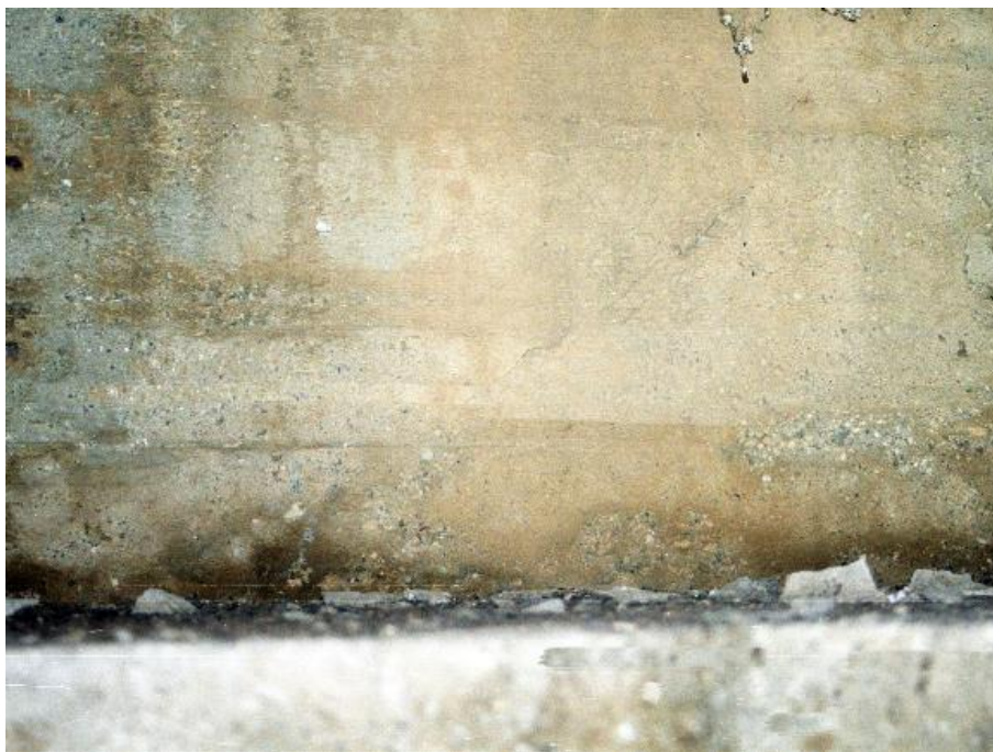
Slika 152: Betonsko valjčno ležišče – strižna razpoka.
