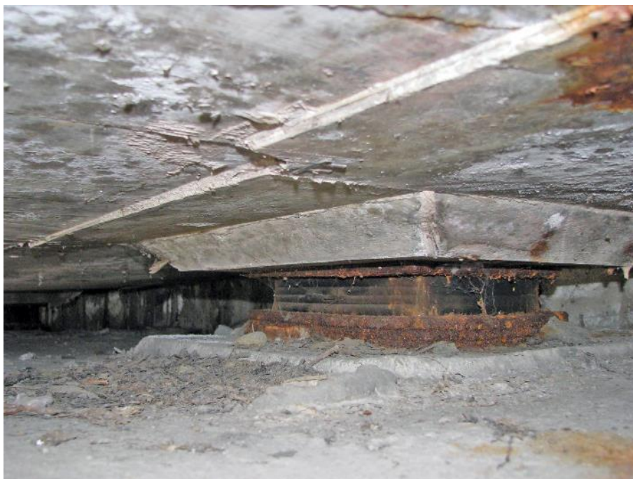
Slika 69: Močna korozija ležiščnih in podložnih plošč v stalnem vlažnem okolju zaradi netesne dilatacije.
