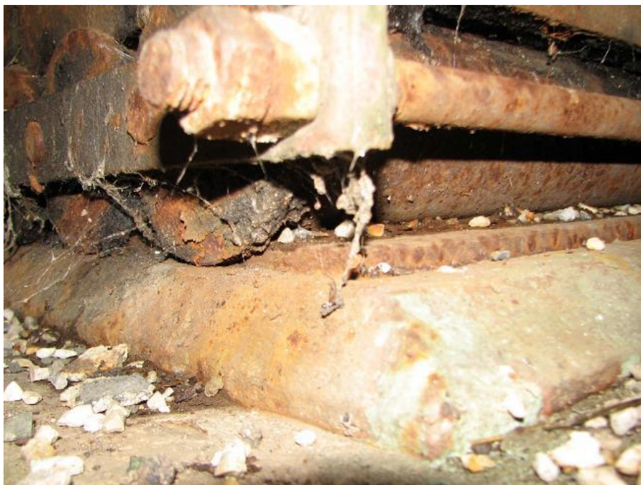
Slika 147: Več valjčno ležišče – nečista kotalna površina.
