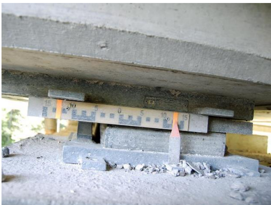
Slika 56: Prevelik pomik drsnega dela deformabilnega ležišča zaradi vgradnje ležišča v napačni smeri.
