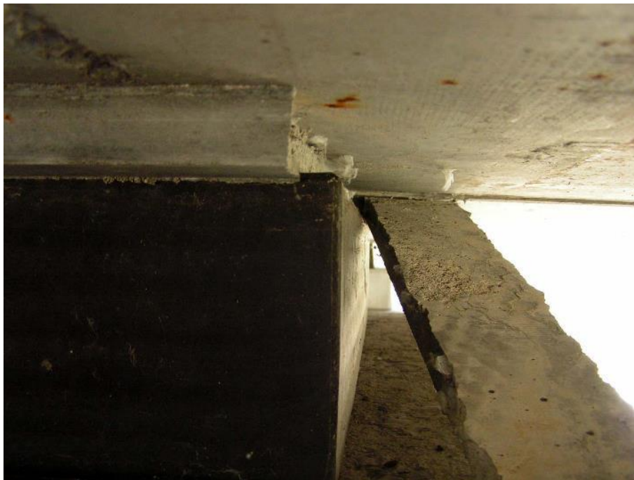
Slika 45: Odlom zgornjega venca zaradi zdrsavanja ležišča. Nepravilna izvedba.
