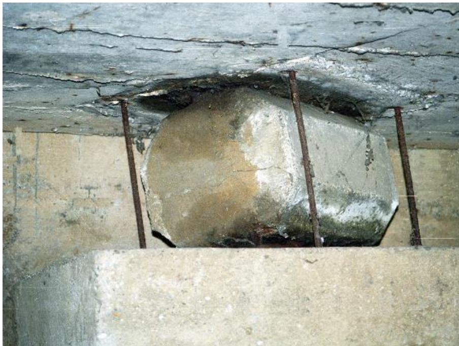
Slika 153: Betonsko valjčno ležišče – cepilne razpoke na bočni površini ležišča.
