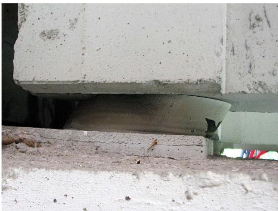
Slika 14: Ležišče vgrajeno preblizu roba ležiščne blazine. Na čelni kontaktni površini špranja med ležiščem in prekladno konstrukcijo. Ležišče ni vgrajeno horizontalno.
