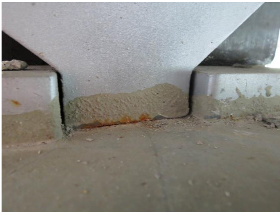
Slika 7: Nepravilna izvedba in vgradnja deformabilnega ležišča s pridrževalno konstrukcijo za preprečevanje pomikov v obeh horizontalnih smereh. Spodnja površina trna v kontaktu s podlago.
