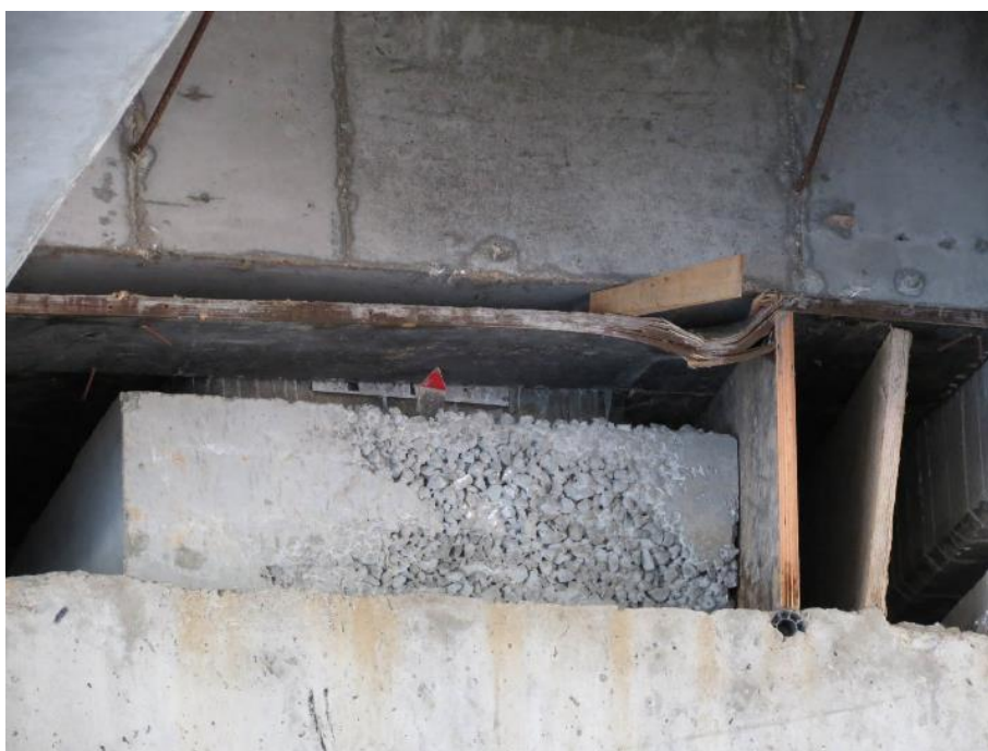
Slika 120: Porozen beton ležiščnega podstavka. Dršno ležišče vgrajeno prečno namesto v vzdolžni smeri.
