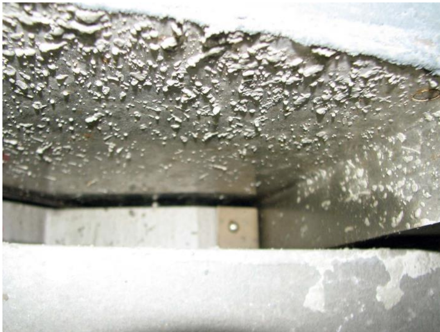
Slika 109: Umazana drsna površina z betonskim obrizgom.
