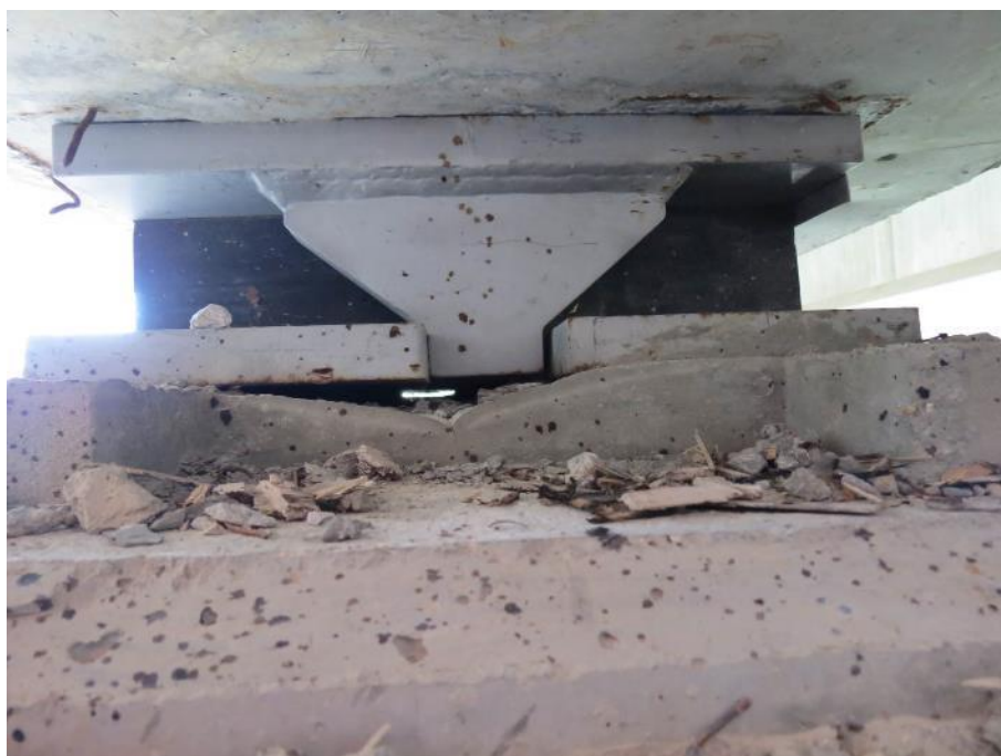
Slika 6: Nepodlita kontaktna površina spodnje ležišče plošče deformabilnega ležišča s pridrževalno konstrukcijo za preprečevanje pomikov v obeh horizontalnih smereh
