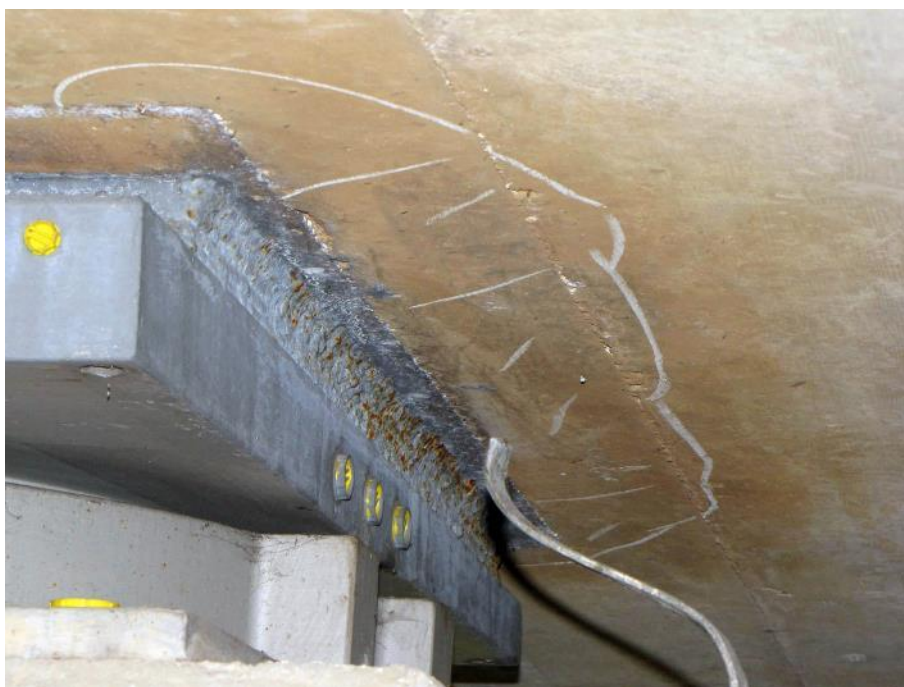
Slika 112: Delaminacija betona okoli sidrne in nad sidrno ploščo zaradi neustreznega varilnega postopka.
