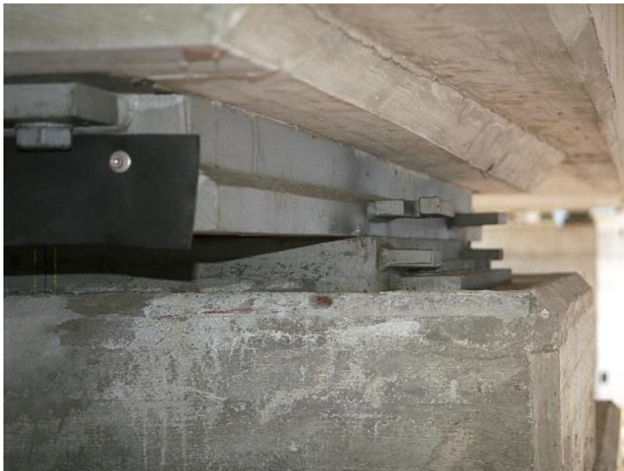
Slika 101: Bočno vodilo lončnega ležišča nasedlo na lonca zaradi neustreznega podlitja ležišča.
