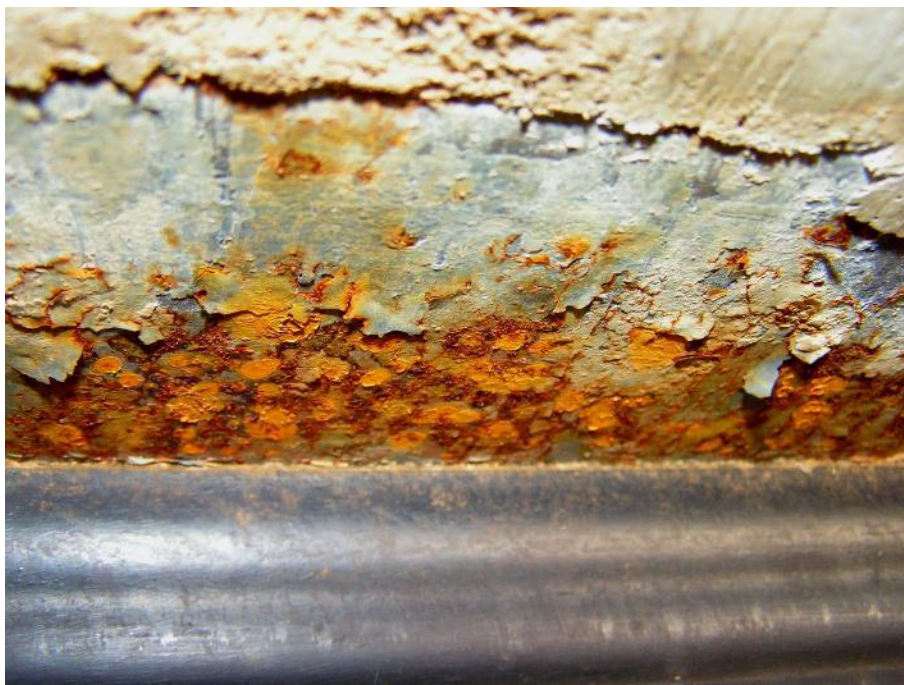
Slika 48: Korozija zgornje ležiščne plošče zaradi neustrezno izvedene protikorozijske zaščite.
