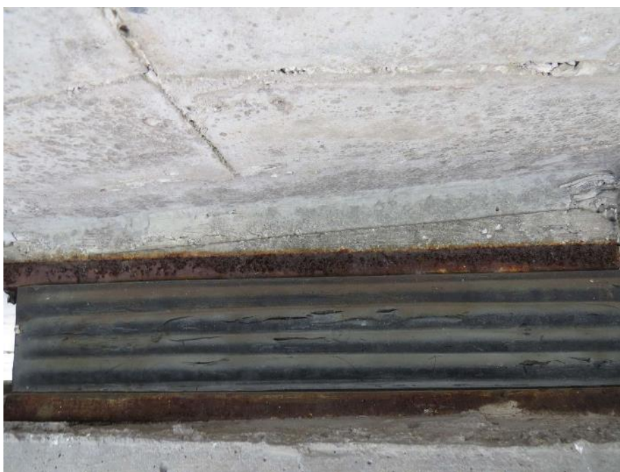
Slika 34: Neustrezne dimenzije ležiščnih plošč – plošče brez ustreznih previsov. Korozija ležiščnih plošč. Razpoke zaradi staranja in/ali lokalnih napetosti.
