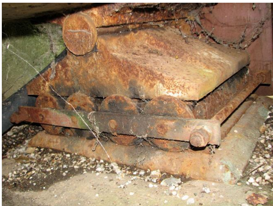
Slika 146: Več valjčno ležišče – korozija zaradi zamakanja.
