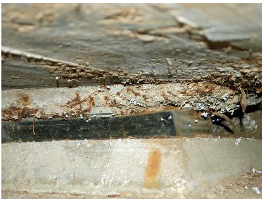
Slika 52: Neustrezno izdelana zgornja ležiščna blazina z ostanki žebeljev, žice in žaganja. Lokalno razpadanje ležiščne blazine.
