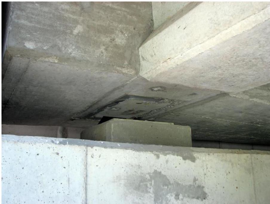
Slika 31: Izpadlo deformabilno drsno ležišče.
