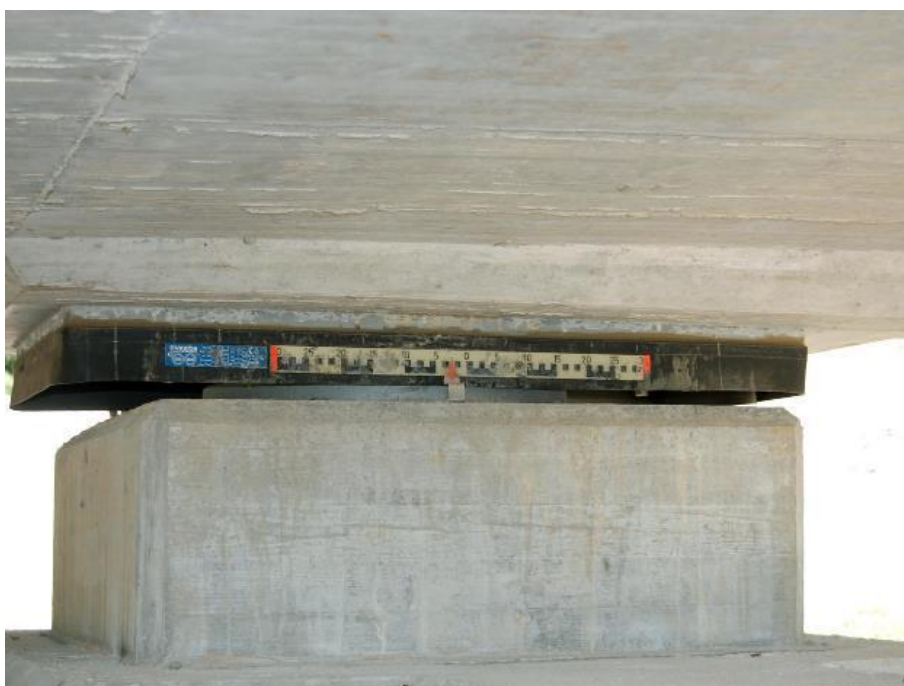
Slika 162: Velikost ležiščnega podstavka neustrezna z ozirom na velikost drsne plošče in premajhnega odmika drsne površine drsne plošče od zgornje površine ležiščnega podstavka.
