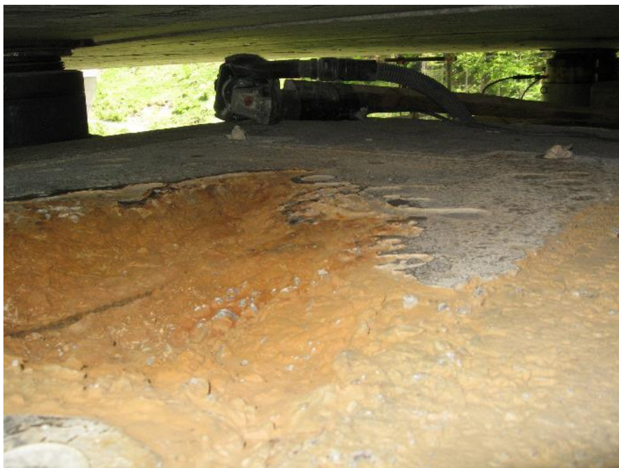
Slika 132: Depresija v betonskem podstavku zaradi napake pri podlivanju lončnega ležišča.
