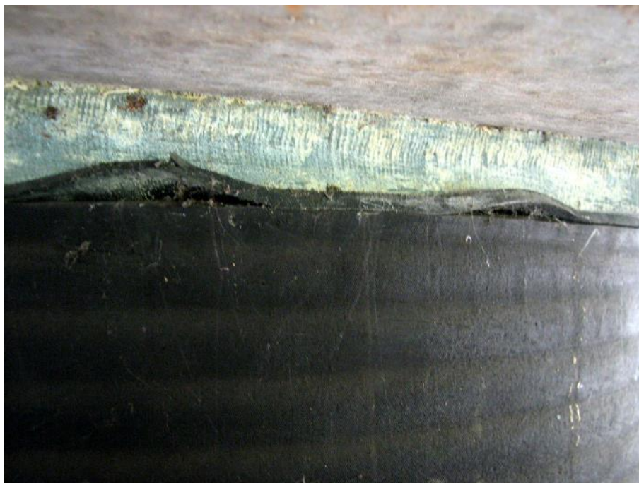
Slika 21: Odstopanje zgornjega krovnega sloja elastomerja zaradi preozke zgornje ležiščne plošče.
