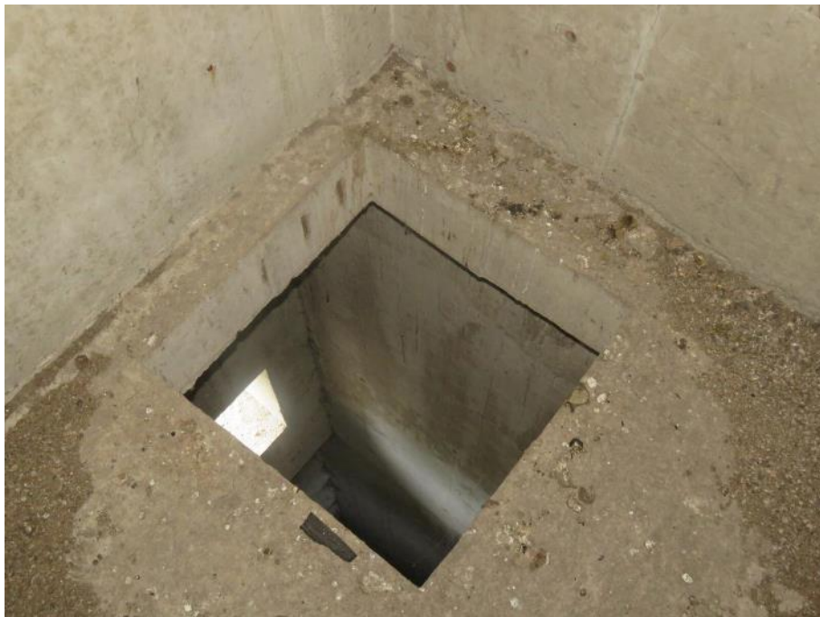
Slika 166: Nezaščitena dostopna odprtina na podest stebra. Površina podesta pokrita s ptičjimi iztrebki.
