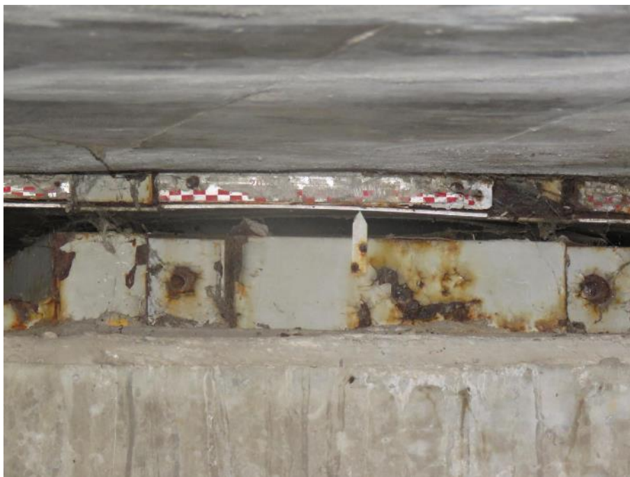
Slika 124: Deformirana drsna pločevina drsne plošče.
