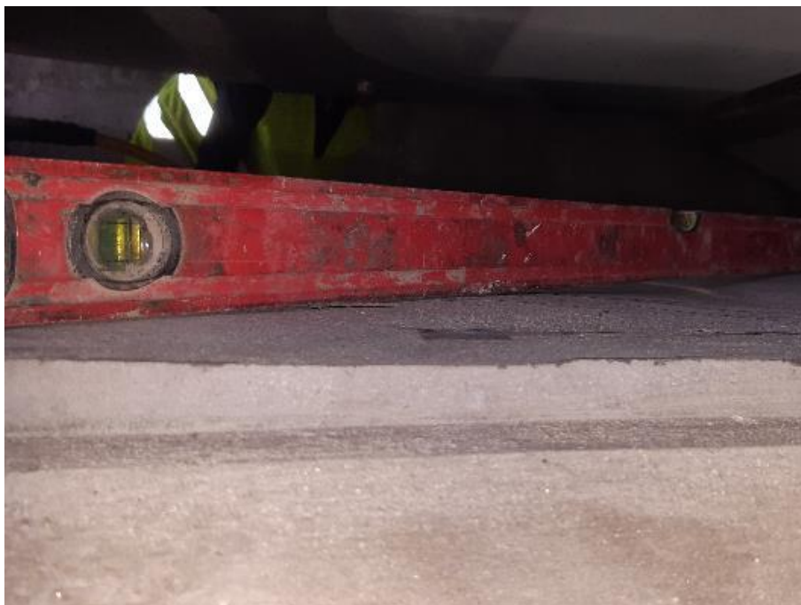
Slika 66: Neustrezno izvedeno podlivanje ležiščne plošče deformabilnega ležišča.
