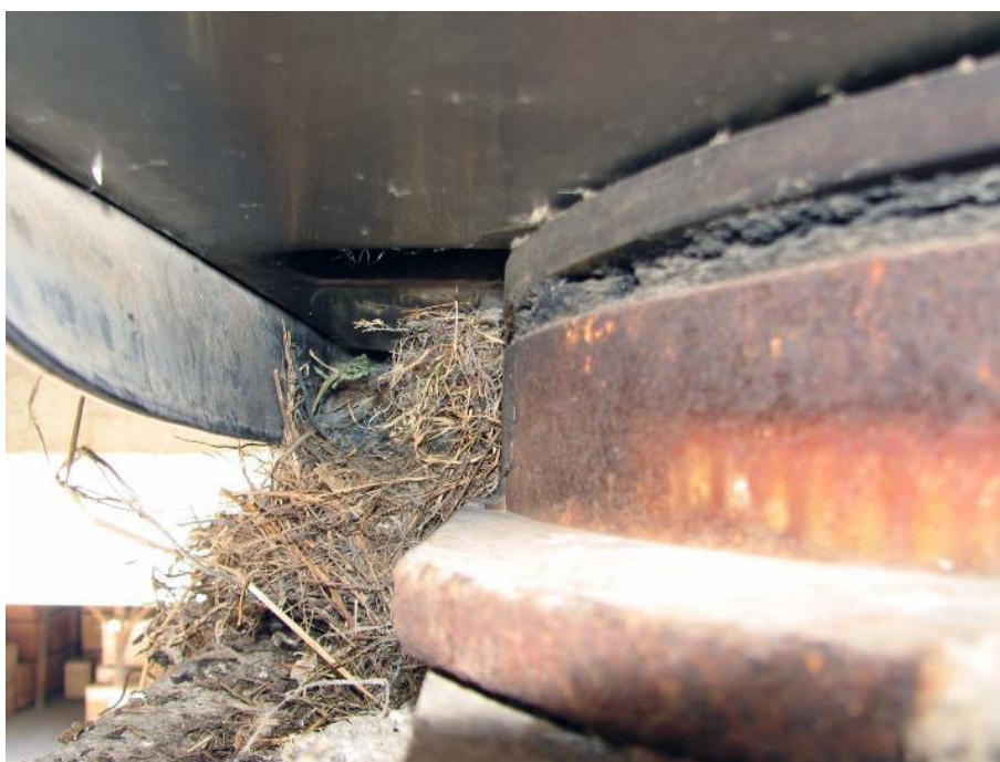
Slika 78: Neustrezno zaščitena drsna površina lončnega ležišča. Korozija lončnega ležišča. Razpokano in dotrajano tesnilo nagibne špranje.
