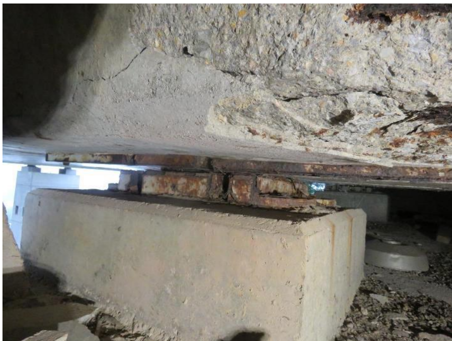
Slika 126: Korozija ležišča zaradi zamakanja skozi dilatacijo. Propadanje betona ob ležišču.
