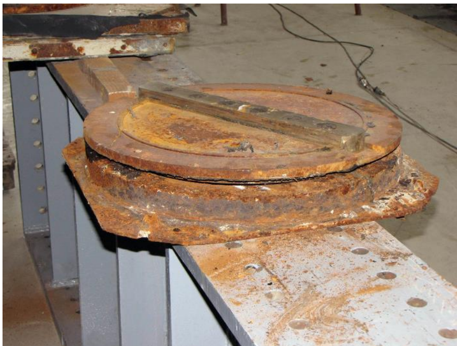
Slika 97: Korozija lončnega ležišča.
