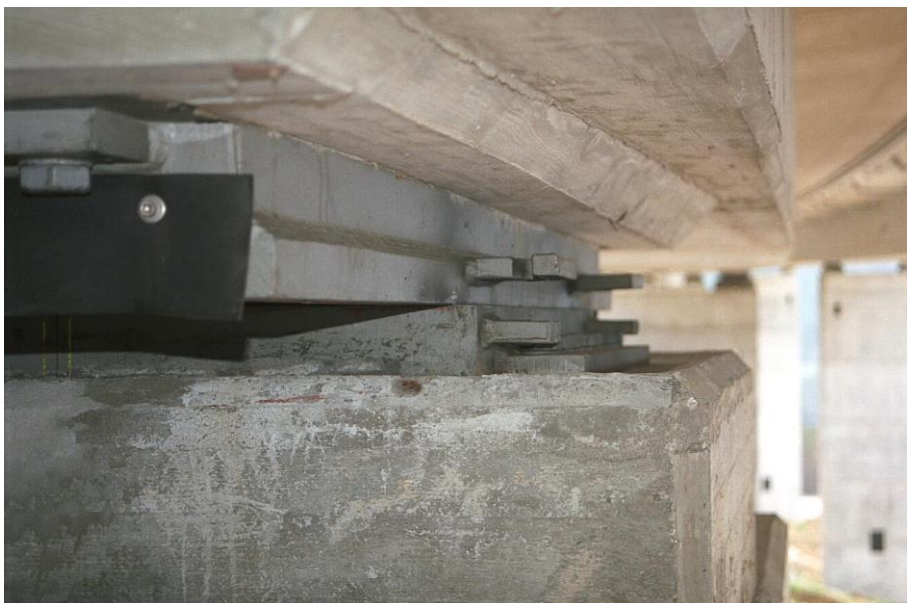
Slika 101: Bočno vodilo lončnega ležišča nasledlo na lonec zaradi neustreznega podlitja ležišča.
