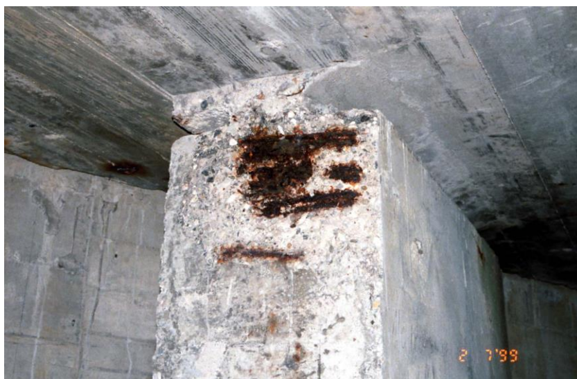
Slika 157: Lokalna delaminacija betona zaradi močne korozije armature nihajnega bloka betonskega členka.
