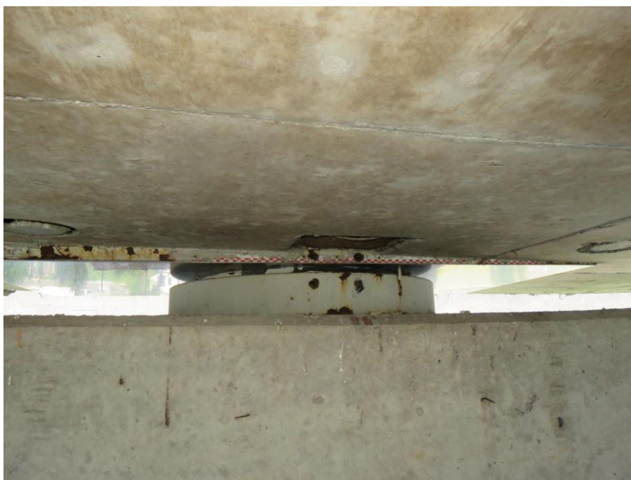
Slika 125: Nepravilno vgrajeno drsno ležišče, drsna plošča vgrajena v prekladno konstrukcijo.
