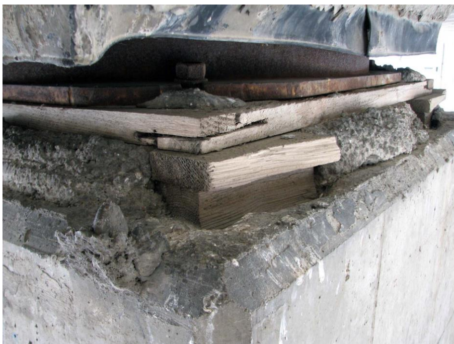
Slika 79: Neustrezno vgrajeno lončno ležišče.
