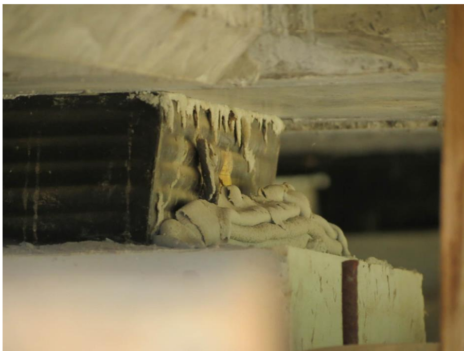
Slika 1: Umazana površina elastomernega ležišča. Neočiščena okolica ležišča. Nepravilna vgradnja ležišča (maltni stik med elastomernim blokom in prekladno konstrukcijo).
