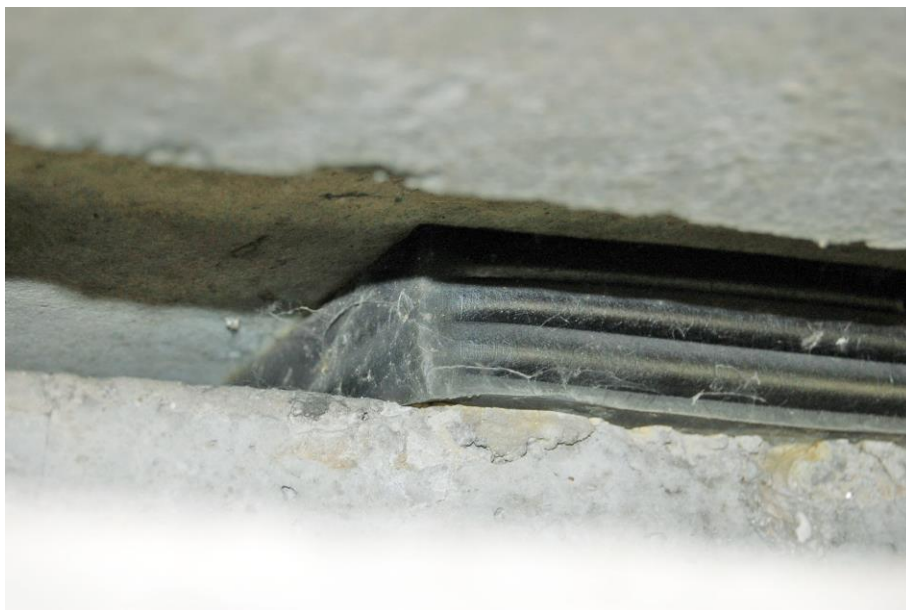
Slika 17: Nepravilna vgradnja elastomernega ležišča na rob ležiščne blazine. Prisotno zdrsavanje ležišča. Zaradi neenakomernega naleganja in velikih lokalnih robnih napetosti prisotne izrazite gube na čelni površini.
