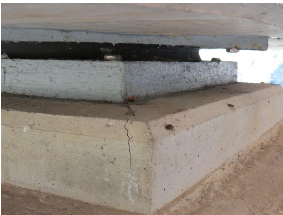
Slika 119: Strižna razpoka v betonskem ležiščnem podstavku.
