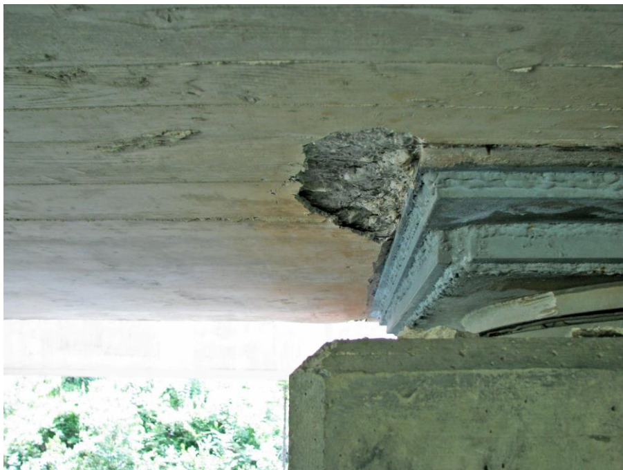
Slika 111: Delaminacija betona okoli sidrne in nad sidrno ploščo zaradi neustreznega varilnega postopka.
