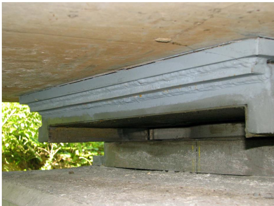
Slika 107: Nepodliti stik med loncem in betonskim podstavkom.
