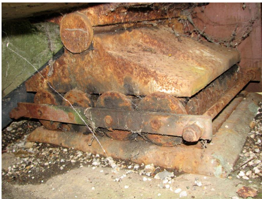
Slika 146: Več valjčno ležišče – korozija zaradi zamakanja.
