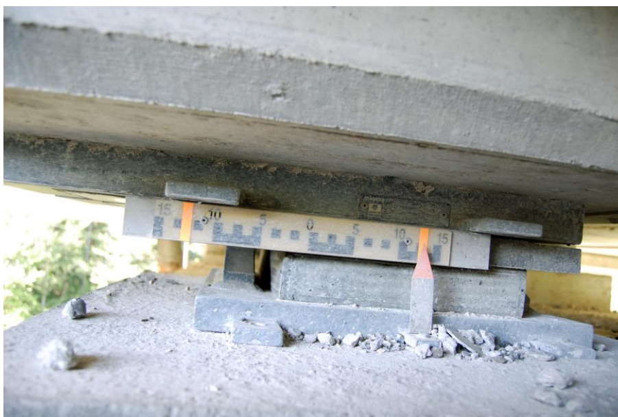
Slika 56: Prevelik pomik drsnega dela deformabilnega ležišča zaradi vgradnje ležišča v napačni smeri.
