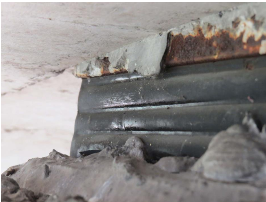
Slika 64: Pretanka debelina krovne plasti elastomerja.
