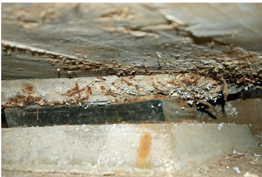
Slika 52: Neustrezno izdelana zgornja ležiščna blazina z ostanki žebeljev, žice in žaganja. Lokalno razpadanje ležiščne blazine.
