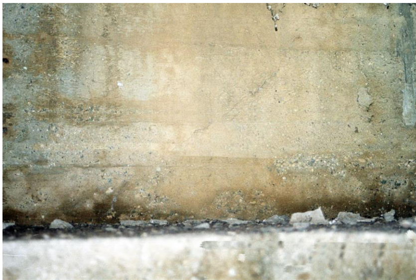
Slika 152: Betonsko valjčno ležišče – strižna razpoka.
