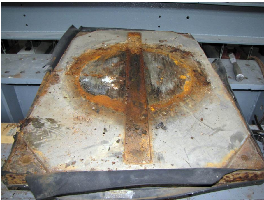
Slika 98: Korozijske poškodbe drsne plošče.
