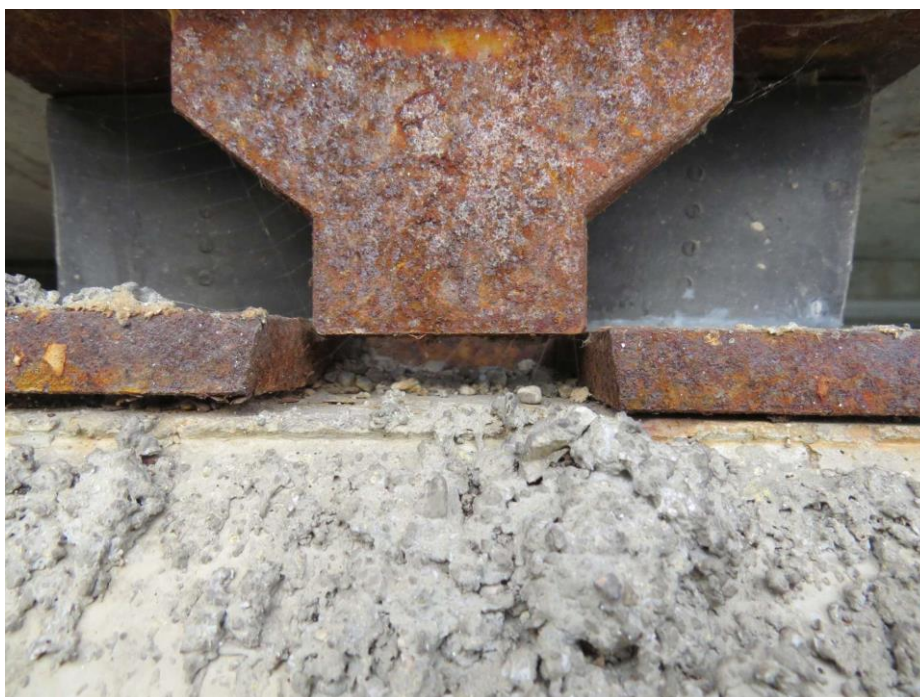
Slika 73: Korozija in deformacija jeklene pridrževalne konstrukcije elastomernega ležišča. Neustrezna izvedba – strižni trn je nad zgornjim robom spodnje ležiščne plošče.
