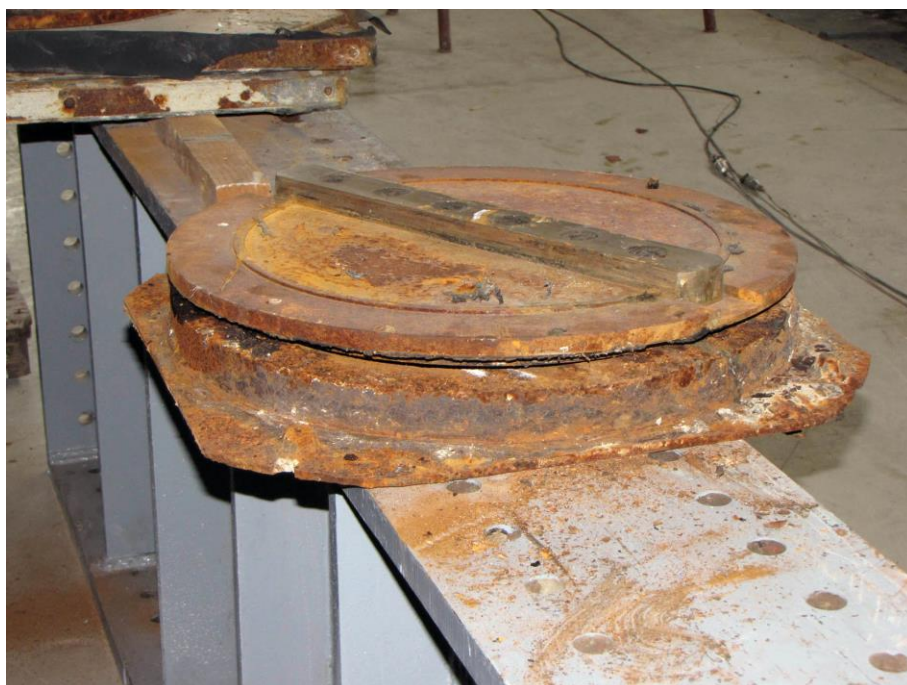
Slika 97: Korozija lončnega ležišča.
