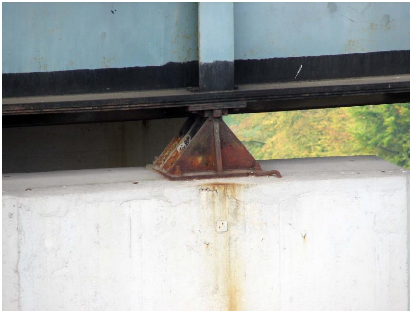
Slika 142: Linijsko nagibno ležišče – korozija.
