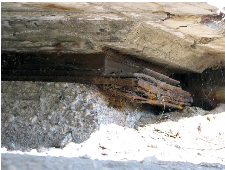
Slika 70: Močna korozija ležiščnih in podložnih plošč v stalnem vlažnem okolju zaradi netesne dilatacije. Propadanje ležiščne blazine.
