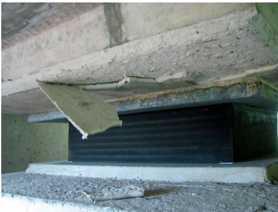
Slika 51: Nekvalitetno izveden zgornji ležiščni blok.
