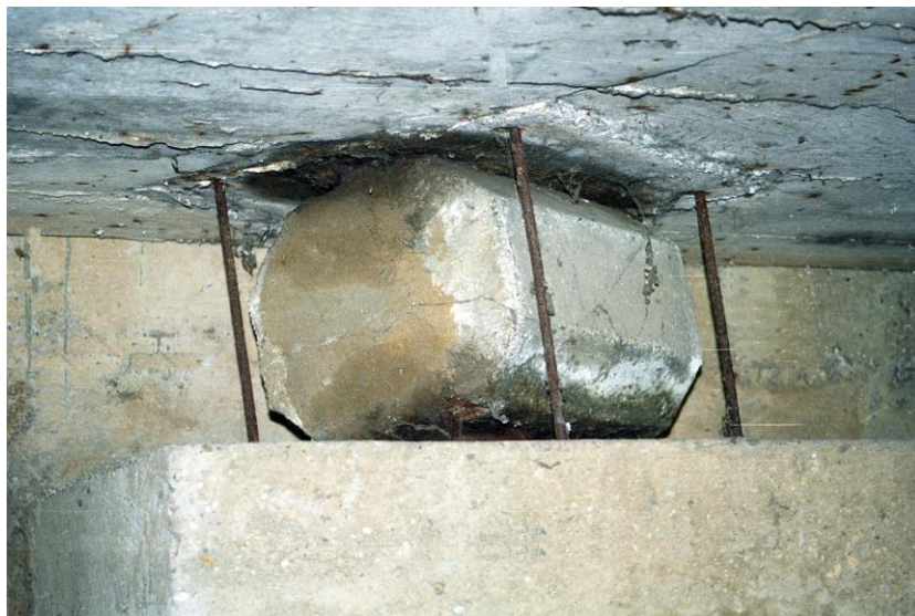
Slika 153: Betonsko valjčno ležišče – cepilne razpoke na bočni površini ležišča.
