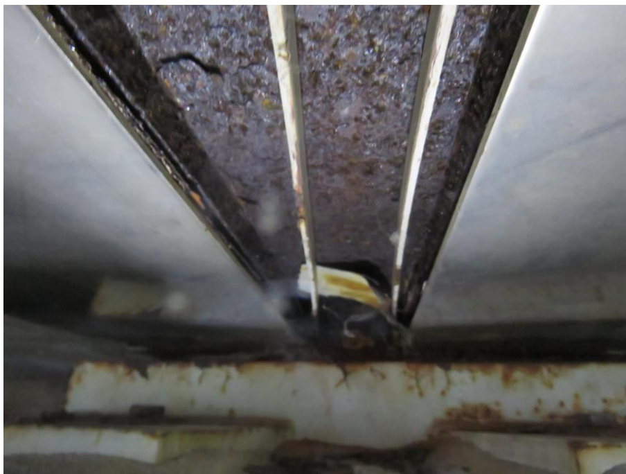
Slika 122: Korozija v utoru drsne plošče lončnega ležišča. Odstopanje drsnih parov (bočni drsni trak in bočna nerjavna pločevina) v utoru drsne plošče.
