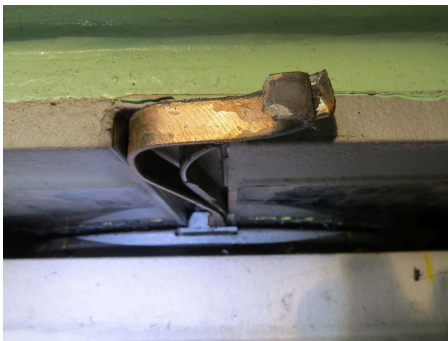
Slika 130: Iztiskanje bočnega drsnega traku in nerjavne pločevine centralnega vodila lončnega ležišča.
