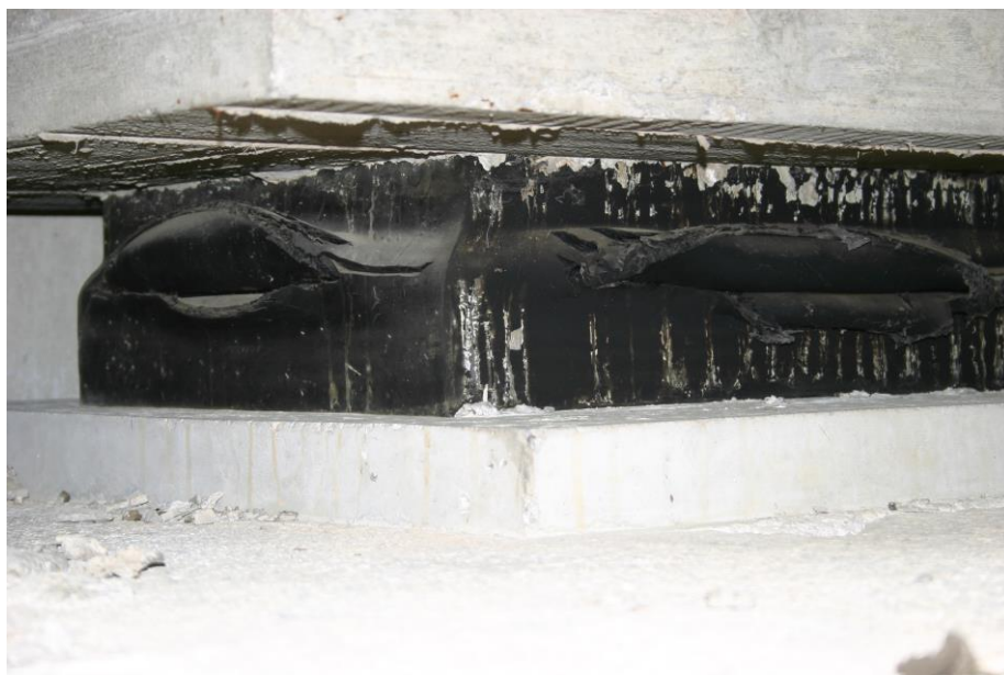
Slika 23: Razpoka na stiku med jekleno ploščo in elastomerjem zaradi neustreznega postopka vulkanizacije.
