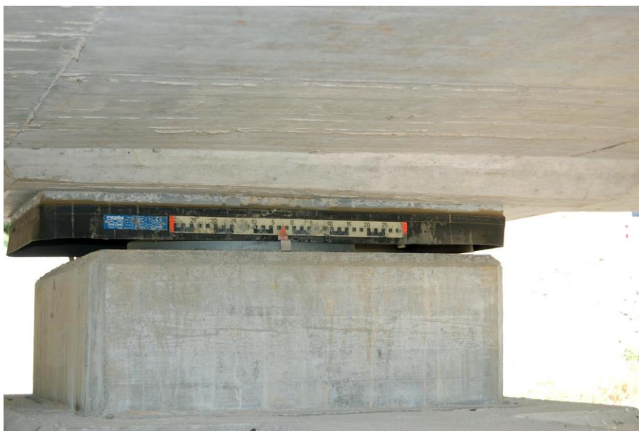
Slika 162: Velikost ležiščnega podstavka neustrezna z ozirom na velikost drsne plošče in premajhnega odmika drsne površine drsne plošče od zgornje površine ležiščnega podstavka.
