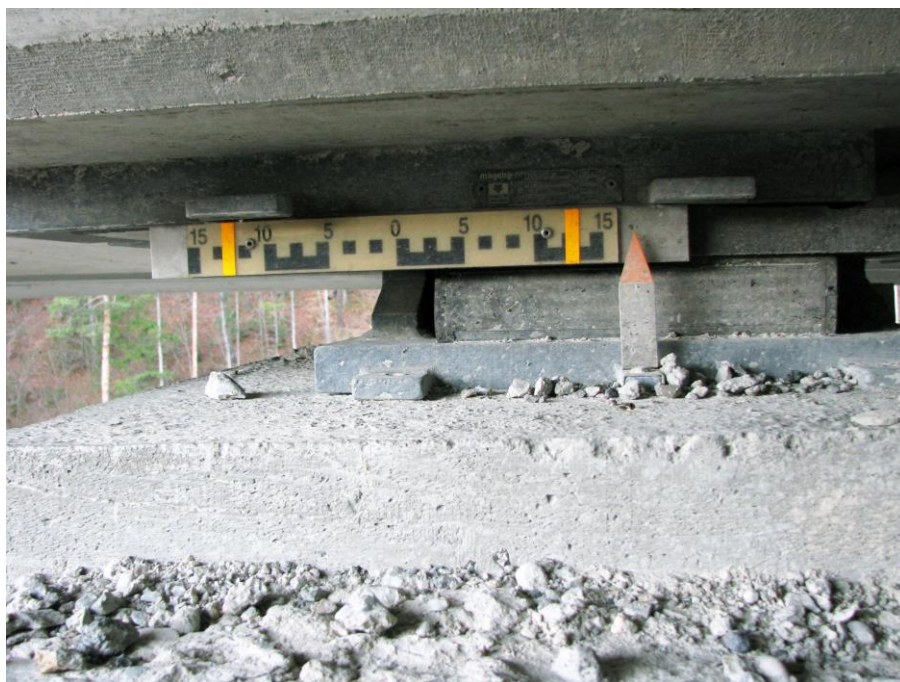
Slika 55: Prevelik pomik drsnega dela deformabilnega ležišča zaradi vgradnje ležišča v napačni smeri.
