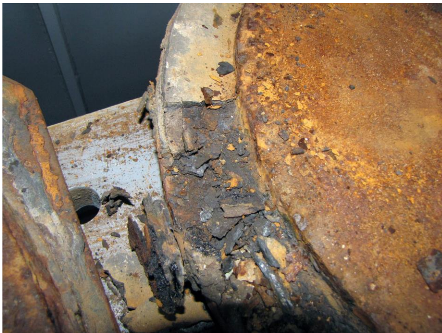
Slika 96: Korozijske poškodbe batnice - detajl.
