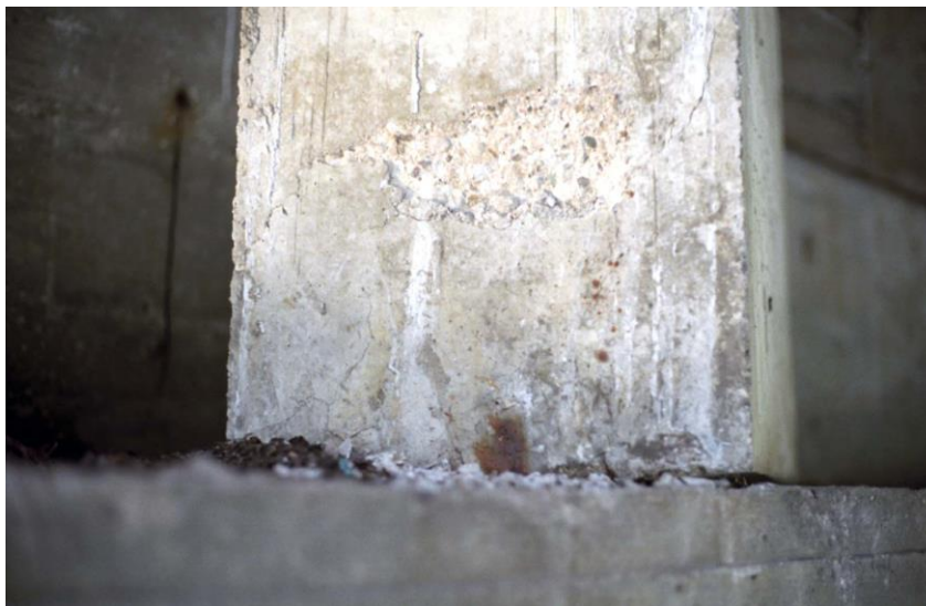
Slika 156: Lokalna delaminacija betona nihajnega bloka betonskega členka.
