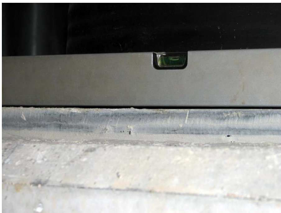
Slika 63: Deformirana spodnja ležiščna plošča elastomernega ležišča.
