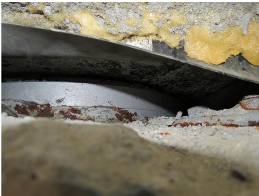
Slika 121: Lokalna korozija na mestu poškodb protikorozijske zaščite, ki so nastale ob vgrajevanju ležišča.
