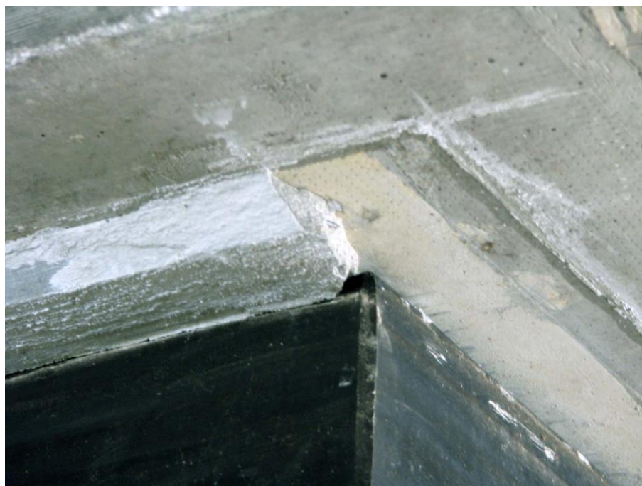
Slika 44: Odlom zgornjega venca zaradi zdrsavanja ležišča. Nepravilna izvedba.
