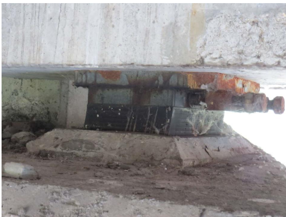
Slika 71: Korozija jeklene konstrukcije elastomernega ležišča z mehanizmom za ponastavitev ležišča.
