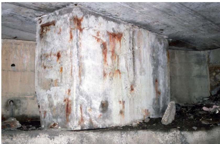
Slika 155: Zamakanje, korozija armature in lokalna delaminacija betona nihajnega bloka betonskega členka.
