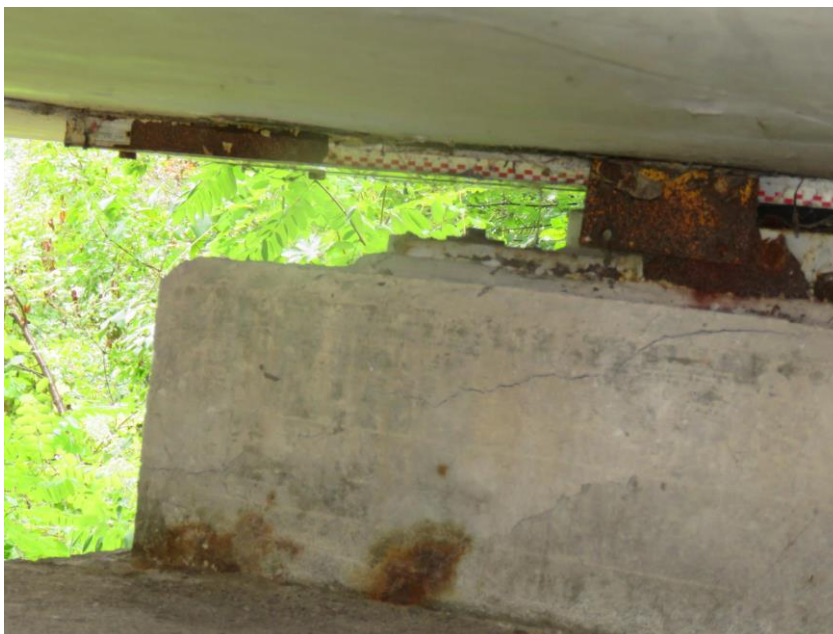
Slika 159: Strižna razpoka v betonskem ležiščnem podstavku.
