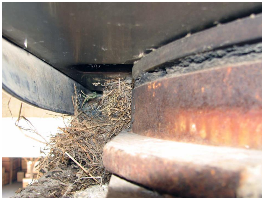
Slika 78: Neustrezno zaščitena drsna površina lončnega ležišča. Korozija lončnega ležišča. Razpokano in dotrajano tesnilo nagibne špranje.
