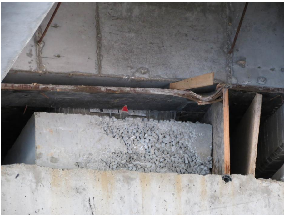
Slika 120: Porozen beton ležiščnega podstavka. Drsno ležišče vgrajeno prečno namesto v vzdolžni smeri.
