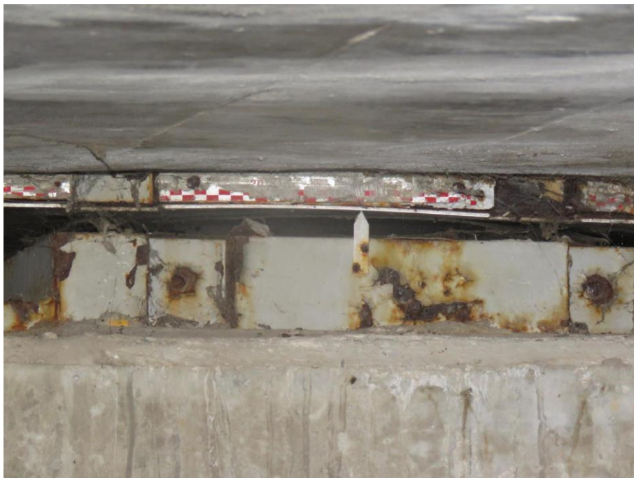
Slika 124: Deformirana drsna pločevina drsne plošče.
