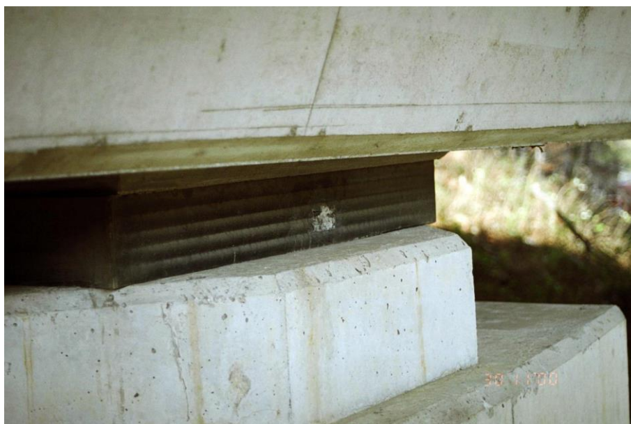
Slika 61: Nepravilna zamenjava oblike deformabilnega ležišča po že izvedenem ležiščnem podstavku.
