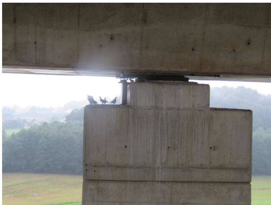
Slika 165: Ležišče nezaščiteno pred dostopom ptic. Ležiščna polica nezavarovana pred padcem v globino. Zaradi dimenzij betonskega podstavka je meritve ležišča možno izvajati le na notranji strani ležišča.
