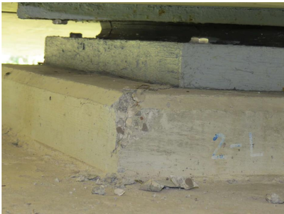
Slika 118: Strižna razpoka v betonskem ležiščnem podstavku.
