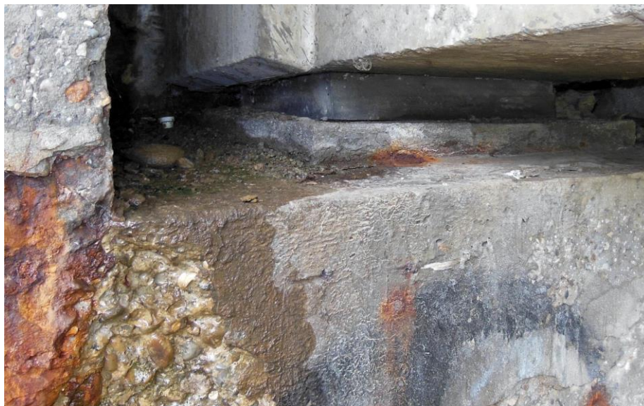
Slika 74: Stalno vlažno okolje zaradi netesne dilatacije. Propadanje ležiščne blazine.
