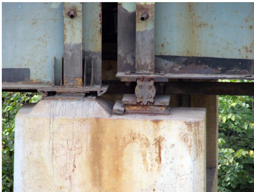
Slika 144: Enojno valjčno ležišče – korozija.
