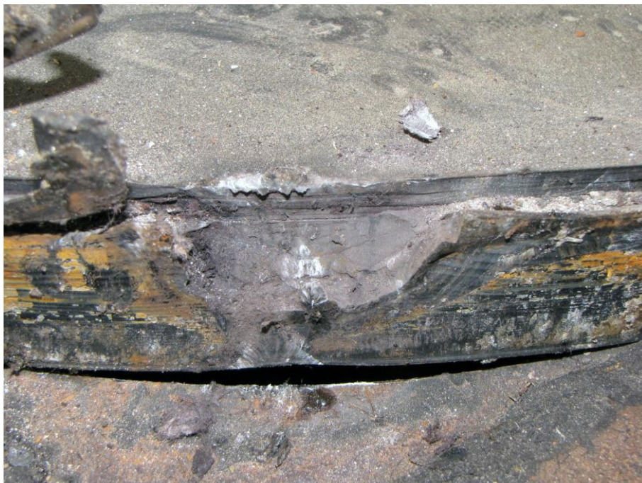
Slika 88: Lokalna poškodba elastomerne blazine na mestu iztiskanja.
