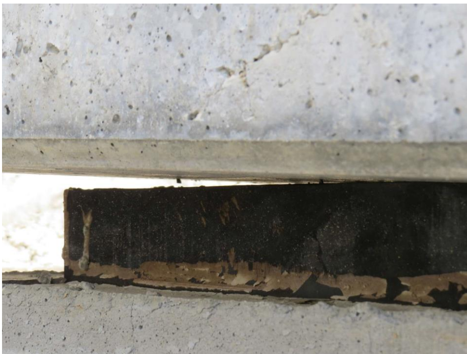
Slika 60: Neustrezna in nepravilna vgradnja elastomernega ležišča pod betonskim montažnim nosilcem. Ležišče zalito v podlivno malto. Povezava ležišča z montažnim nosilcem ni bila rešena.
