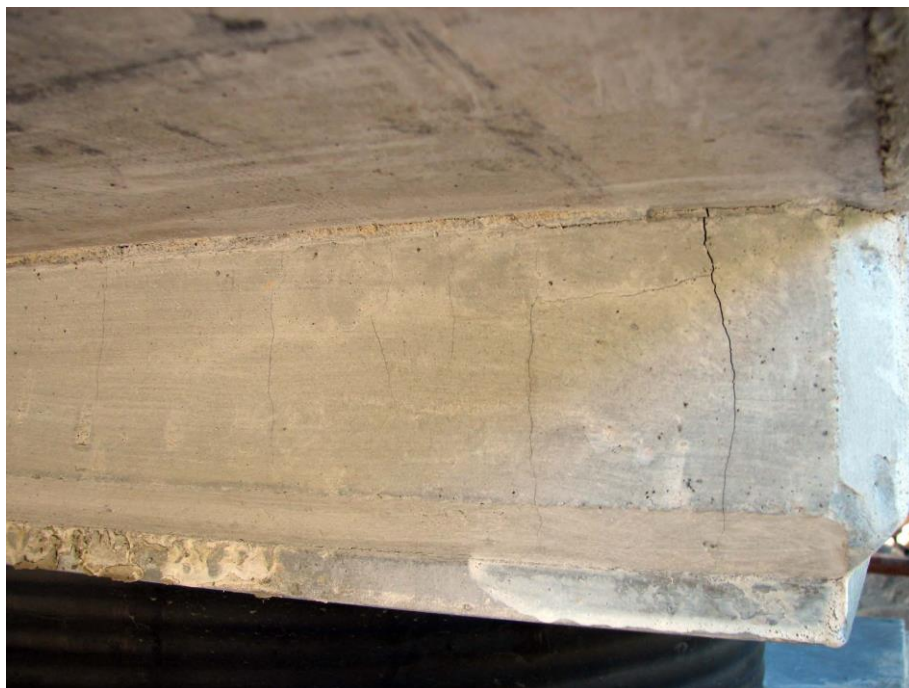
Slika 62: Razpoke v podlivni malti med zgornjo ležiščno ploščo in prekladno konstrukcijo.
