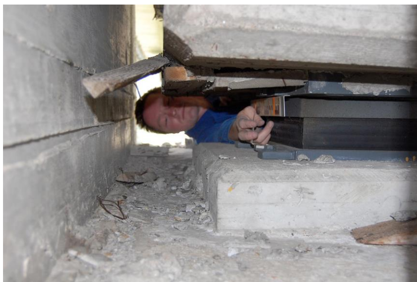
Slika 161: Kazalec pomikov in merilna skala vgrajena na napačni strani ležišča. Zaradi premajhnega razmika me ležiščem in parapetnim zidom je težko dovolj natančno oziroma je nemogoče odčitati velikost pomika.
