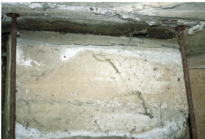
Slika 151: Betonsko valjčno ležišče – delaminacija betona na vrhu ležišča.
