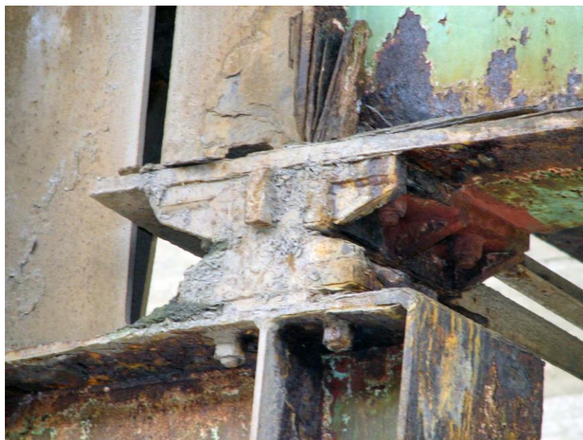
Slika 143: Linijsko nagibno ležišče – močna korozija in siganje.
