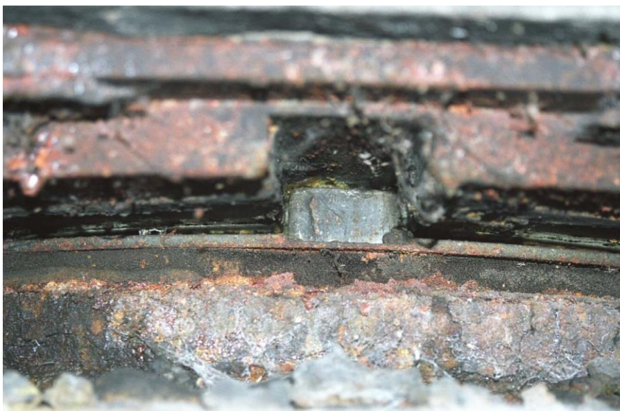
Slika 108: Korozija lončnega ležišča zaradi stalne prisotnosti vlage in umazanije na ležiščni polici.
