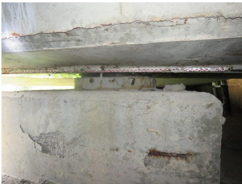
Slika 160: Delaminacija betona ležiščnega podstavka zaradi korozije armature.
