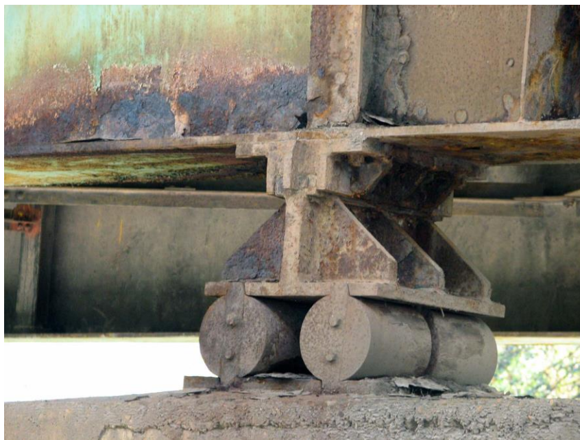
Slika 145: Dvojno valjčno ležišče – korozija zaradi zamakanja.
