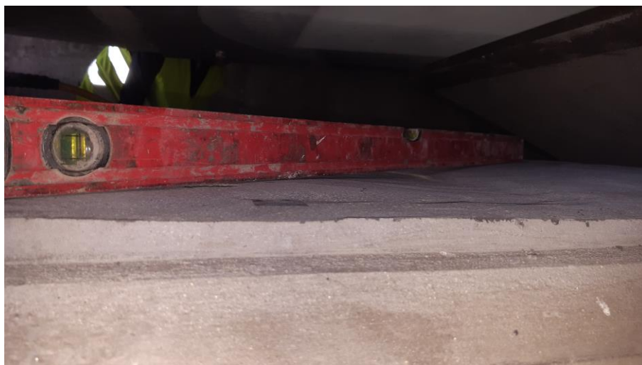
Slika 66: Neustrezno izvedeno podlivanje ležiščne plošče deformabilnega ležišča.
