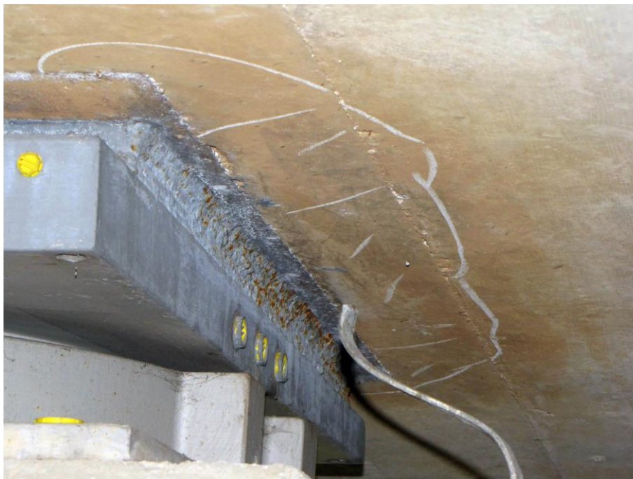
Slika 112: Delaminacija betona okoli sidrne in nad sidrno ploščo zaradi neustreznega varilnega postopka.
