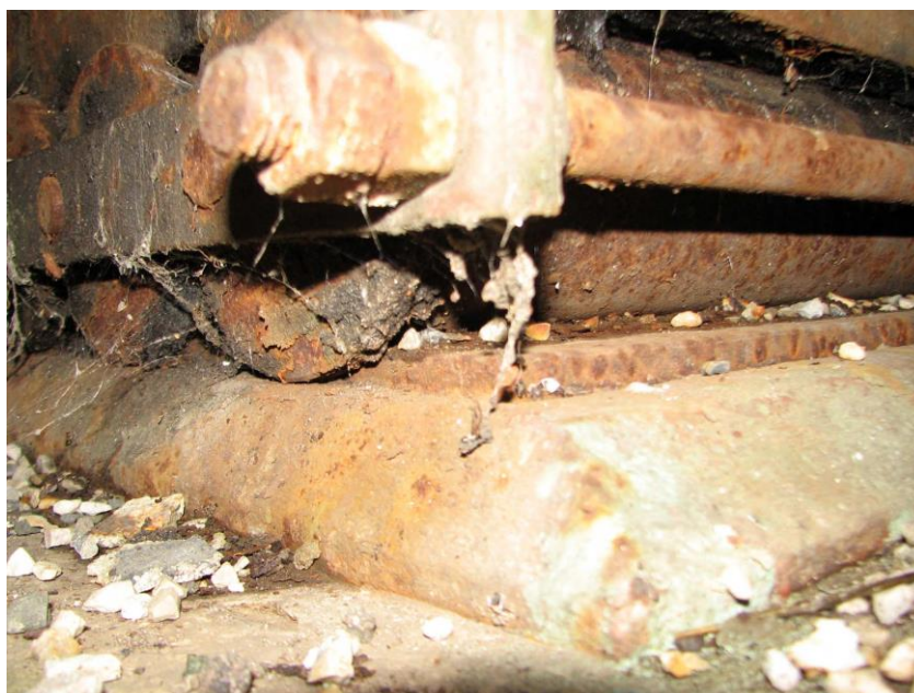
Slika 147: Več valjčno ležišče – nečista kotalna površina.
