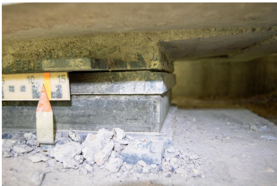
Slika 57: Prevelik pomik drsnega dela deformabilnega ležišča zaradi vgradnje ležišča v napačni smeri.
