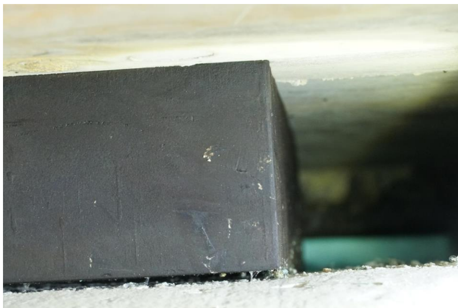
Slika 53: Neustrezno izvedena podlaga ležiščne police za elastomerno ležišče. Špranja globoka več kot 10 cm in na obodu široka 3,3 mm.
