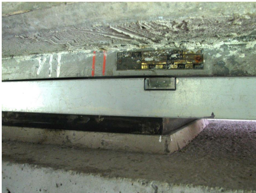
Slika 135: Deformacija drsne plošče.
