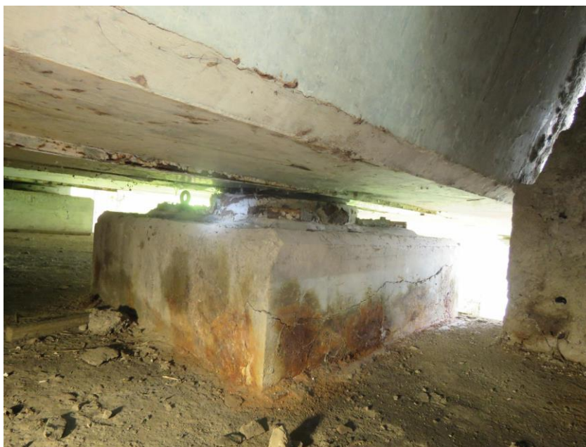
Slika 158: Strižna razpoka v betonskem ležiščnem podstavku. Razpadanje betona zaradi korozije armature. Ležiščna polica v stalni vlagi zaradi netesne dilatacije.
