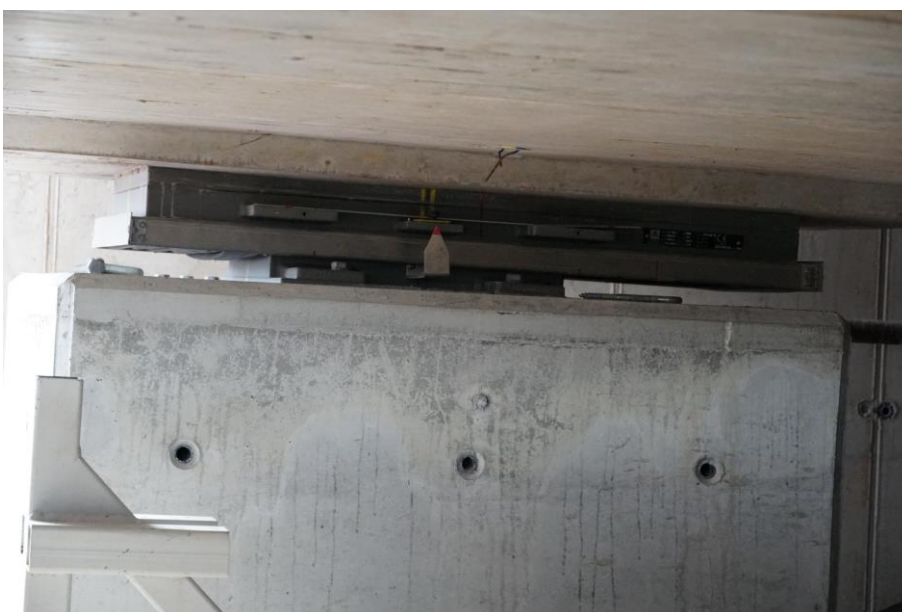
Slika 163: Velikost ležiščnega podstavka neustrezna z ozirom na velikost drsne plošče in premajhnega odmika drsne površine drsne plošče od zgornje površine ležiščnega podstavka.
