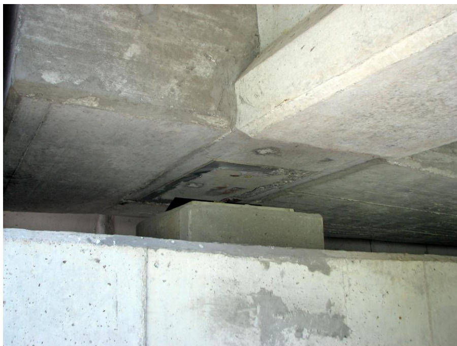
Slika 31: Izpadlo deformabilno drsno ležišče.
