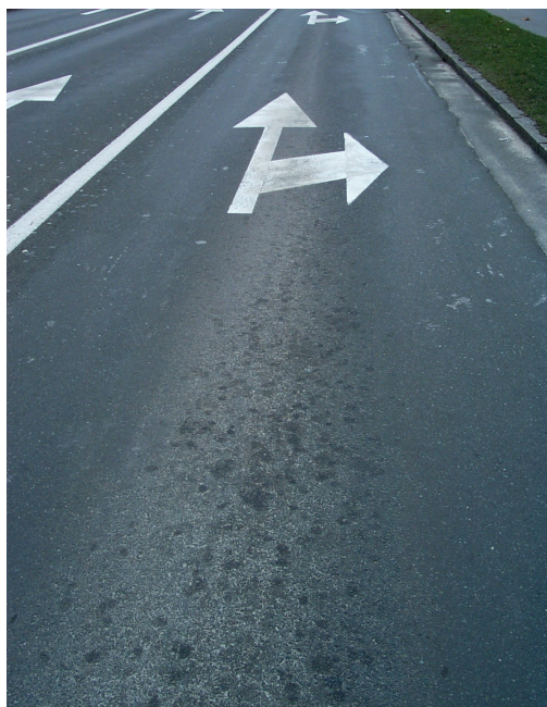
Slika 16: Mehčanje vgrajene asfaltne zmesi zaradi derivatov nafte med kolesnicama
