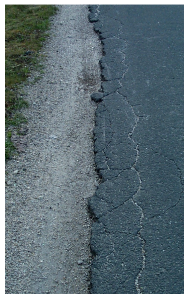
Slika 9: Razgraditev asfaltna zmesi – krušenje roba
