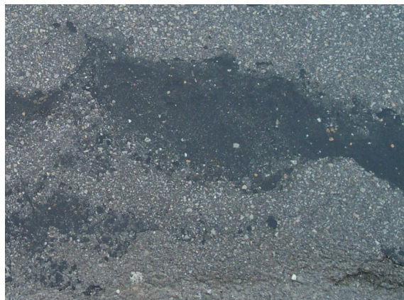
Slika 14: Zmanjšanje torne sposobnosti zaradi iztisnjene bitumenske malte
