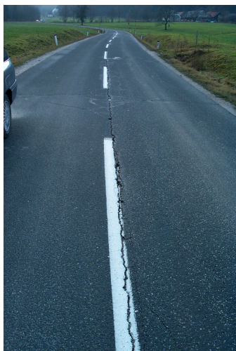
Slika 3: Razpoka na vzdolžnem delovnem stiku
