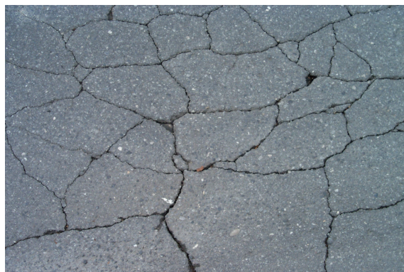
Slika 4: Razpoke zaradi spremenjenih materialov v podlagi
