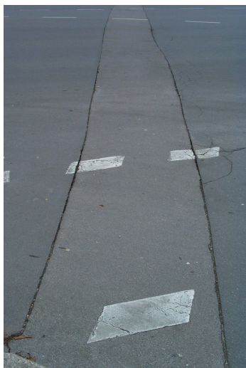
Slika 1: Razpoke na stikih različnih asfaltnih zmesi
