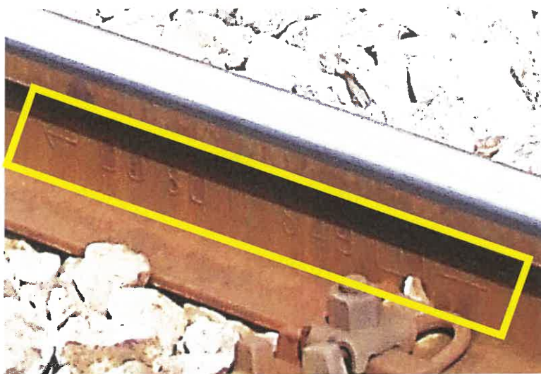
Slika št. 12: Z rumenim pravokotnikom je označena označba tirnice, ki je vgrajena na tem odseku proge št. 10.
