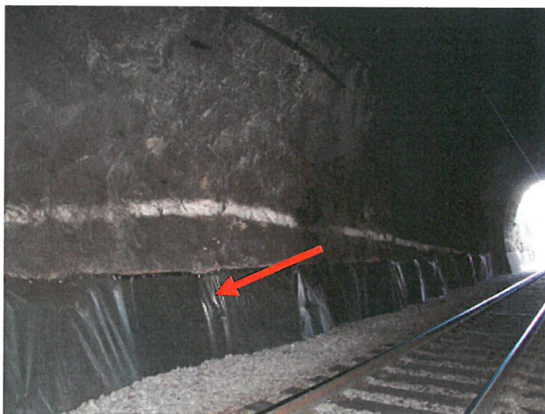
Slika št. 56: Rdeča puščica prikazuje zaščitno prevleko – platno, ki preprečuje pronicanje nevarnih snovi pod spodnji ustroj proge
