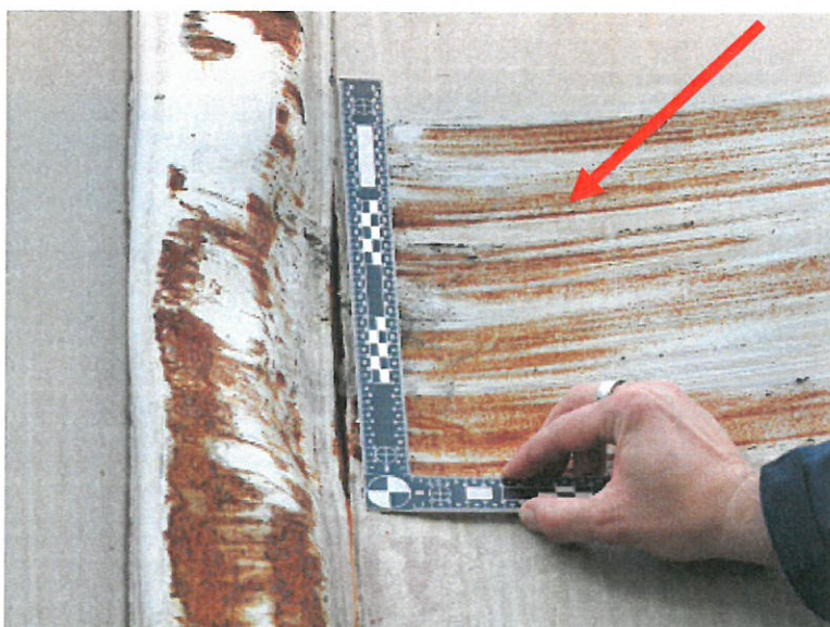
Slika št. 58: Rdeča puščica prikazuje razpoko plašča cisterne na varu spoja pločevine
