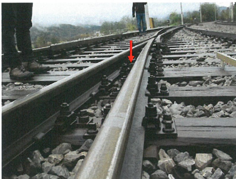
Slika št. 13: Rdeča puščica prikazuje poškodbo glave pritrdilnega vijaka za pritrditev tirnice na podložno ploščo, ki je nastala ob iztirjenju levega kolesa druge osi prvega podstavnega vozička 16. vagona v vlaku 40851
