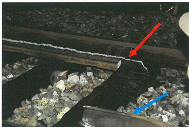
Slika št. 7: Rdeča puščica prikazuje zlomljano glavo od vratu tirnice neposredno pred mestom na katerem je zavarjena leva ostrica kretnice št. 5 postaje Zidani Most, modra puščica pa prikazuje levo odlomljeno ostrico
