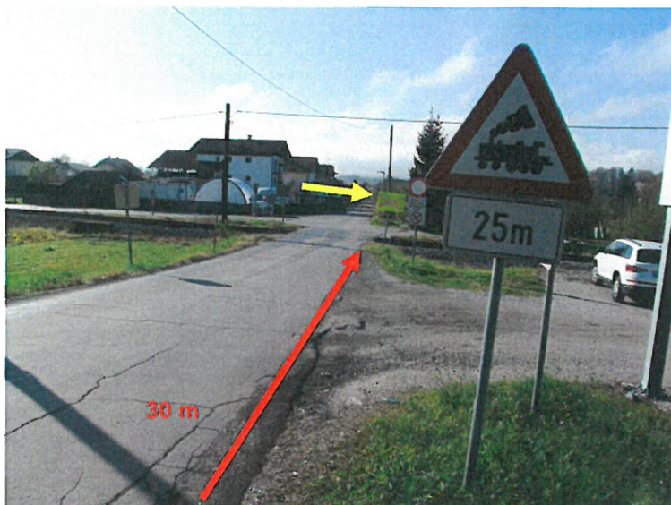
Slika št. 10: Rdeča puščica prikazuje razpoložljiva dolžina ceste od križišča z Dolensko cesto do meje nevarnega območja nivojskega prehoda, rumena puščica pa je usmerjena na cestno prometni znak »Andrejev križ«.
