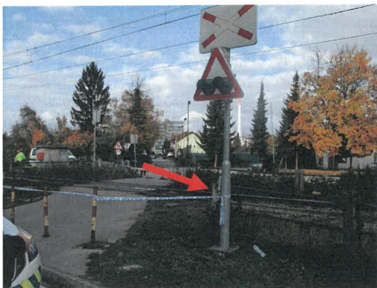
Slika št. 2: Rdeča puščica prikazuje dotrajano ograjo ob progi
