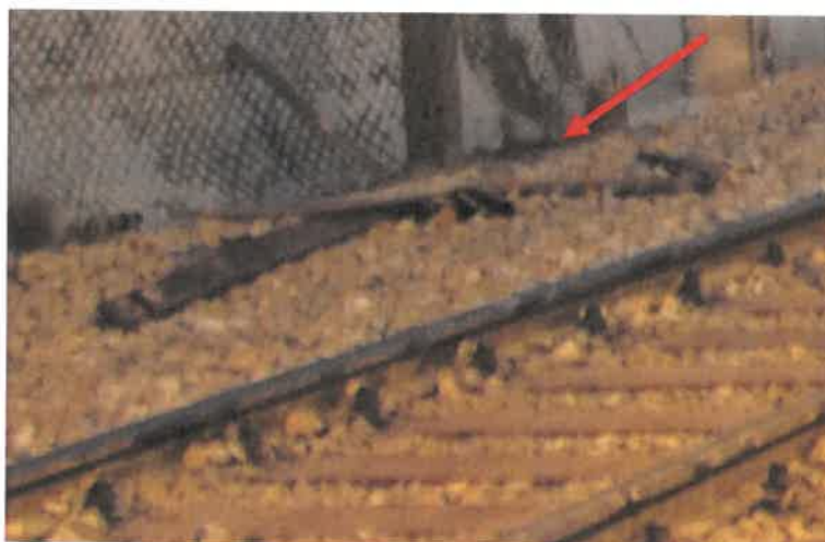
Slika št. 3: Rdeča puščica prikazuje deske iz katerih so delavci izdelali priročno orodje za poravnavanje peska
