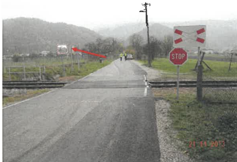
Slika št. 7: Rdeča puščica prikazuje cestno ogledalo, ki ne sodi na nivojski prehod, ker je lahko zavajajoče.
