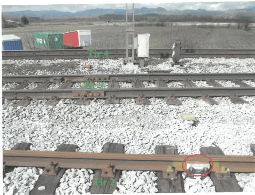
Slika št. 3: Prikazuje z rdečim krogom obkrožen števec osi, signalno – varnostne naprave ILTIS, ki ob navozu osi tirnega vozila onemogoča vsakršno nadaljnjo prestavitev kretnic na celotnem kretniškem območju, ki ga ta števec krije, v našem primeru »B« stran postaje Preserje
