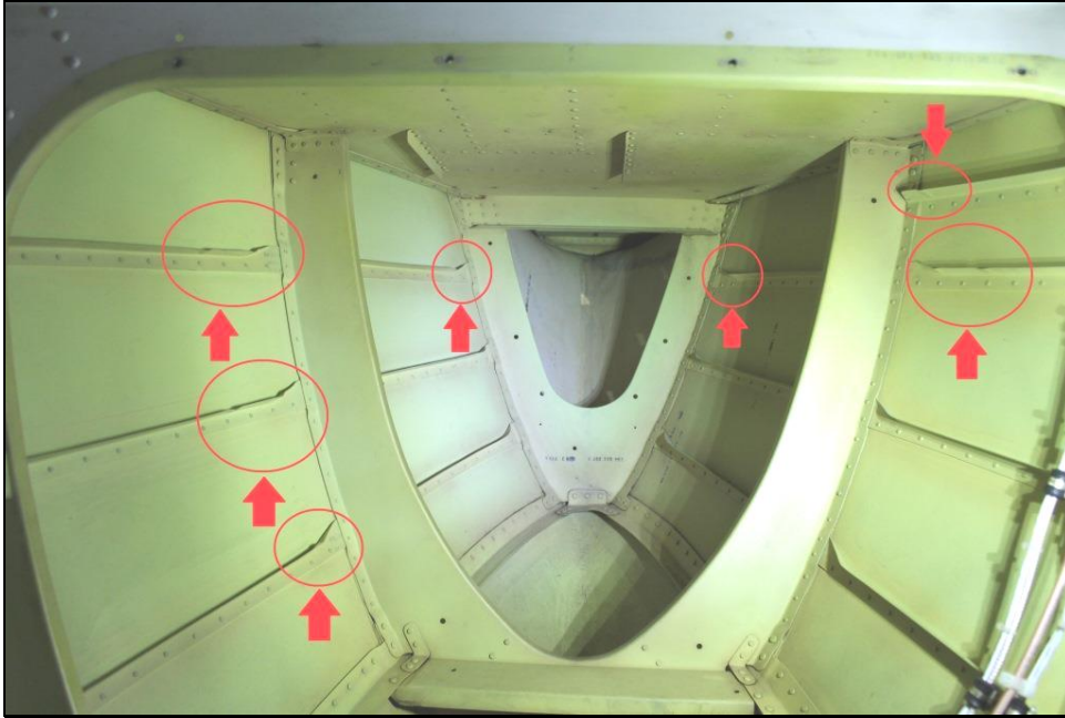
Slika 8: Poškodbe notranjih konstrukcijskih elementov-vzdolžnih nosilcev repnega konusa (vitalni deli helikopterja)
