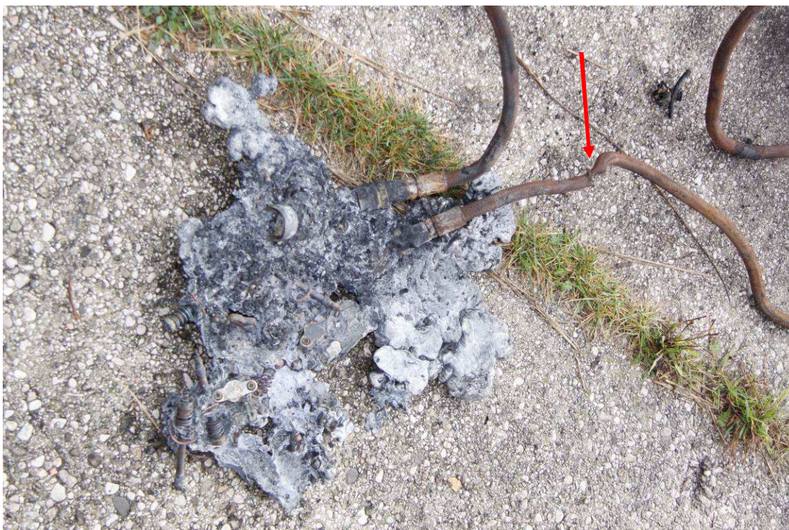
Slika 60: Prikaz poškodovanih cevi plinske instalacije pri gorilniku
