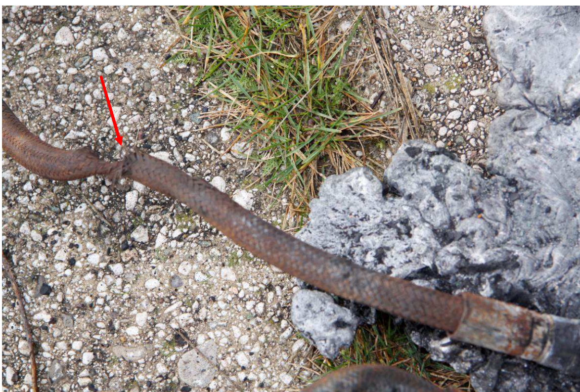
Slika 61: Prikaz poškodovane cevi plinske instalacije pri gorilniku
