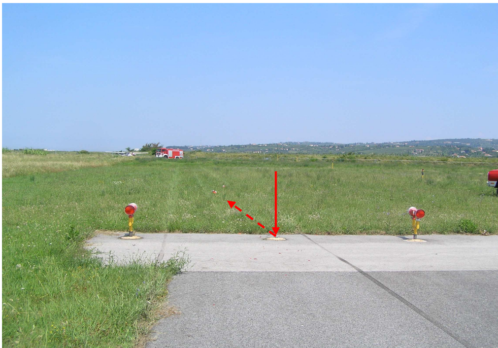
Slika 7. Poškodba luči vzletno pristajalne steze
