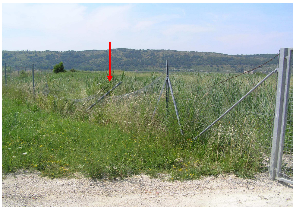
Slika 8. Poškodbe zaščitne ograje letališča
