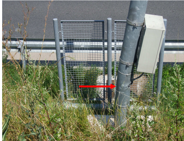
Poškodba spodnjega dela droga
