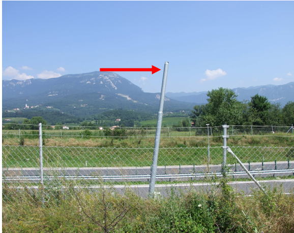
Poškodba zgornjega dela droga
