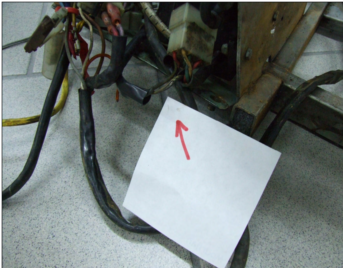
Slika 1. Dotik poškodovane izolacija žice ob nosilec je bil vzrok za prekinitev tokokroga enega sistema vžiga
