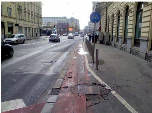
Slika 98: Primeri poškodb zgornjega ustroja na kolesarskih povezavah
