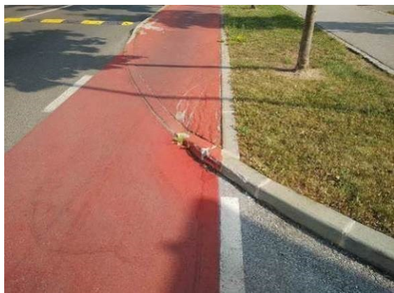
Slika 6: Neprimerno zaključena klančina robnika na kolesarski stezi (Lep et al.)
