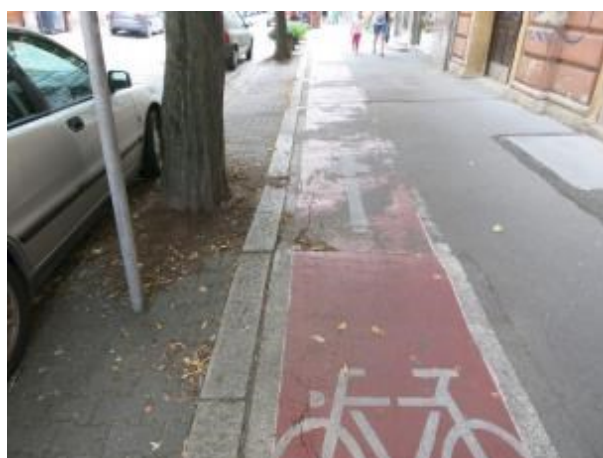
Slika 100: Primer poškodb zgornjega ustroja na kolesarskih povezavah
