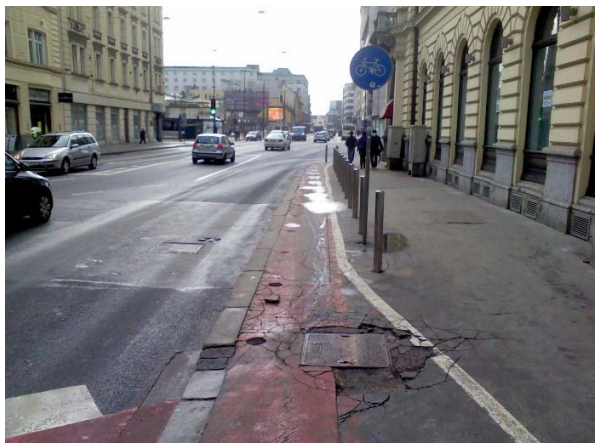
Slika 98: Primeri poškodb zgornjega ustroja na kolesarskih povezavah
