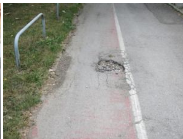
Slika 101: Slabo vzdrževana barva in zgornji ustroj
