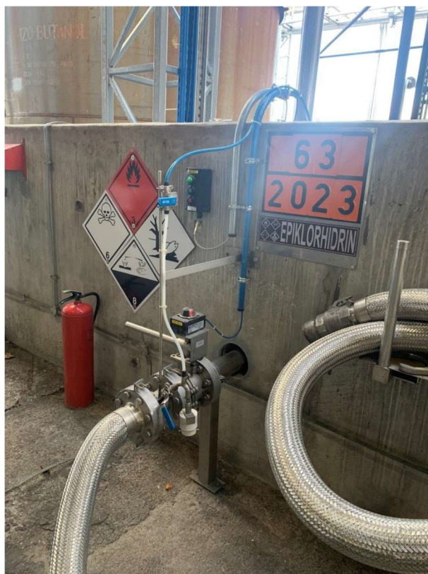
Slika 6: Fotografija pretakalnega mesta za epiklorohidin.
