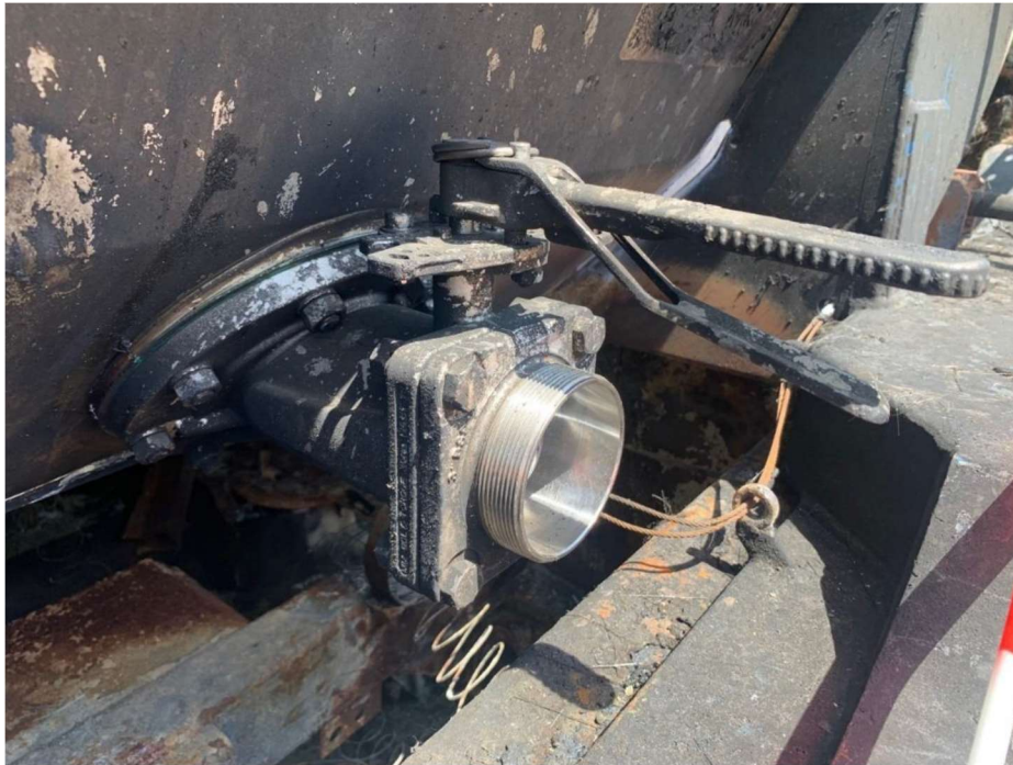
Slika 8: Fotografija navojnega priključka dimenzije DN80 na ISO kontejnerju za Epiklorohidin po dogodku 12. 5. 2022. Vir: Melamin. Vir: Poročilo Melamin/IJS/SIQ
