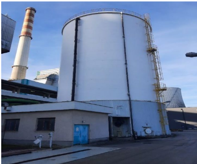
Slika 4: Pogled na obstoječi rezervoar in črpališče, kjer je predvidena postavitev novega zalogovnika
