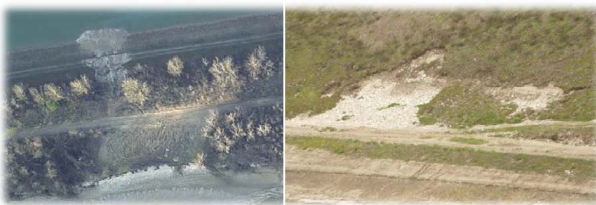
Slika 30: Delna porušitev nasipa z nepoškodovano krono (levo) in precejanje skozi vkop (desno), (DEM, 2012)
