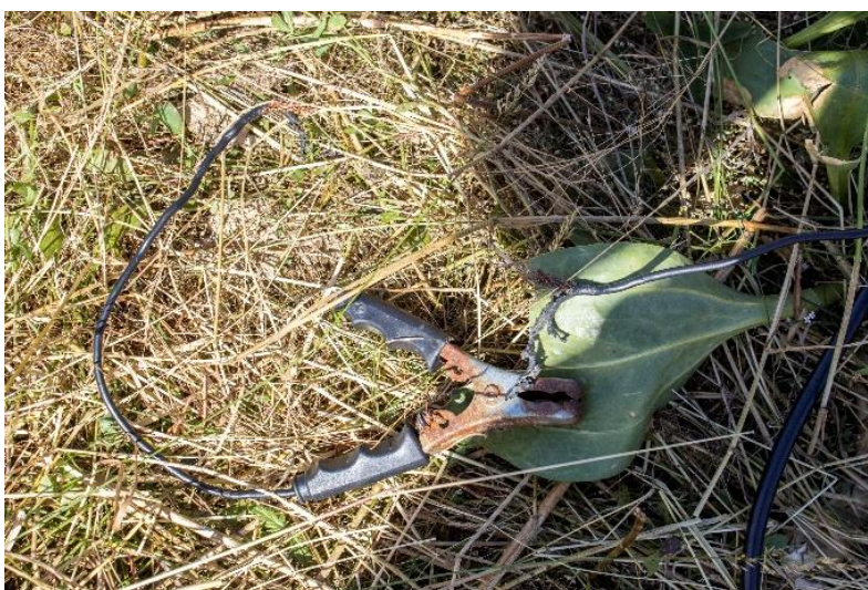
Slika 5: Malomarnost - zaradi pretrganega ozemljitvenega kabla sistem varovanja ne deluje.
