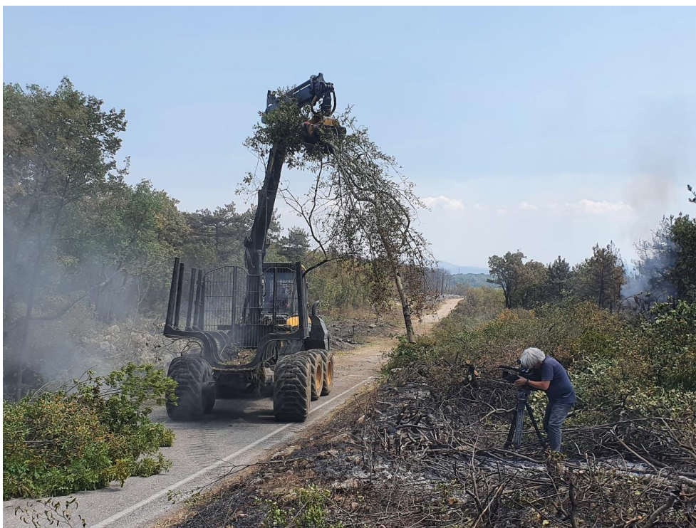
Slika 5: Družba SiDG izvaja sečnjo in spravilo požganega lesa ob glavni cesti Temnica-Renče (foto: A. Poljanec)
