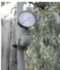
Slika 13: Vsak oroševalni sistem – tudi montažni mora imeti manometer za kontrolo in pravilno nastavljanje tlaka
