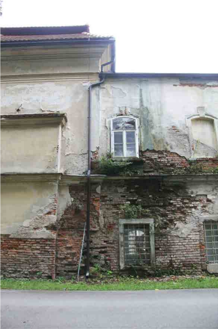
Foto 2 - okno nekdanje zakristije in poškodbe zaradi zamakanja
